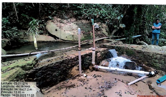
Foto 11: Sistema de cloração.
