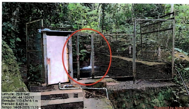
Foto 1: Cerca em volta da captação. Nota-se ausência de parte da cerca.
