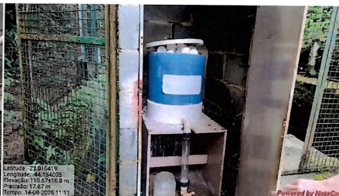
Foto 4: Sistema de cloração.
