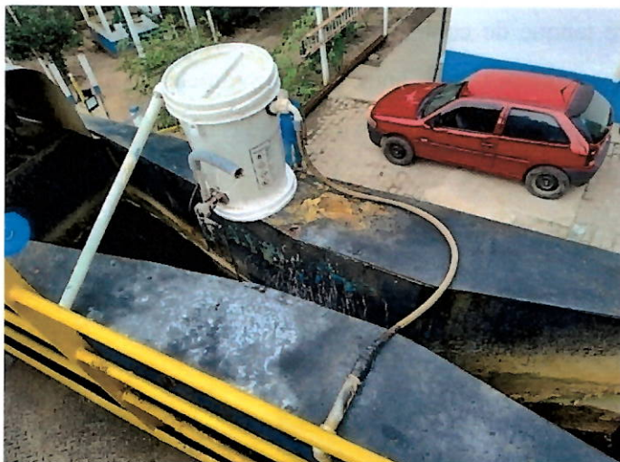
Foto 7: Calha Parshall com aplicação de sulfato de alumínio.
