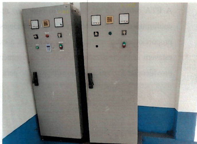
Foto 18: Painéis elétricos dos conjuntos motobombas.
