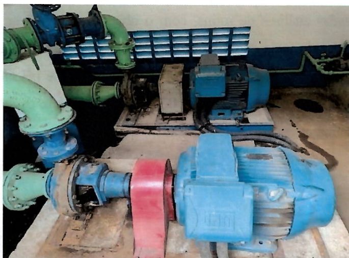
Foto 17: Conjuntos motobombas para adução de água tratada.
