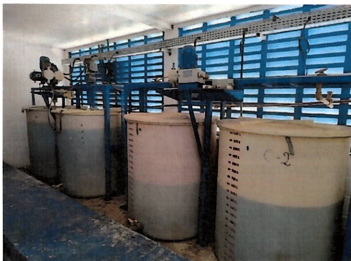
Foto 19: tanques de armazenamento sulfato de alumínio.
