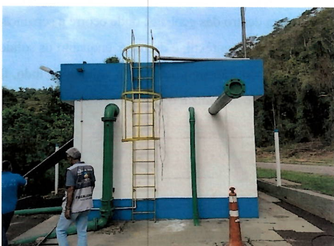
Foto 8: Tanque de contato (100 m³).
