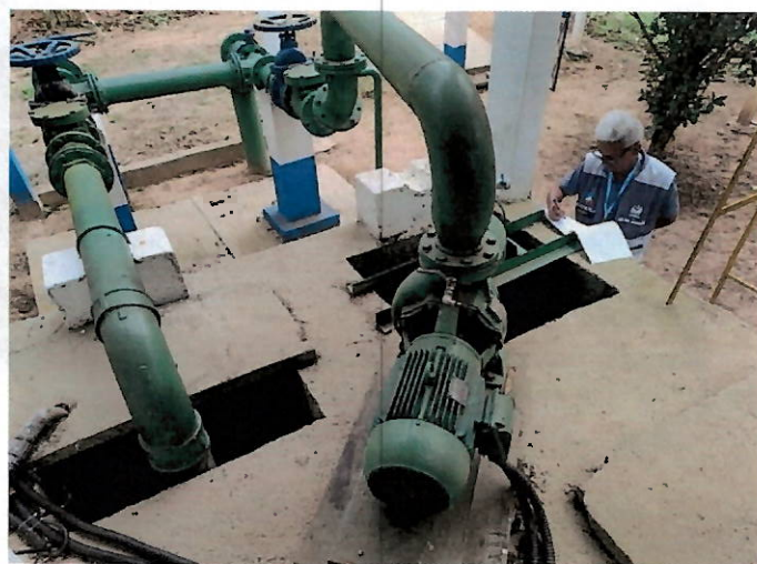
Foto 4: EEAB – Apenas uma bomba operando. Não há bomba reserva.
