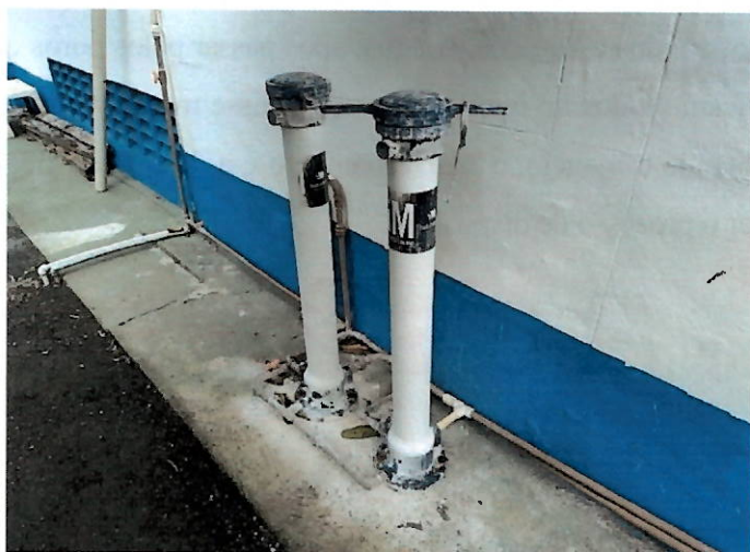
Foto 7: Sistema de cloração (Hipoclorito de Cálcio).
