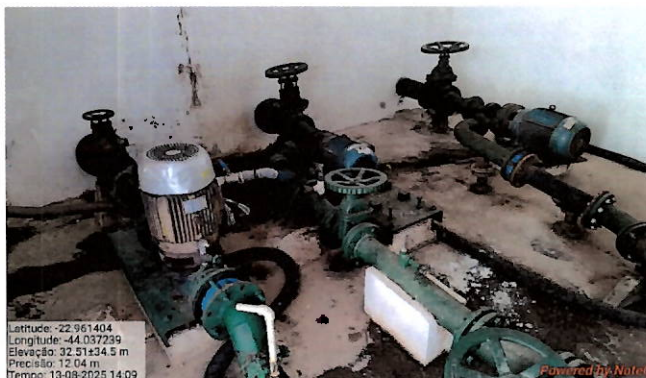
Foto 38: Conjunto motobombas da EEAT de Mangaratiba.
