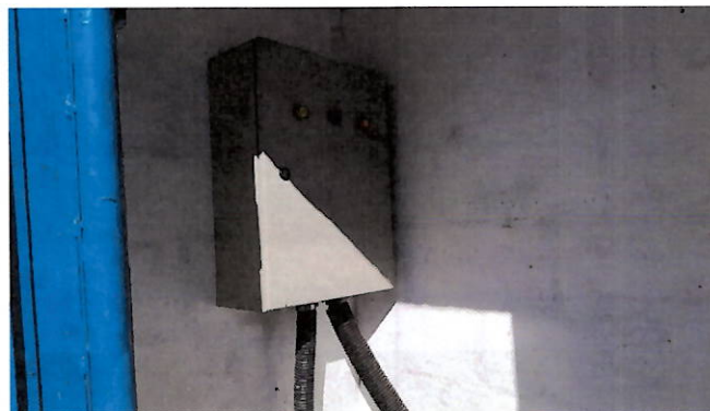
Foto 47: Quadro elétrico do booster.
