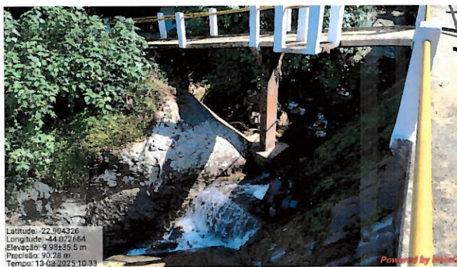
Foto 9: Vazamento de água próximo a tomada de água.
