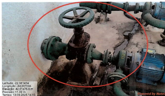
Foto 39: Vazamento de água no conjunto motobomba 2.
