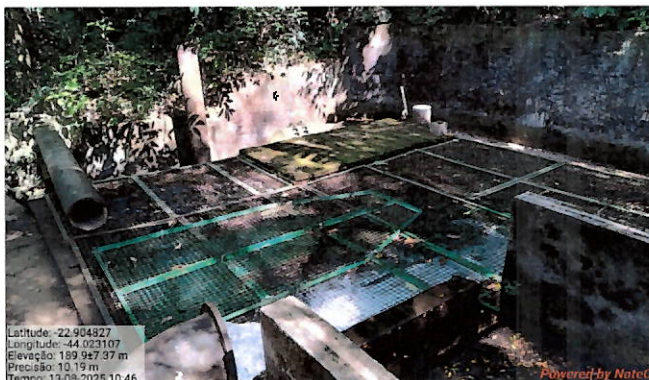
Foto 7: Caixa de areia.
