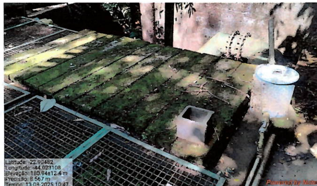
Foto 8: Tampa do tanque de cloração (não oferece estanqueidade para proteção da água clorada).
