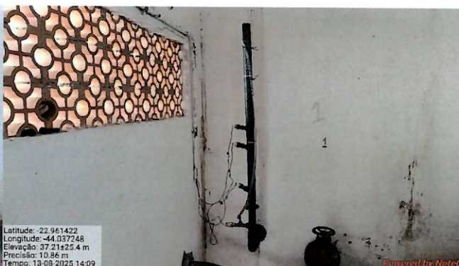
Foto 36: Medidor de nível improvisado do Reservatório R2.
