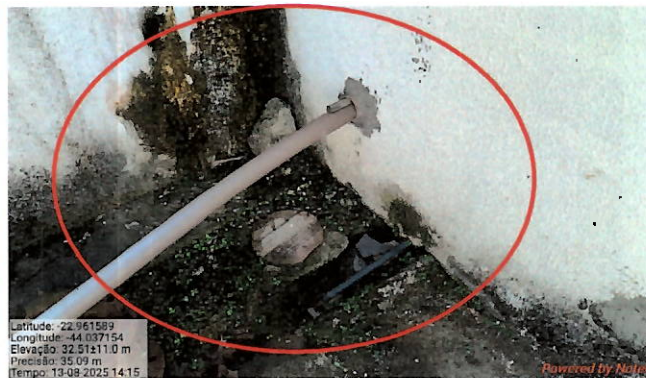
Foto 40: Vazamento de água na parede de reservatório.
