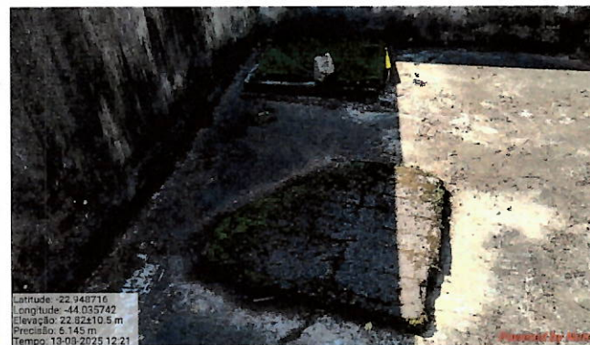
Foto 30: Tampa de inspeção do Reservatório R1 (não oferece estanqueidade para proteção da água clorada).
