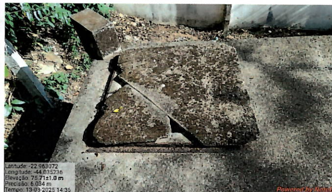
Foto 44: Tampa de inspeção do Reservatório R3 (não oferece estanqueidade para proteção da água clorada).
