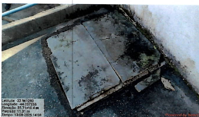
Foto 35: Tampa de inspeção do Reservatório R2 (não oferece estanqueidade para proteção da água clorada).
