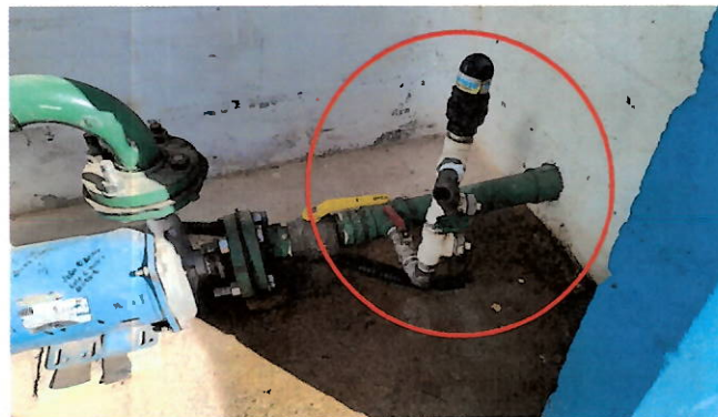
Foto 48: Vazamento de água identificado na ventosa.
