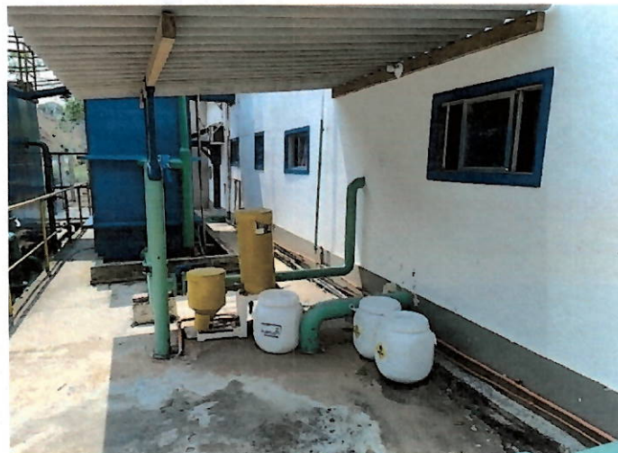
Foto 16: Sistema de cloração com hipoclorito de cálcio.
