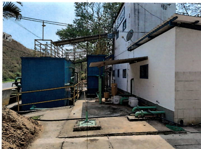
Foto 8: Interior da ETA Morro Azul (ETA Nova, à esquerda, e ETA Velha, à direita).
