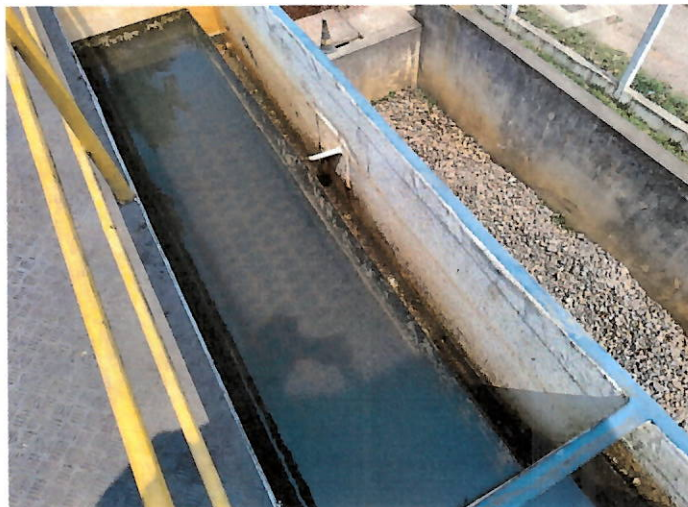
Foto 11: ETA Nova - Decantadores.
