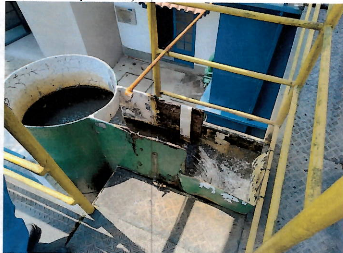
Foto 8: Chegada de água bruta na ETA Nova.
