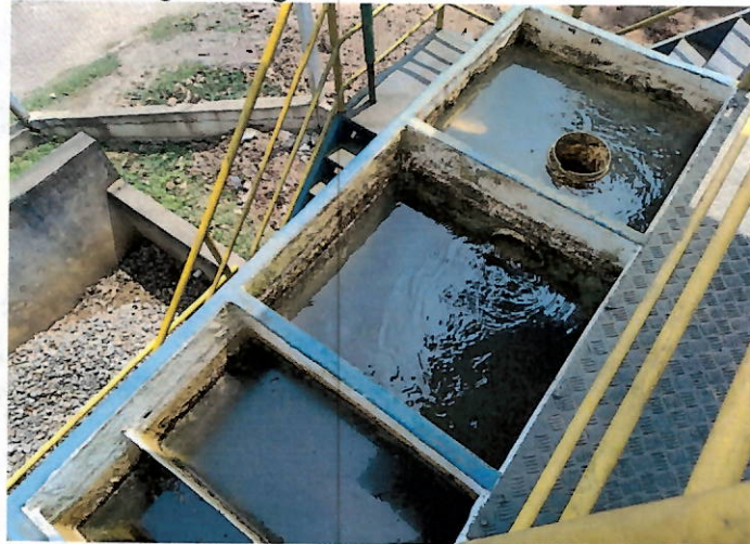
Foto 10: ETA Nova - Floculadores.
