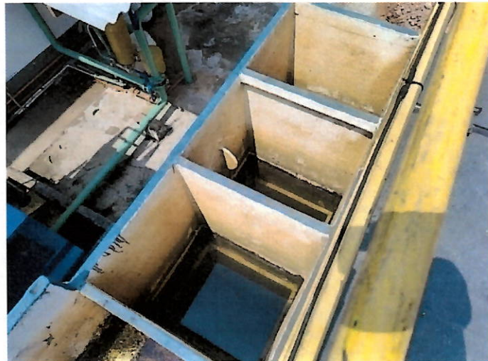
Foto 12: ETA Nova - Filtros.
