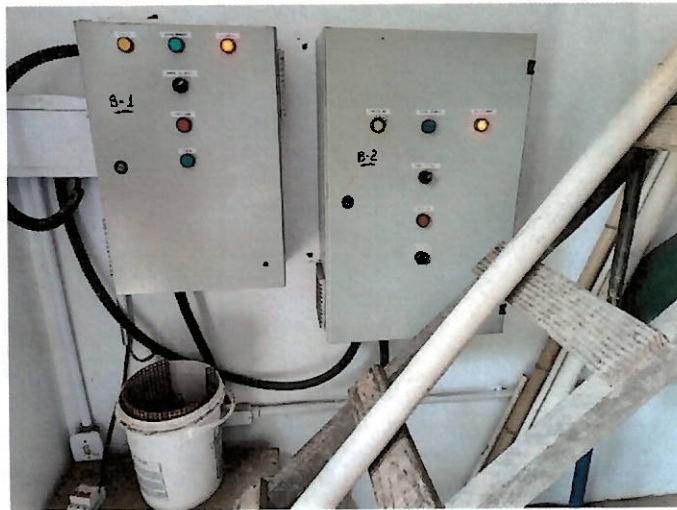
Foto 6: EEAB – Quadro elétrico em boas condições.
