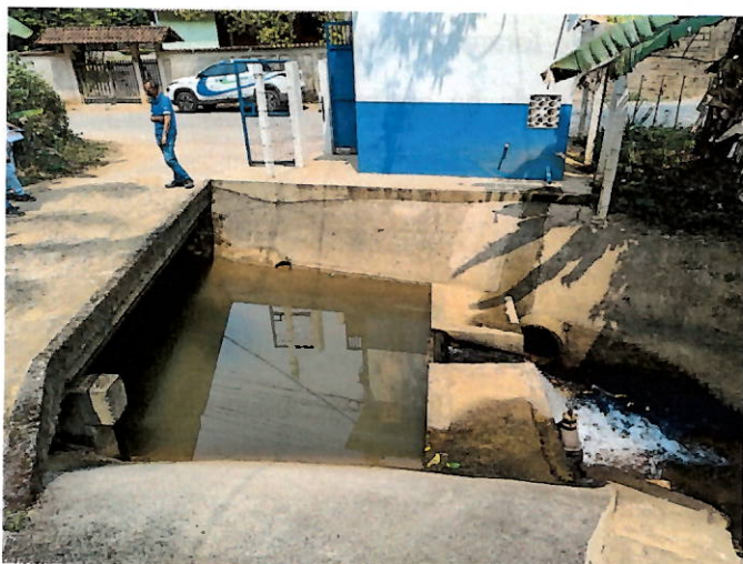
Foto3: Captação Nova – ausência de cercamento e placa de identificação.
