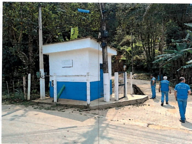
Foto4: Captação Nova – Estação Elevatória de Água Bruta.
