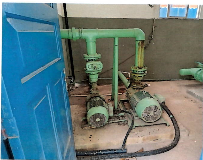
Foto 17: Conjuntos motobombas para adução de água tratada.
