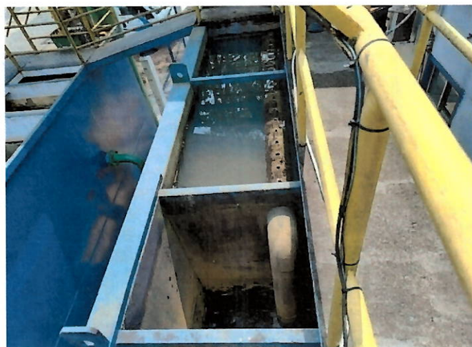
Foto 15: ETA Velha - filtro.
