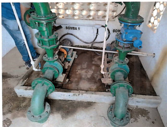
Foto 5: EEAB – duas bombas de 3cv em operação (ausência de bomba reserva).
