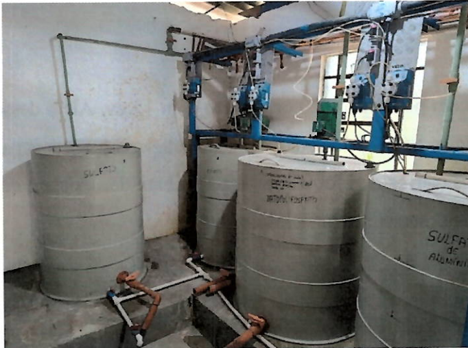
Foto 19: Tanques de armazenamento de produtos químicos sem bacia de contenção.
