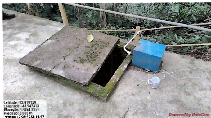
Foto 27: Tampa de inspeção do Reservatório (não oferece estanqueidade para proteção da água clorada).
