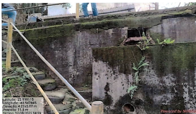
Foto 25 :Estrutura do reservatório necessitando de reforma.
