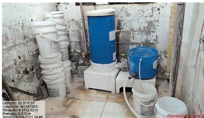
Foto 15: Sistema de desinfecção.
