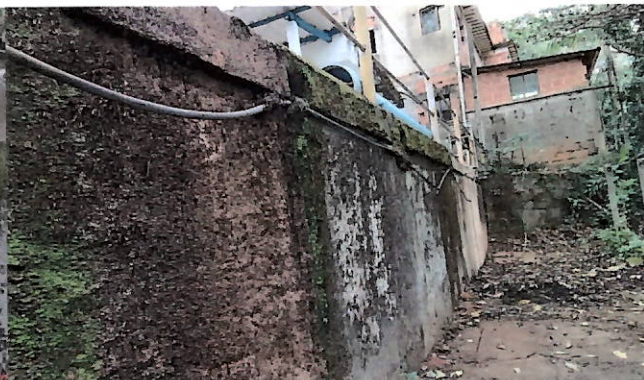
Foto 26: Estrutura do reservatório necessitando de reforma.
