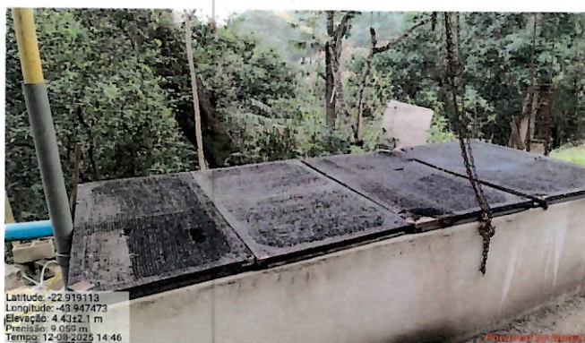
Foto 13: Caixa de areia.
