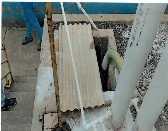
Figura 14- Ponto de aplicação de cloro.
