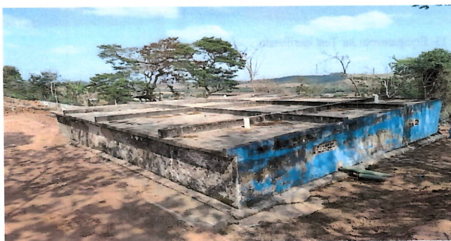
Figura 16- Reservatório capacidade 700 m³
