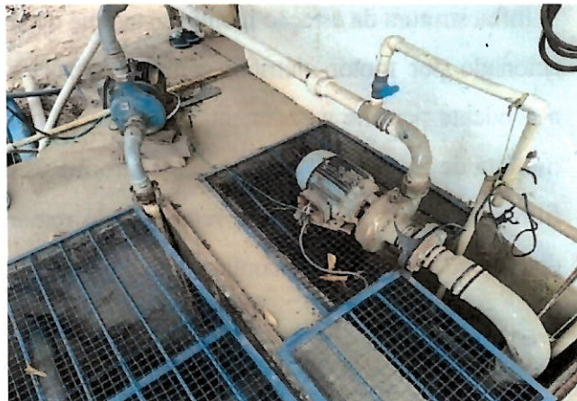
Figura 3- Cojunta motobomba de potência 7.5 cv cada (poço tubular).
