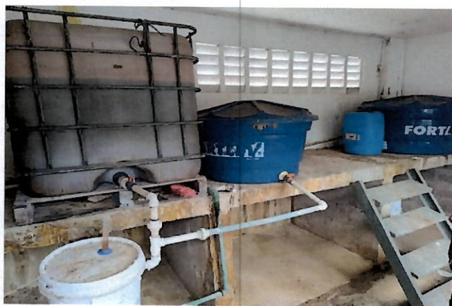
Figura 11- Armazenagem do agente coagulante (Sulfato de Alumínio).
