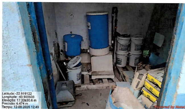
Foto 28: Sistema de desinfecção. Armazenamento inadequado de hipoclorito junto a diversos outros materiais.
