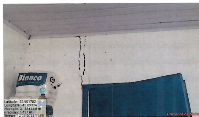
Foto 9: Posto de operação com várias rachaduras e trincas nas paredes do imóvel. Há necessidade de reforma e recuperação do imóvel. Não atende a NR 24.
