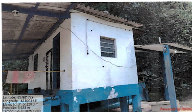
Foto 7: Posto de Operação. Há necessidade de reforma e recuperação do imóvel. Não atende a NR 24.
