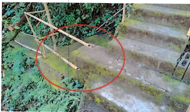
Foto 3: Guarda-corpo necessitando de manutenção.
