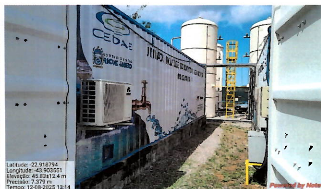
Foto 30: Módulos de Ultrafiltração.
