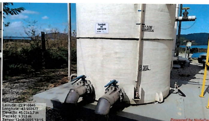
Foto 34: Tanque de contato, capacidade de 35.000 litros.
