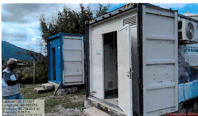
Foto 29: Módulos de Ultrafiltração.
