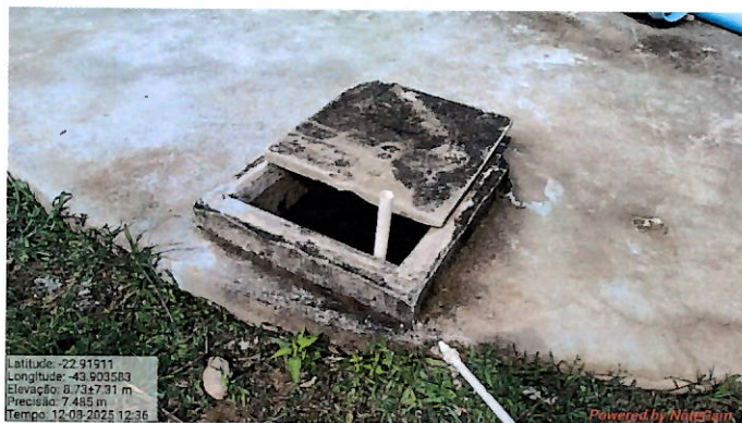
Foto 26: Tampa de inspeção do reservatório (não oferece estanqueidade para proteção da água clorada) e medidor de nível inadequado.
