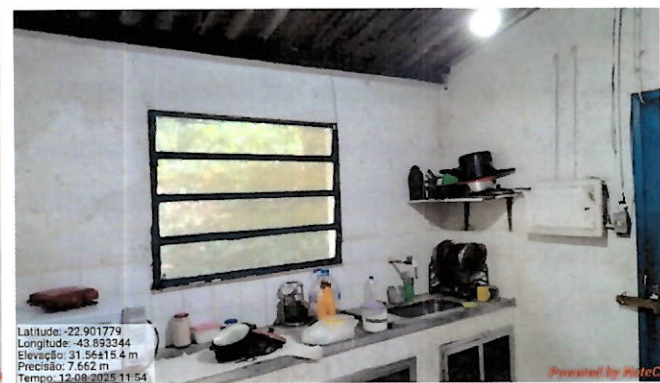
Foto 10: Posto de operação com várias rachaduras e trincas nas paredes do imóvel. Há necessidade de reforma e recuperação do imóvel. Não atende a NR 24.
