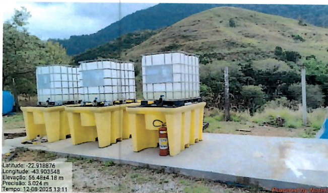
Foto 35: Armazenamento de produtos químicos sobre bacia de contenção.
