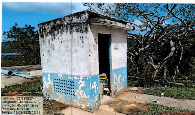
Foto 27: Edificação de abrigo do sistema de desinfecção e armazenamento de hipoclorito de cálcio.
