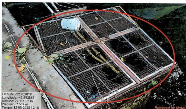
Foto 4: Grades deterioradas necessitando de manutenção.
