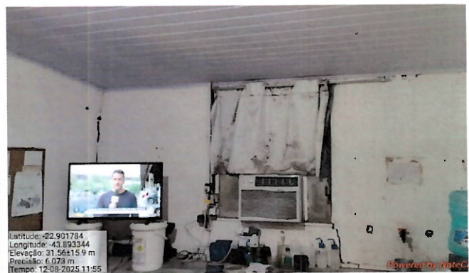
Foto 8: Posto de operação com várias rachaduras e trincas nas paredes do imóvel. Há necessidade de reforma e recuperação do imóvel. Não atende a NR 24.
