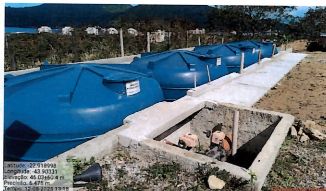
Foto 36: Armazenamento de resíduos em tanques sobre bacia de contenção.
