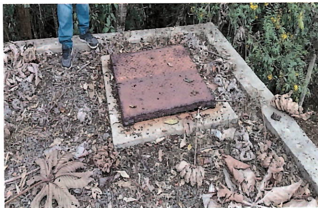
Figura 20- Tampa de inspeção do Reservatório (não oferece estanqueidade para proteção da água clorada).
