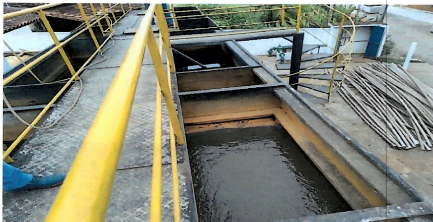
Figura 7- Floculador hidráulico de chicanas verticais de placas de aço.
