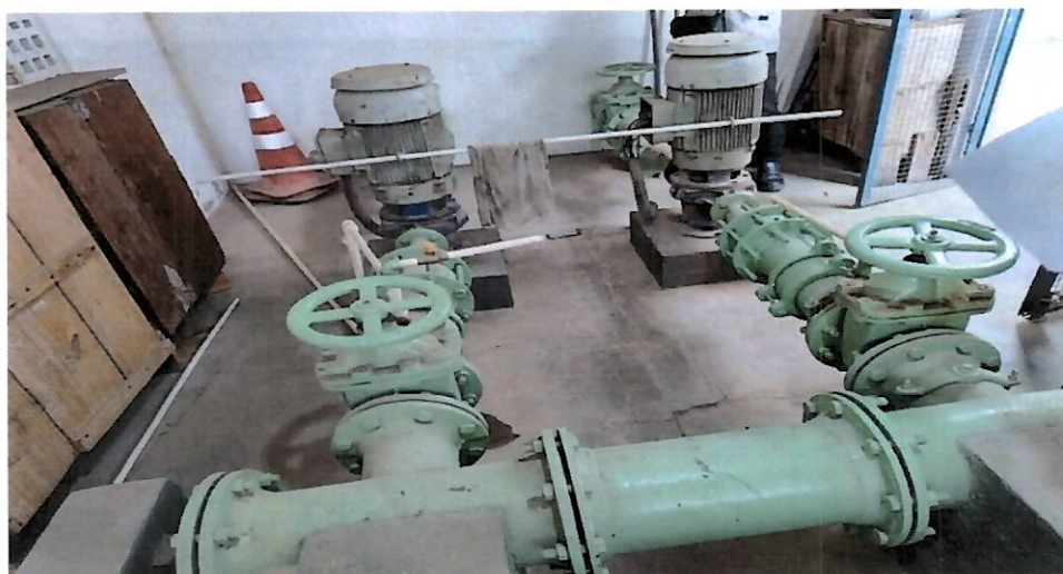
Figura 11- Conjunto motobomba 15 cv cada.
