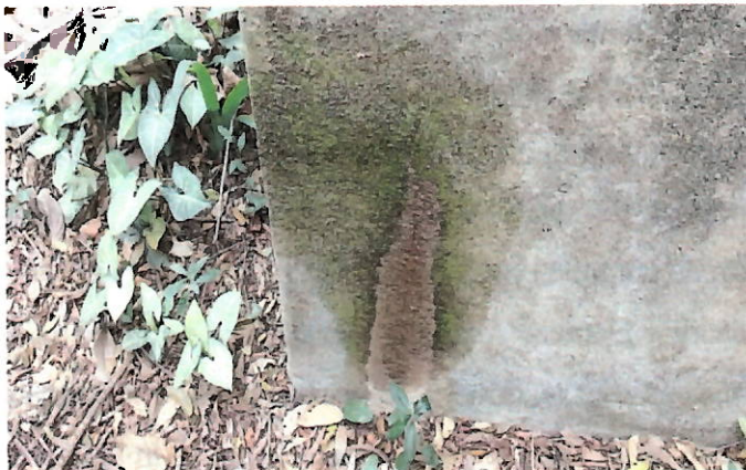
Figura 19- Sinais de vazamento no Reservatório.
