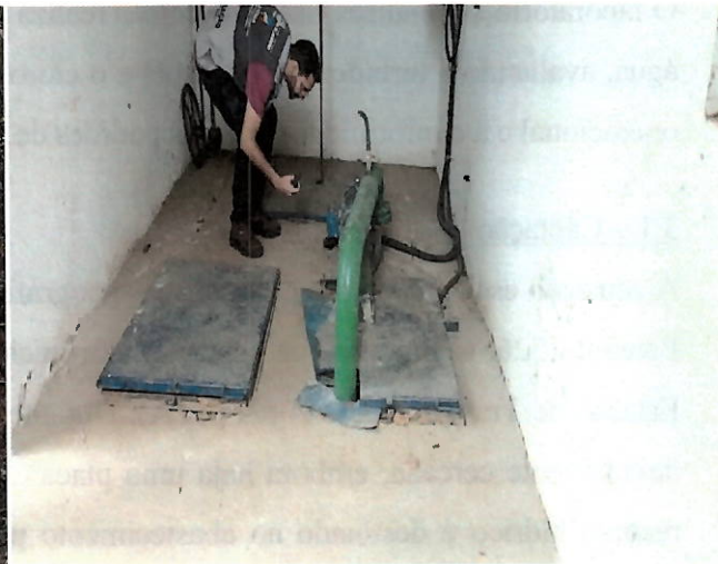
Foto 3- EEAB – Apenas uma bomba operando. Não há bomba reserva.
