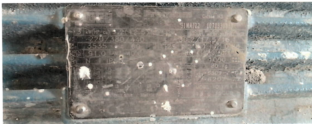
Figura 4 – Placa de especificações do conjunto motobomba.
