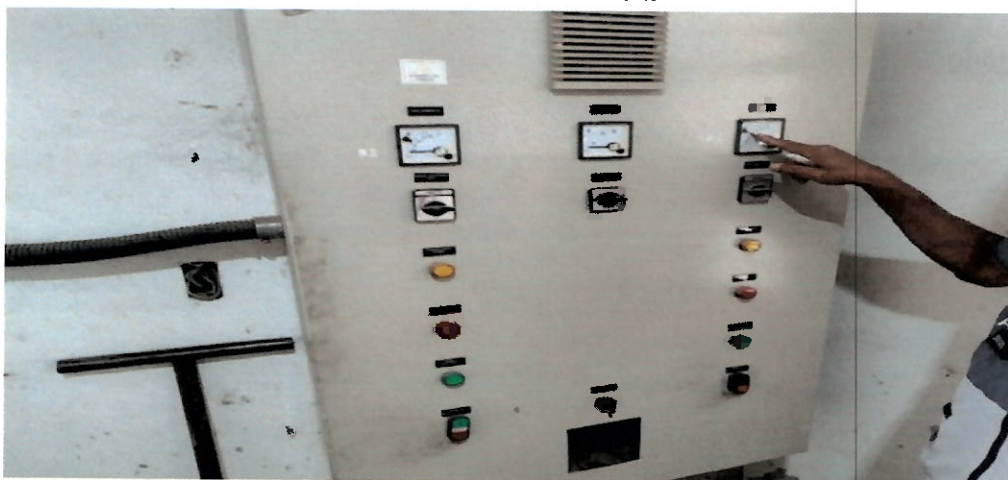
Figura 12- Vista externa do painel elétrico da bomba.
