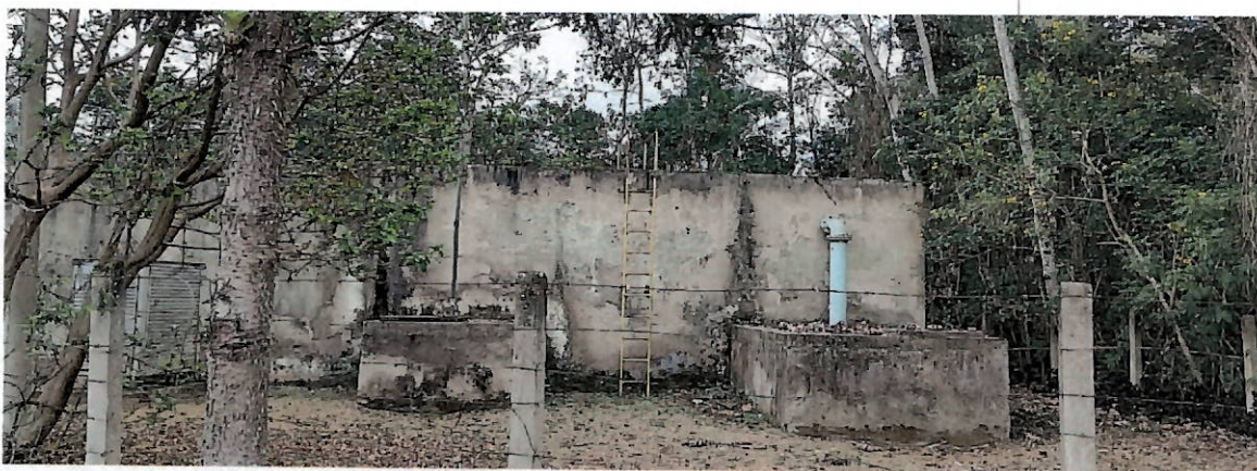
Figura 17 – Reservatório de água tratada com capacidade de 500m 3 .
