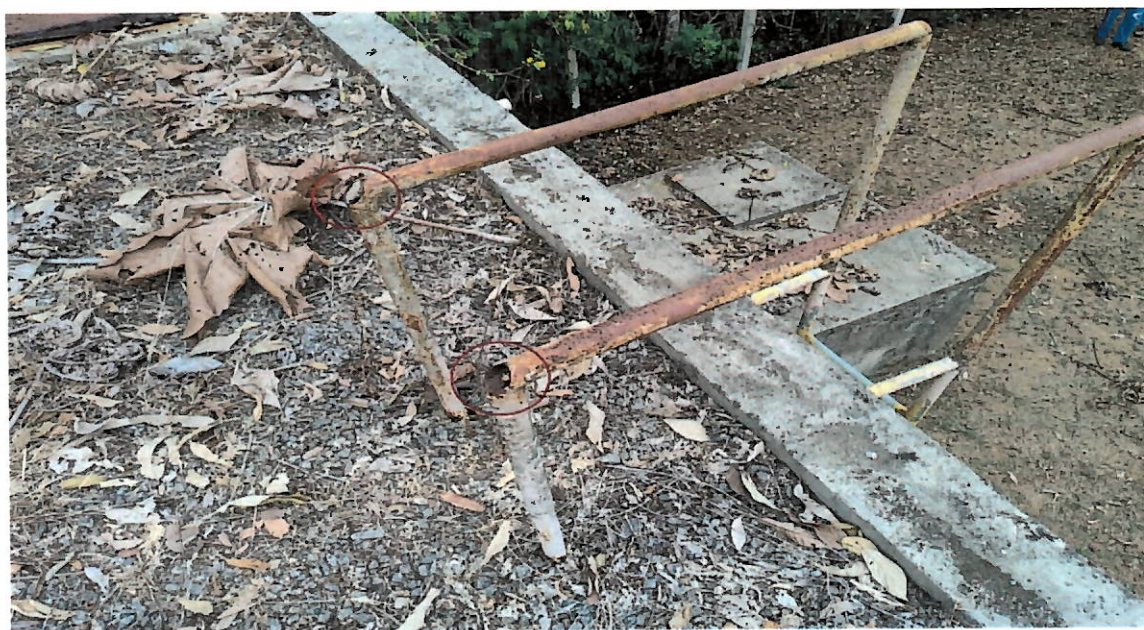
Figura 21- Sinais de corrosão nas estruturas de acesso.
