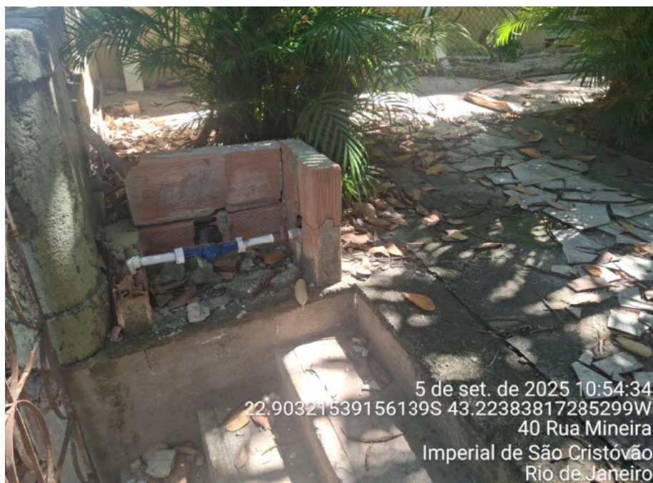
Foto 8. Hidrômetro da casa
