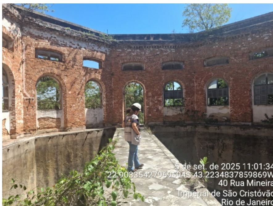
Foto 12. Cobertura do Reservatório inexistente e árvore crescendo entre as trincas da Unidade
