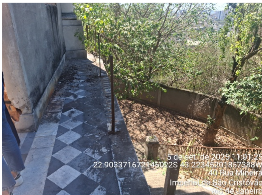
Foto 10. Entorno do Reservatório sem guarda-corpo e peças de mármore do chão deterioradas
