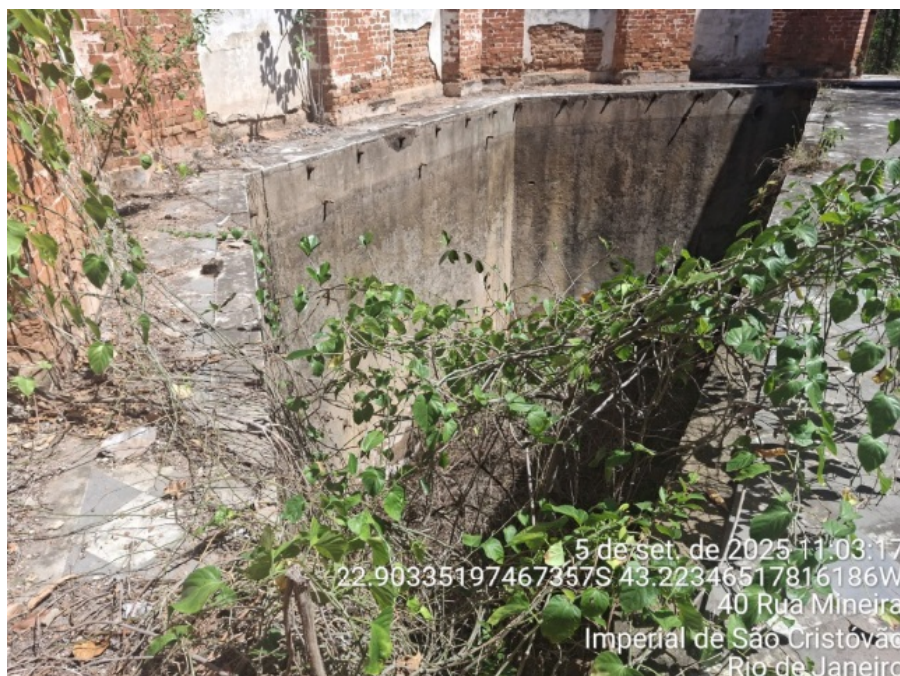
Foto 11. Reservatório tomado por vegetação e com revestimento degradado
