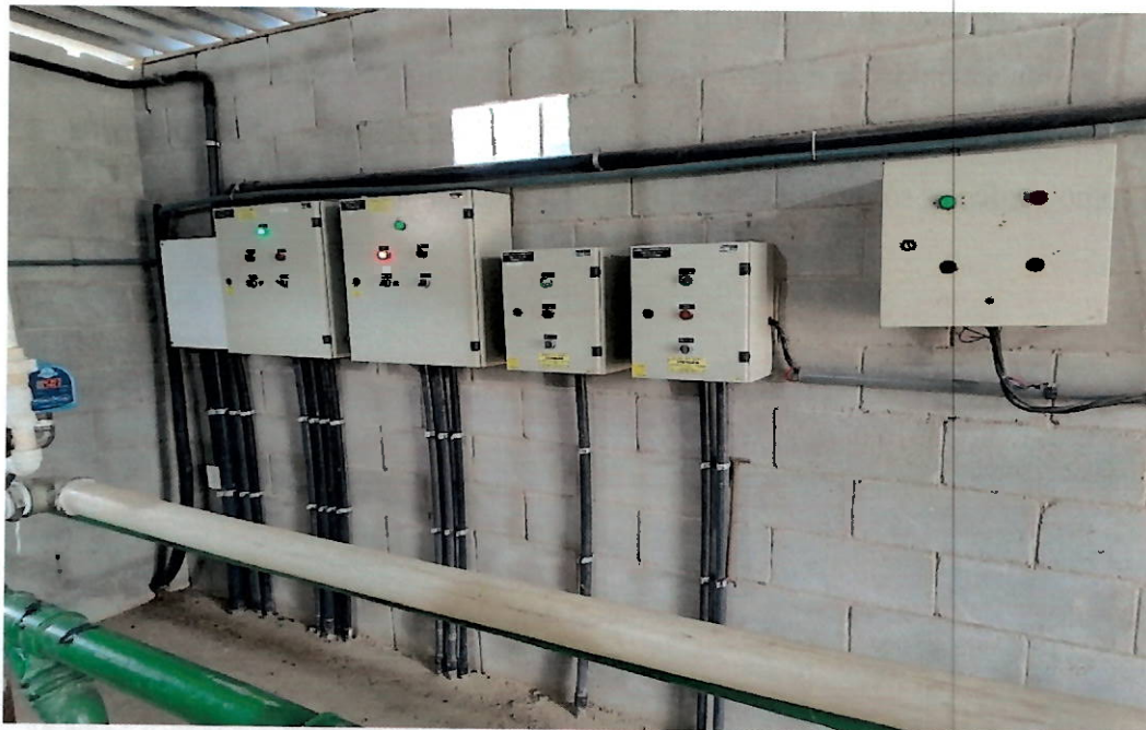
Figura 9- Vista externa do painel elétrico do conjunto motobomba.
