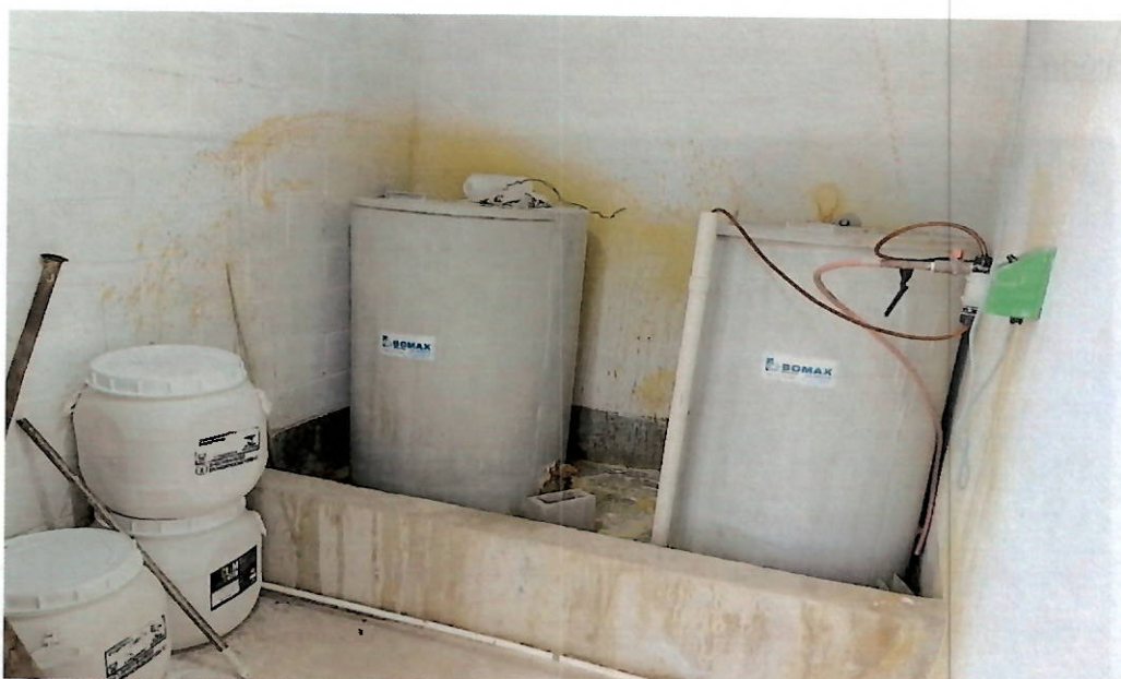
Figura 13- Tanques de armazenagem do agente coagulante (Sulfato de Alumínio).
