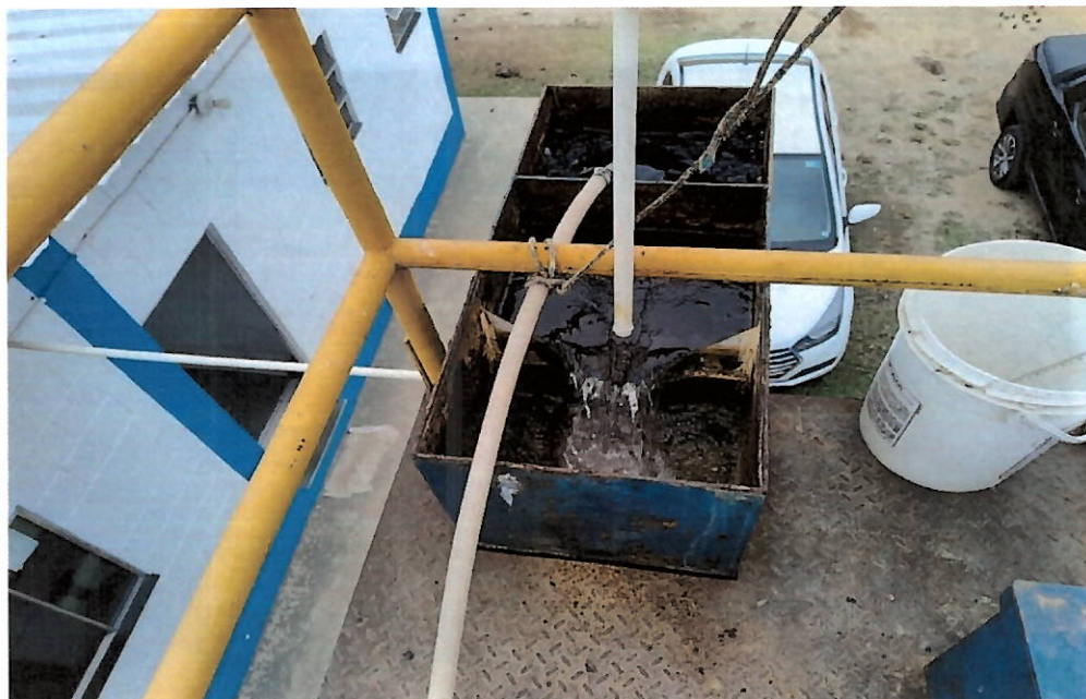
Figura 4- Calha Parshall, ausência de medidor de vazão.
