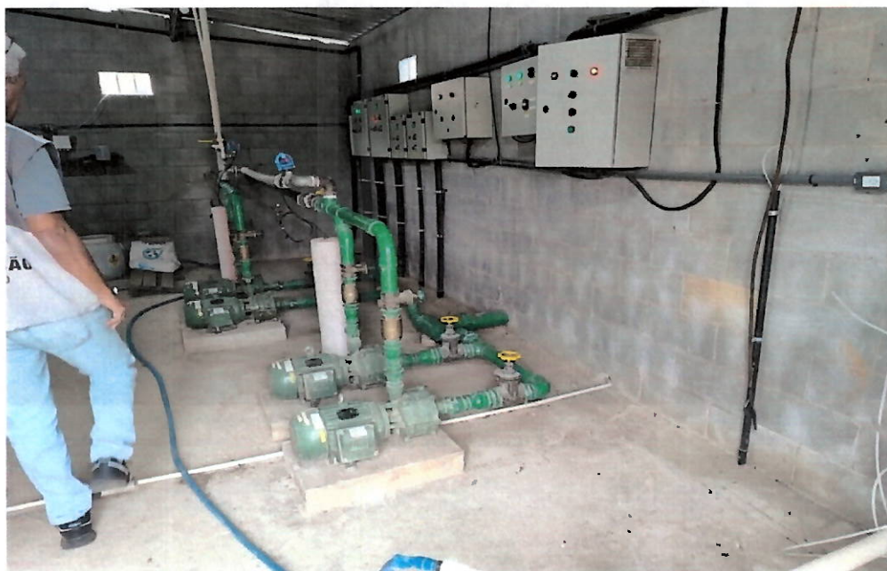
Figura 8 – Conjunto motobomba de potência 6.0 CV.
