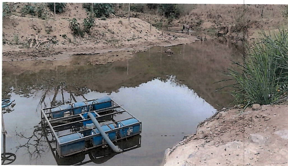
Figura 1- Ponto de captação.
