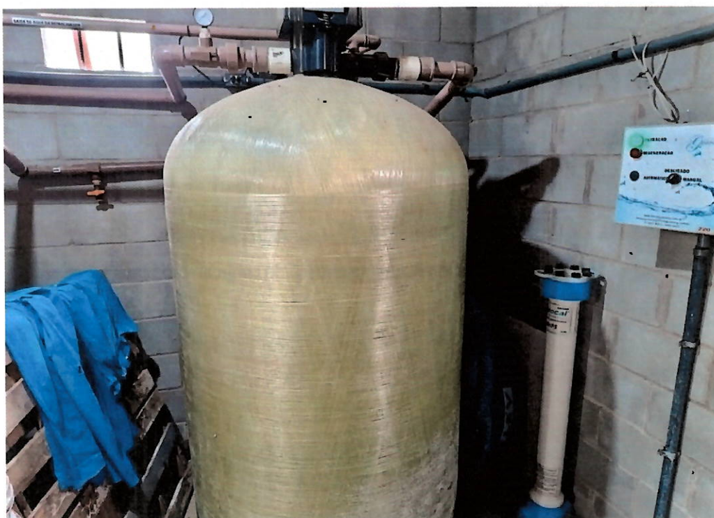
Figura 11- Filtro de oxidação catalítica.
