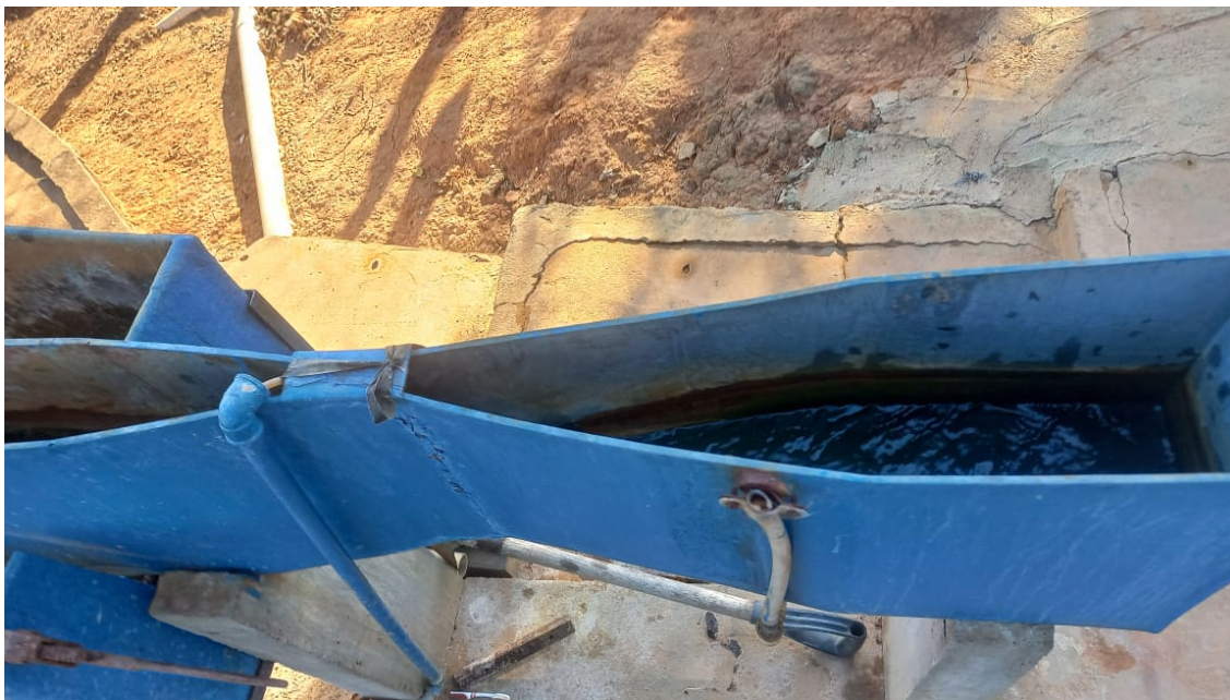
Foto 04 - entrada do tratamento com calha Parshall
