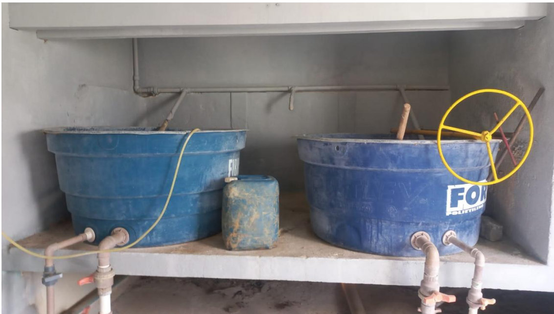
Foto 07 - recipientes sem bacia de contenção
