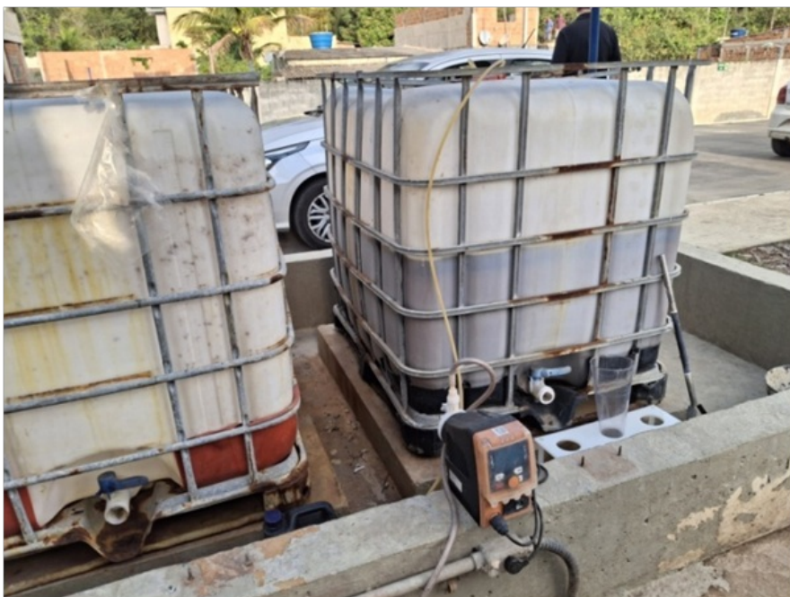
Foto 16 – Depósito de polímero para tratamento do lodo com dosador eletrônico.
