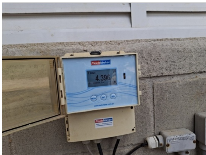
Foto 15 – Medidor de vazão de esgoto tratado ( 4,396 l/s )
