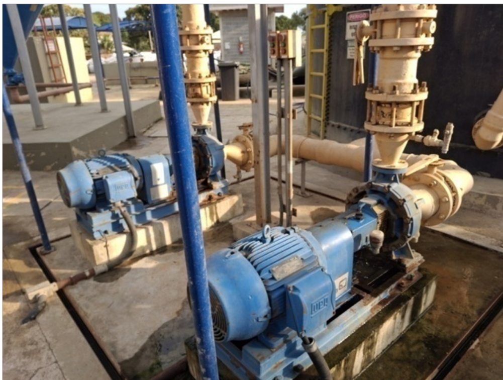
Foto 8 – Elevatória de recirculação do esgoto
