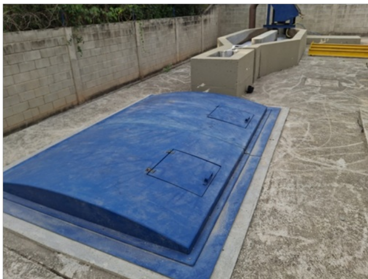
Foto 7 – Caixa de Gordura
