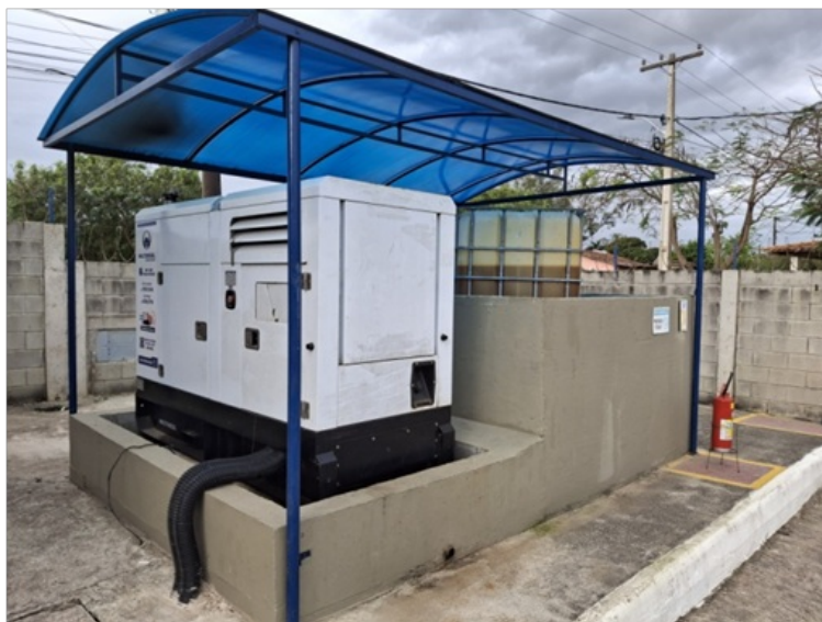
Foto 2 – Gerador para segurança operacional, com baia de contenção e depósito de óleo diesel
