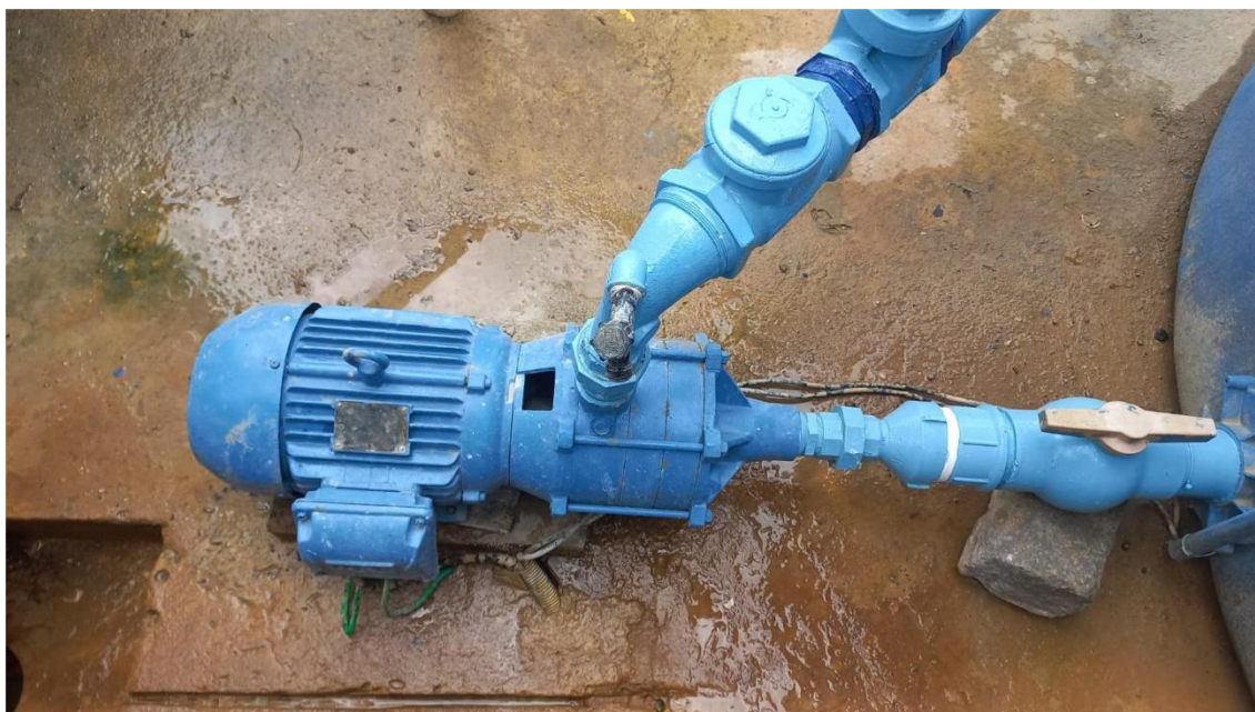
Foto 04 - bomba de recalque
