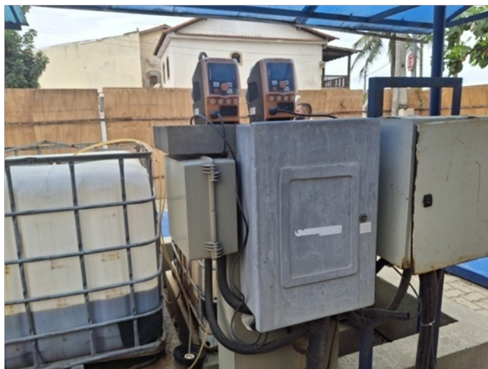
Foto 9 – Dosadores de polímero para tratamento do lodo
