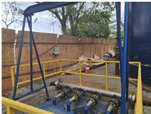
Foto 5, 6 e 7 – Caixa de Gordura, Desarenador e EEEB.
