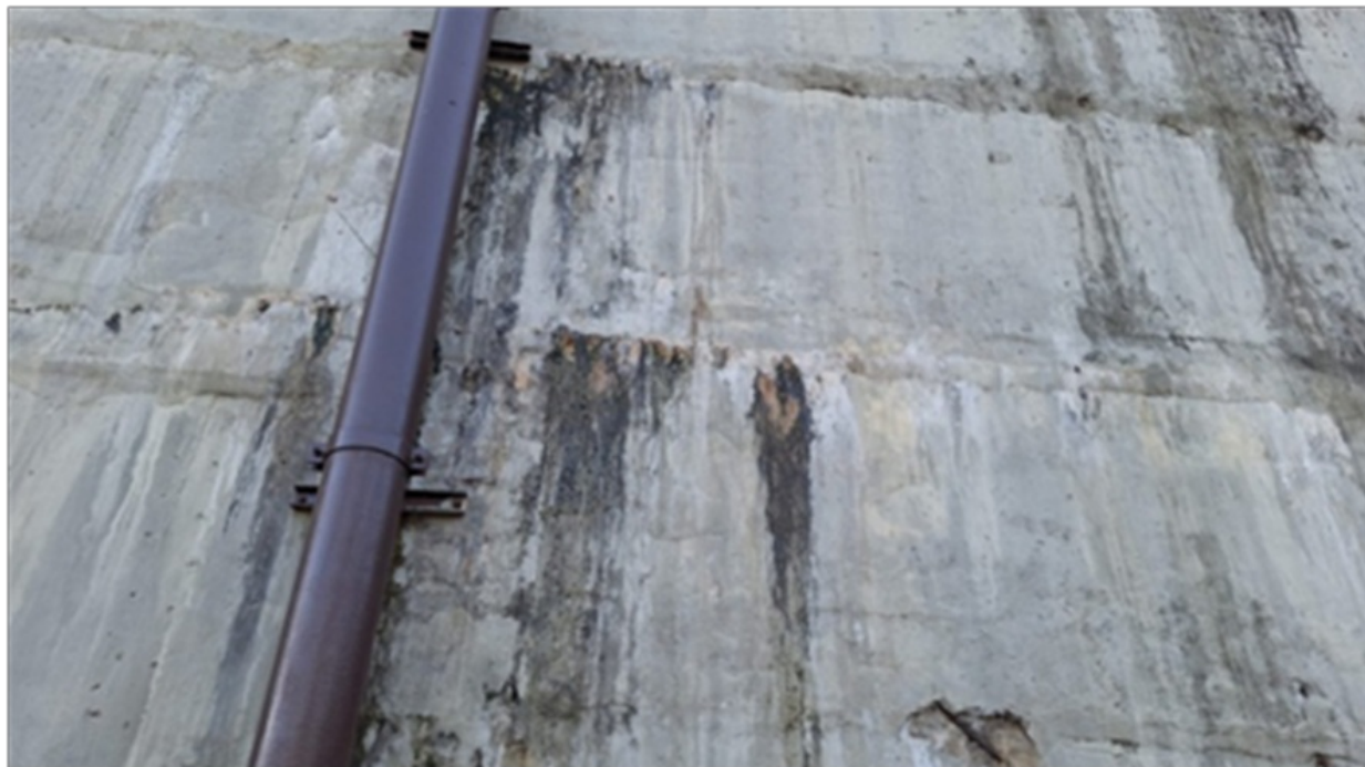
Foto 02 – Vazamentos na estrutura
