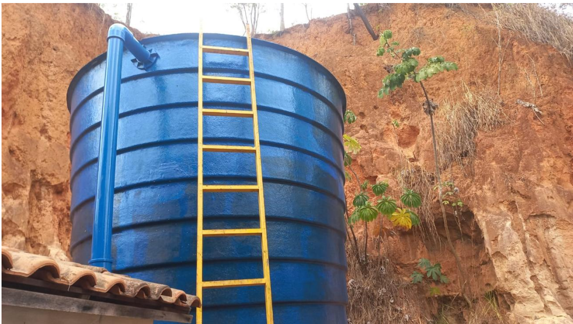
Foto 02 - tanque que recebe água bruta; aplicação de coagulante
