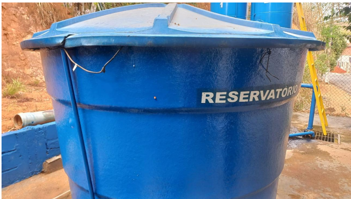
Foto 04 - reservatório de água tratada
