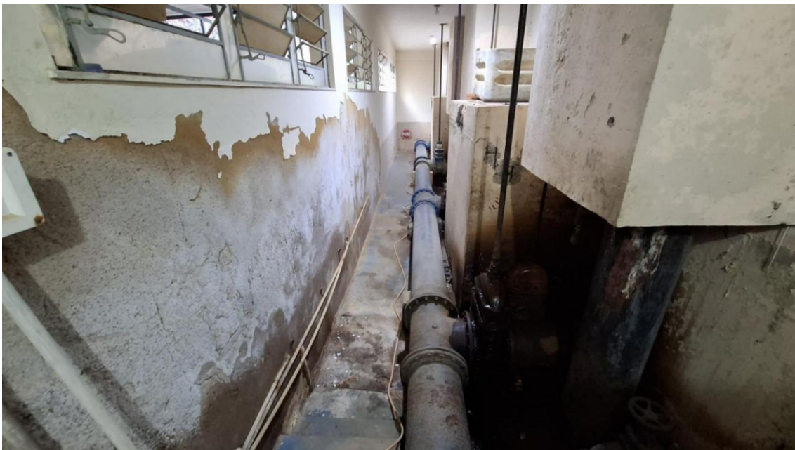
Foto 08 - galeria de filtros
