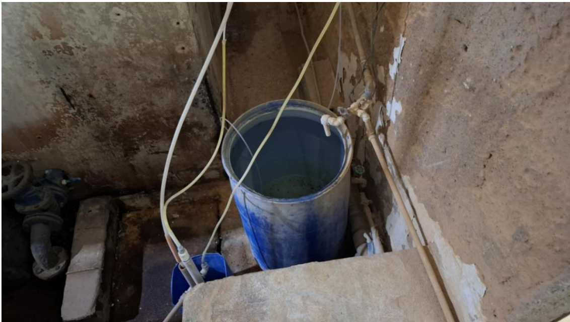
Foto 15 - tanque de fluoreto sem baia de contenção
