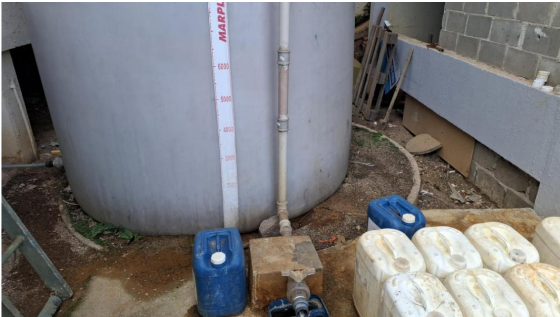
Foto 13 - tanque de sulfato diretamente no solo
