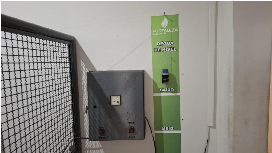
Foto 02 - régua de nível para controle de vazão na entrada
