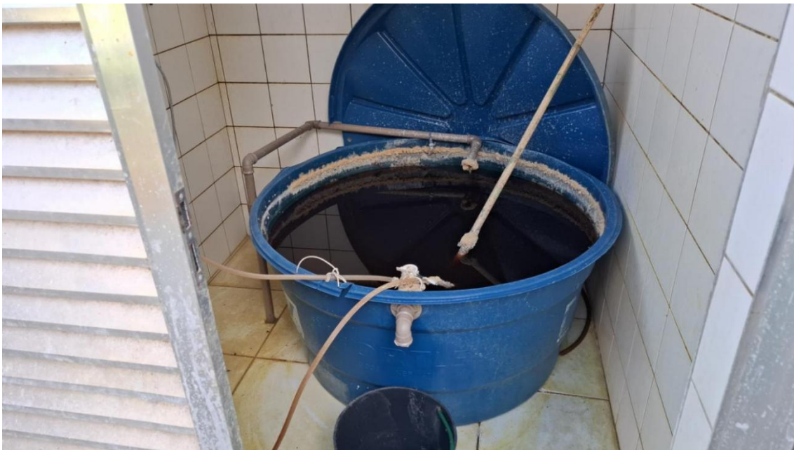
Foto 12 - recipiente de sulfato de alumínio sem baia de contenção
