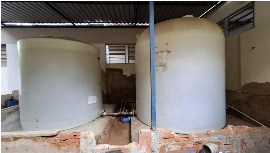
Foto 14 - tanques de hipoclorito; contenção existente, mas carece de manutenção
