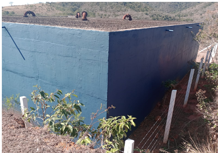
Foto 5 – Dutos de ventilação
