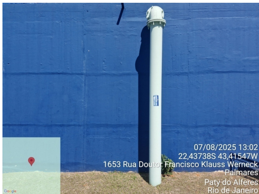
Foto 7 – Tubulação de recalque
