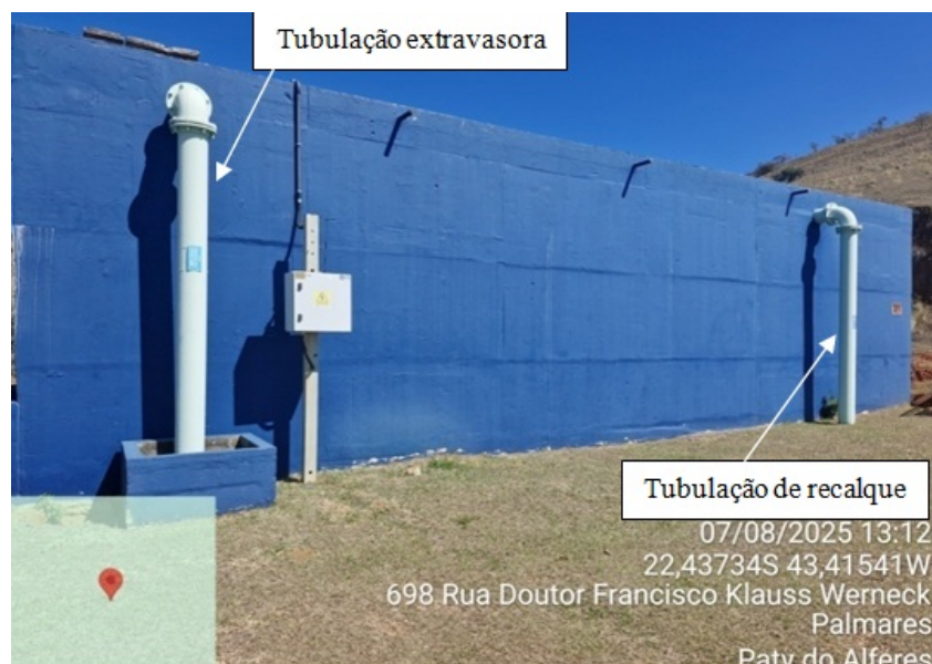
Foto 6 – Tubulações de recalque e extravasora
