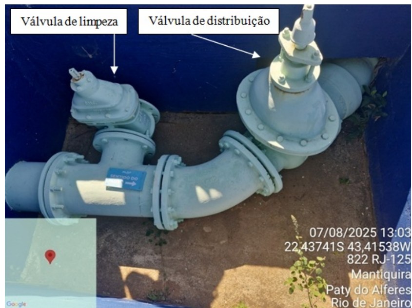
Foto 9 – Conjunto hidráulico de distribuição e descarga
