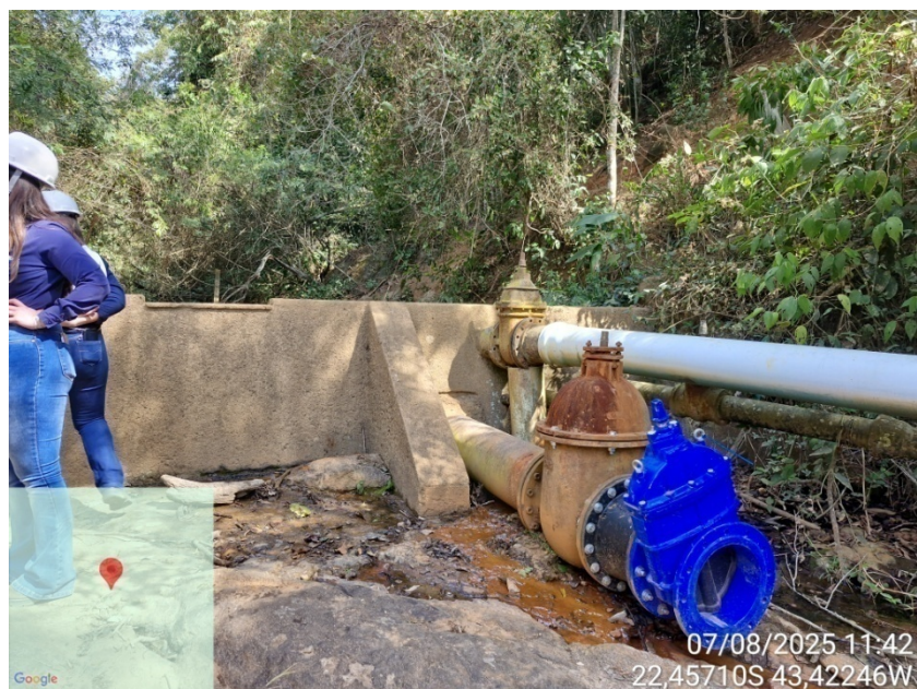
Foto 15 – Tubulação de limpeza (descarga) com válvula
