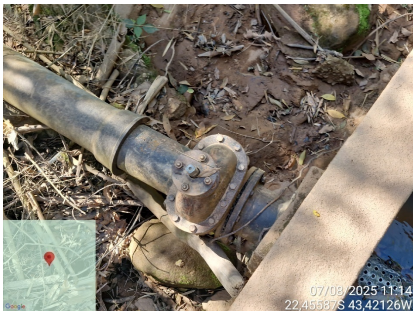
Foto 14 – Tubulação de adução
