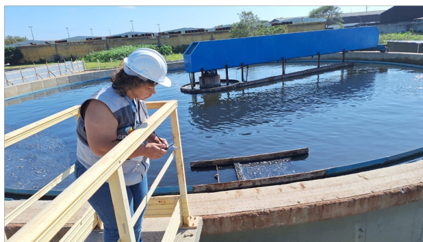
Foto 11 – Um dos dois decantadores, com partes metálicas necessitando de manutenção.
