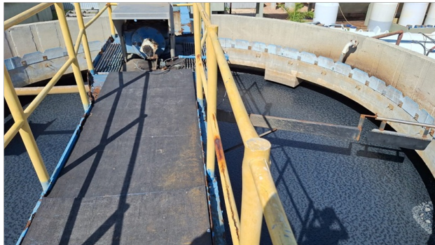
Foto 13 – Adensador de lodo.
