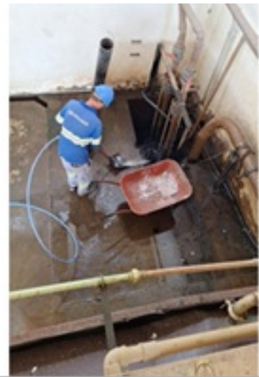
Foto 18 – Centrifuga, que estava em operação apesar do pouco volume de lodo gerado pelo tratamento físico-químico primário desta estação.
