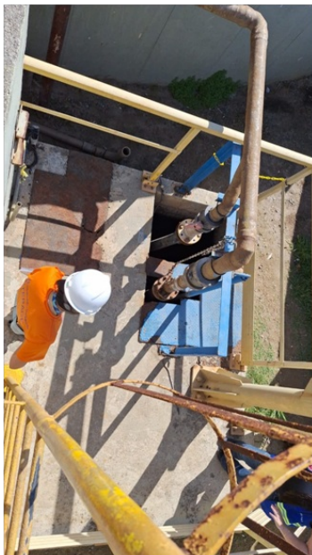
Fotos 12 - EEE de lodo sedimentado, com recalque para o adensador de lodo
