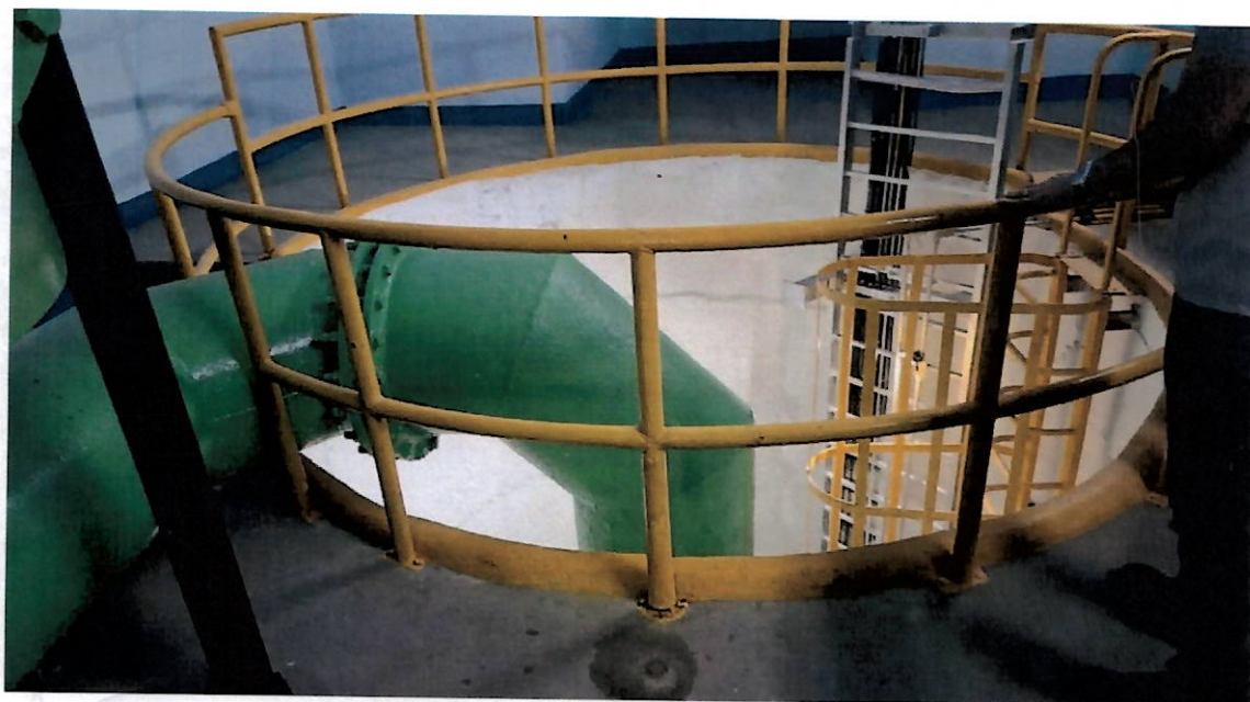
Foto 04 - Tubulação de esgotamento emergencial.
