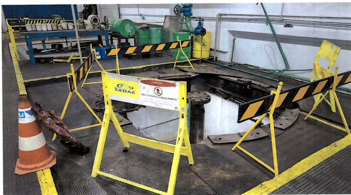
Foto 10 - Grupo 02, motor em manutenção.
