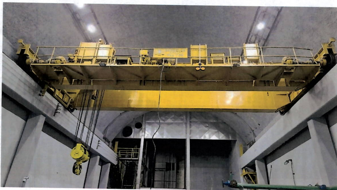
Foto 12 – Ponte rolante na galeria de bombas.
