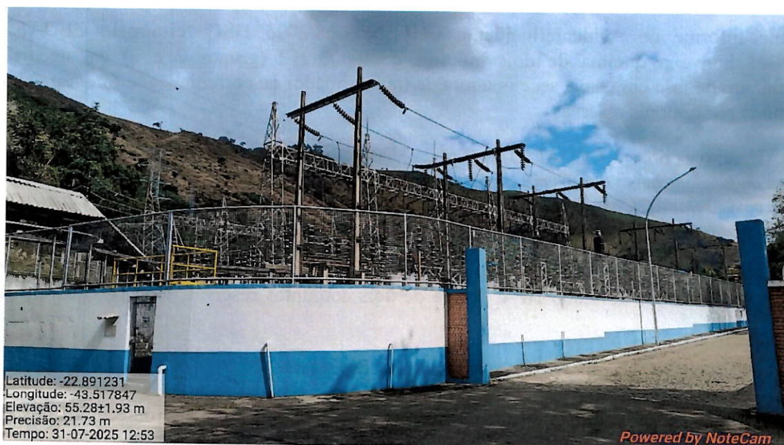
Foto 19 - Subestação de energia.
