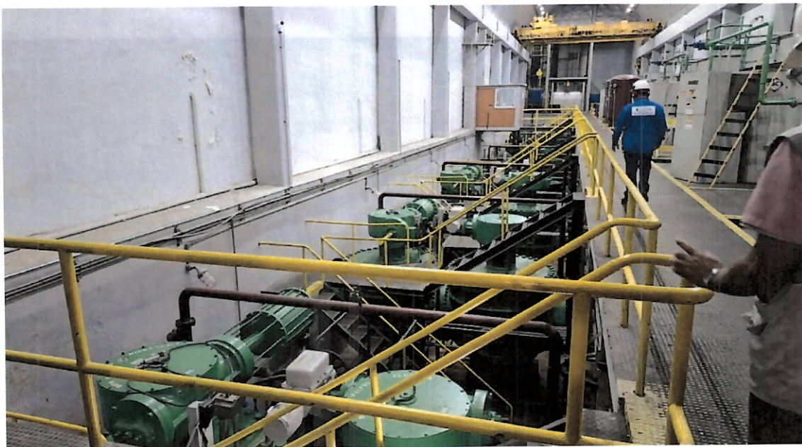
Foto 05 - Galeria de válvulas.
