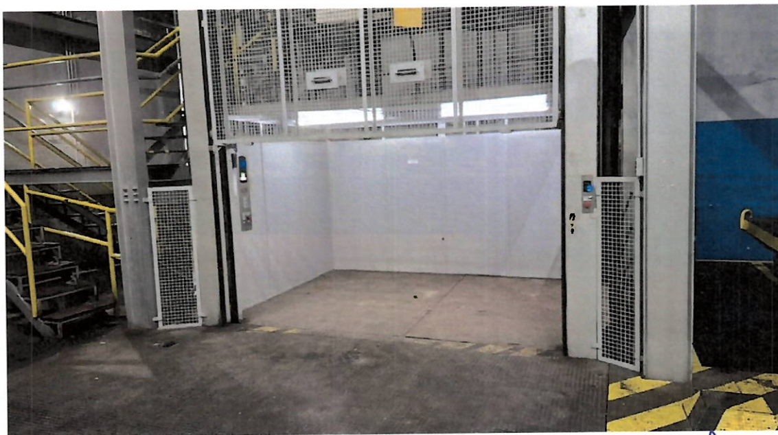
Foto 14 - Elevador transporte de máquinas e equipamentos.
