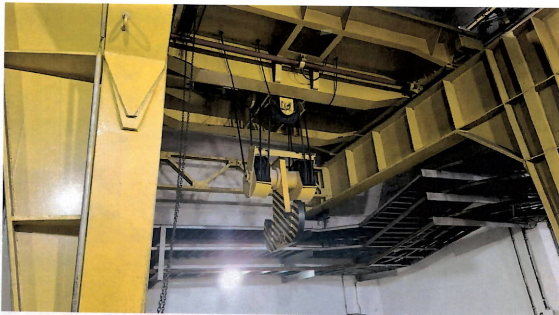
Foto 15 – Ponte rolante para içamento dos equipamentos.
