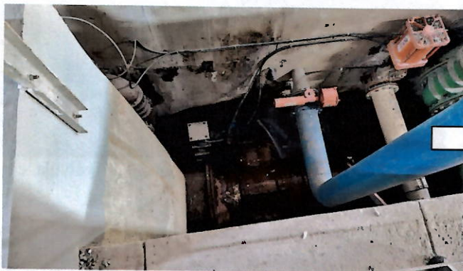
Foto 93: Galeria D – válvula com vazamento.
