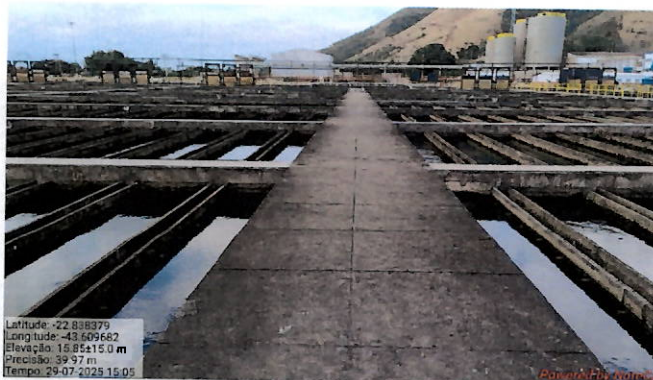
Foto 83: ausência de guarda-corpos.
