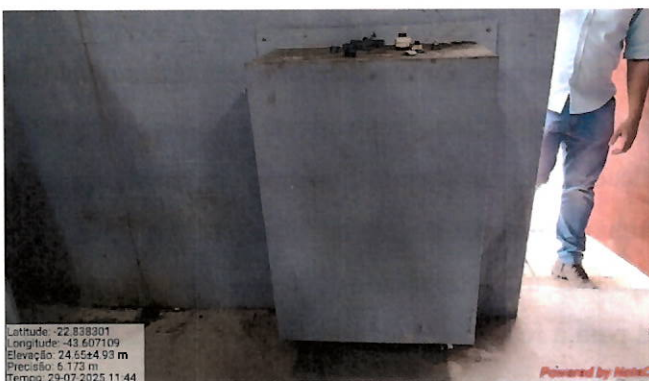
Foto 131: parte interna do exaustor.
