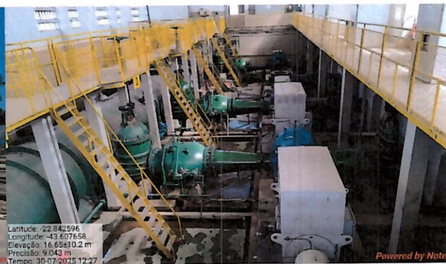
Foto 147: interior da elevatória ARG.
