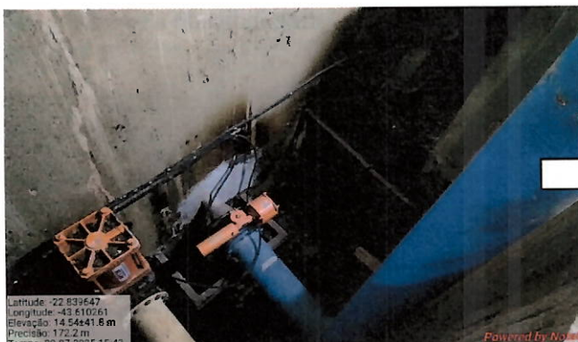
Foto 107: Galeria A – válvula com vazamento.
