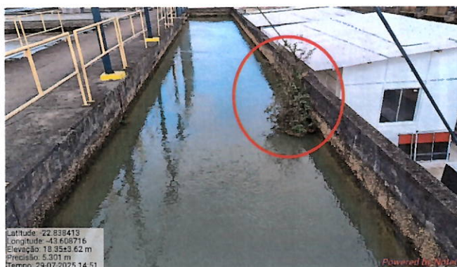
Foto 79: Parede do canal de água floculada com crescimento de vegetação.
