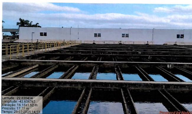
Foto 81: decantadores da NETA.
