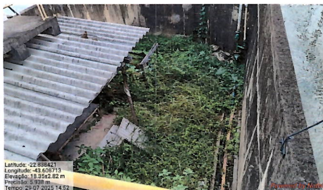
Foto 80: área entre floculação e decantação necessitando de limpeza constante.
