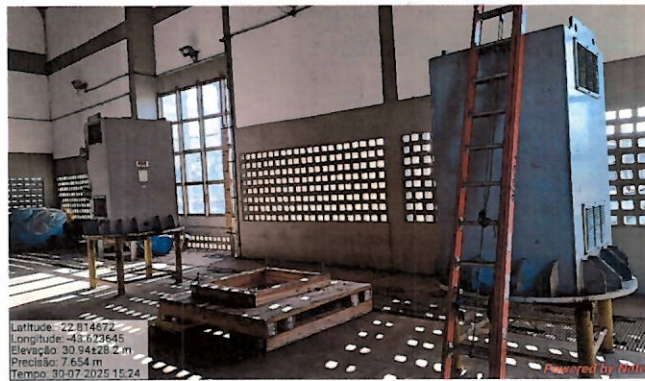
Foto 40: motores em reserva fria.
