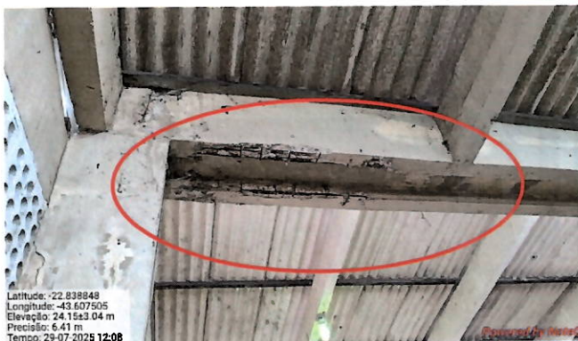
Foto 113: vigas danificadas da estrutura do telhado da Casa de Química.
