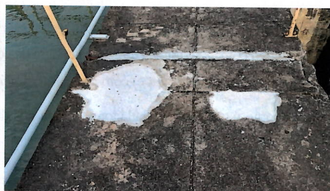
Foto 78: Reparo realizado apontado em vistoria anterior.
