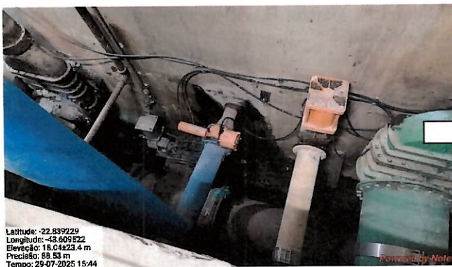
Foto 109: Galeria A – parede do filtro com vazamento.
