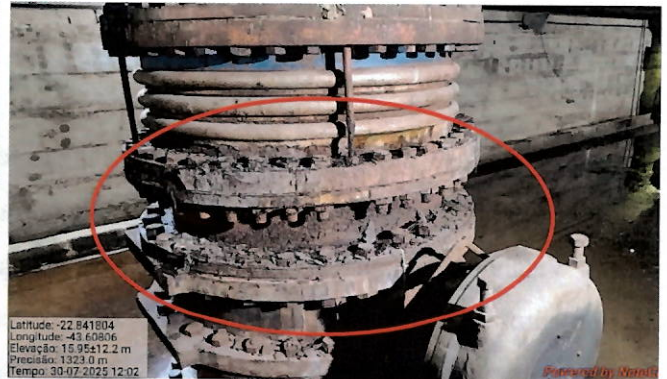
Foto 153: parafusos da válvula com sinais avançados de corrosão.
