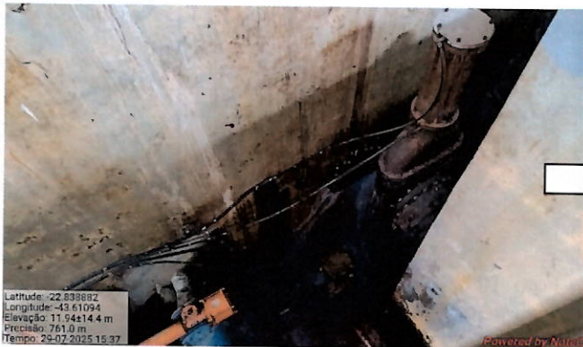
Foto 103: Galeria B – válvula com vazamento.
