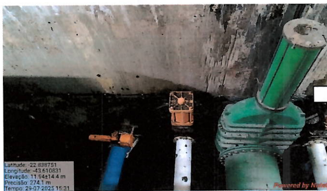
Foto 101: Galeria C – válvula com vazamento.
