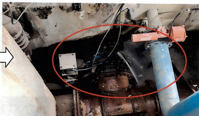
Foto 94: Galeria D – foto ampliada de válvula com vazamento.
