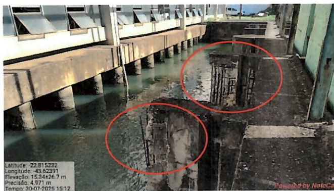
Foto 23: concreto deteriorado com ferragem exposta.
