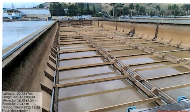
Foto 60: decantador 7 fora de operação devido obra do floculador 7. Pode-se observar as 3 linhas de raspadores instalados.
