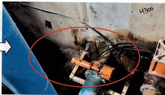
Foto 96: Galeria D – foto ampliada de parede do filtro com vazamento.
