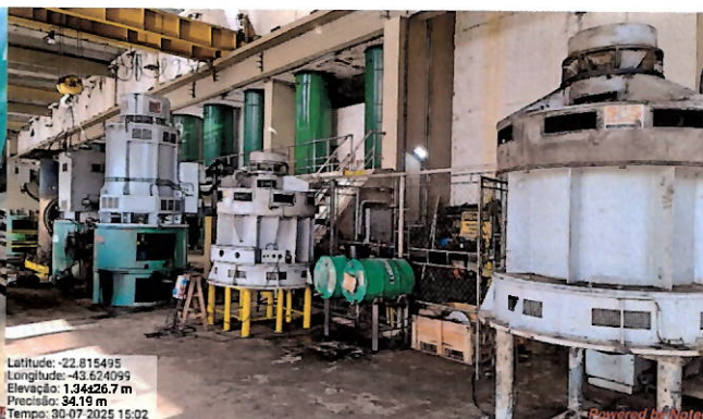
Foto 34: motores em reserva fria.
