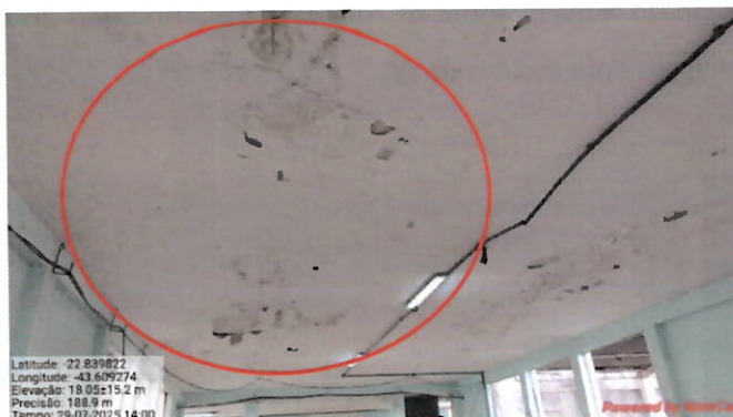
Foto 67: Teto das galerias com infiltrações (também passarão por reformas).
