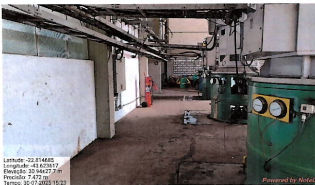
Foto 39: conjuntos motobombas do NBRG.
