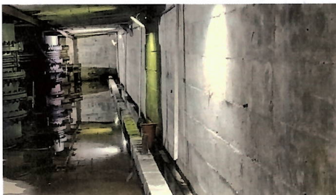
Foto 156: vazamento de água proveniente da parede do poço de sucção.
