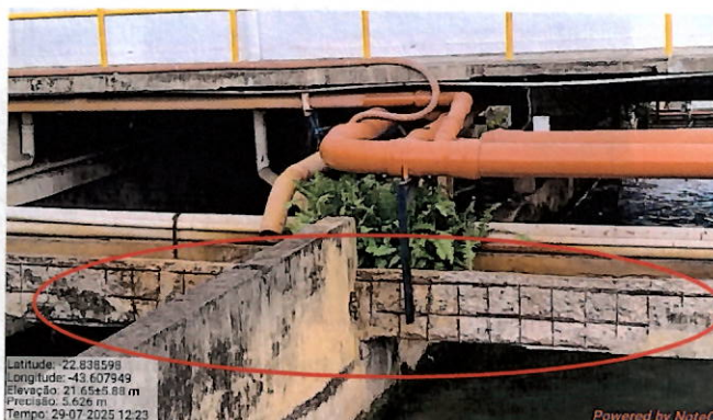
Foto 50: concreto deteriorado e ferragens expostas na saída da caixa de tranquilização.
