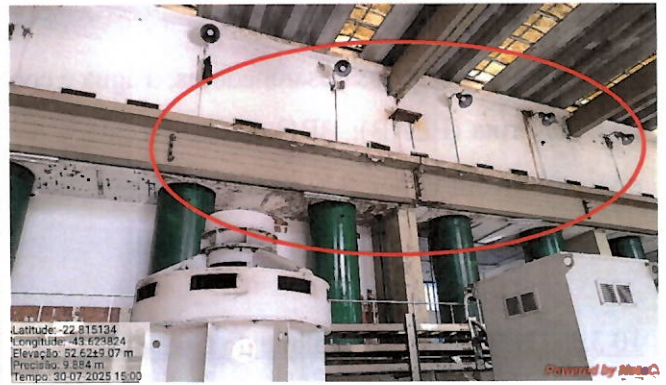
Foto 28: teto com sinais de vazamento, concreto deteriorado e ferragens expostas.
