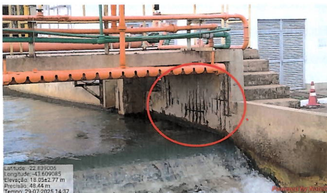
Foto 71: Revestimento de concreto danificado do vertedouro da NETA com armadura exposta.
