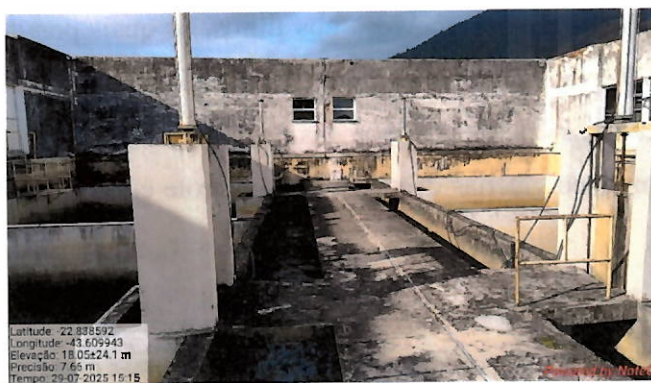
Foto 89: ausência de guarda-corpos.
