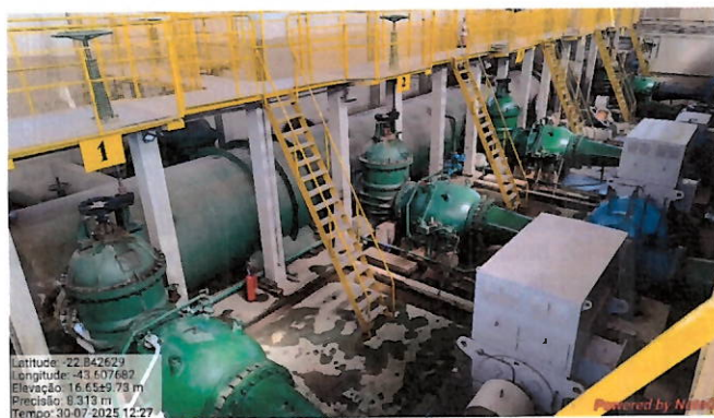
Foto 148: interior da elevatória ARG.
