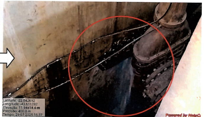
Foto 104: Galeria B – foto ampliada de válvula com vazamento.
