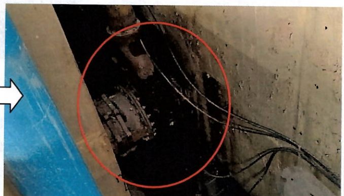
Foto 106: Galeria A – foto ampliada de válvula com vazamento.
