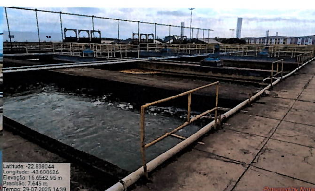
Foto 74: trechos com ausência de guarda-corpo.
