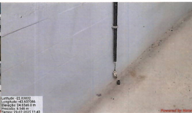
Foto 130: detector de vazamento de cloro.
