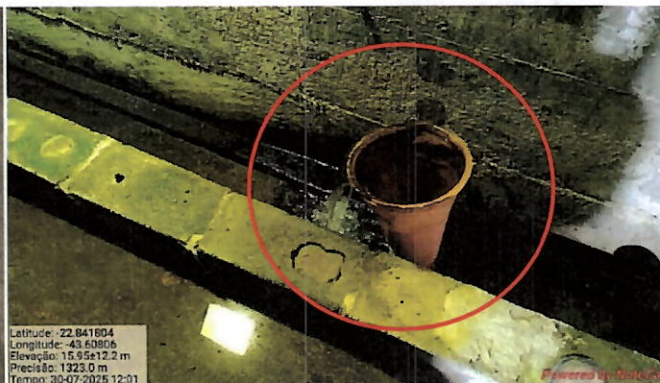
Foto 157: vazamento de água proveniente da parede do poço de sucção.
