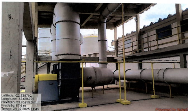
Foto 134: sistema de exaustão e abatimento de cloro.
