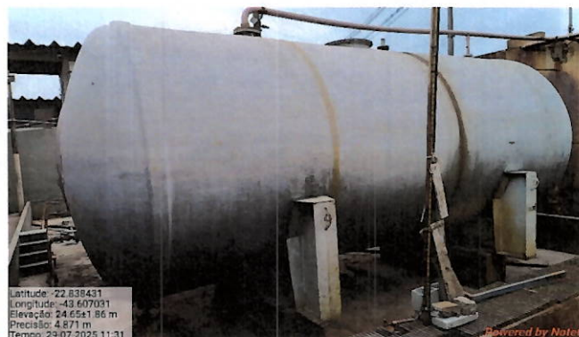
Foto 123: tanque de armazenamento de ácido fluossilícico.
