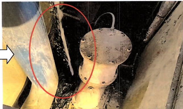
Foto 98: Galeria C – foto ampliada de válvula com vazamento.
