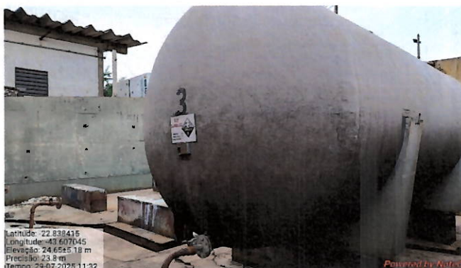
Foto 122: tanque de armazenamento de cloreto férrico.
