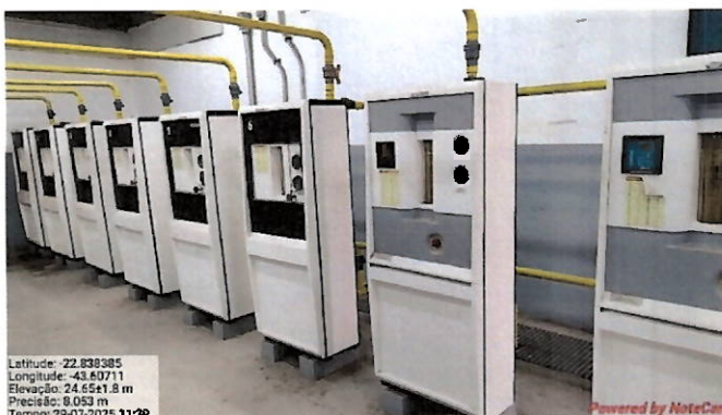
Foto 129: dosadores de cloro.
