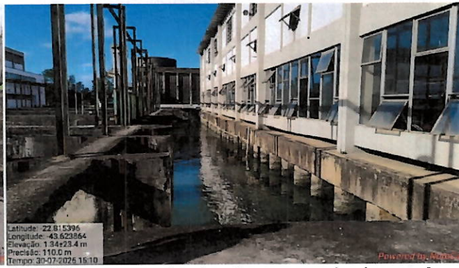
Foto 22: concreto deteriorado e ausência de guarda-corpos.
