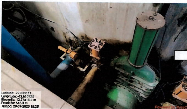
Foto 95: Galeria D – parede do filtro com vazamento.
