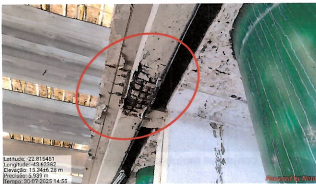
Foto 31: teto com concreto deteriorado e ferragens expostas.
