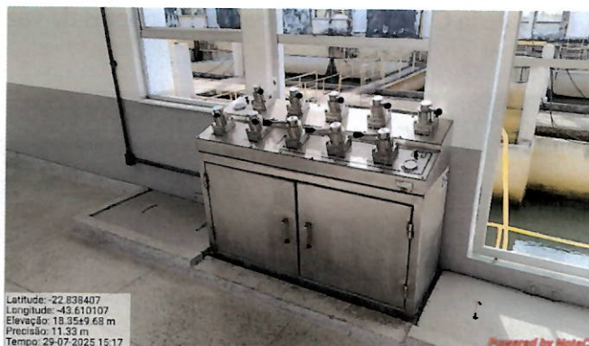
Foto 92: novas mesas de controle instaladas.
