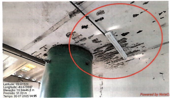
Foto 30: teto com concreto deteriorado e ferragens expostas.
