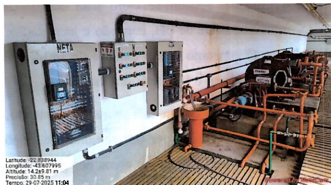
Foto 117: sistema de dosagem de coagulantes.
