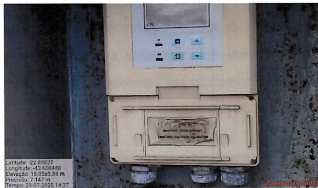
Foto 72: Equipamento eletrônico de monitoramento da qualidade da água na coagulação inoperante.
