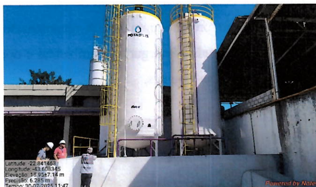
Foto 139: tanques armazenamento de cal líquida.
