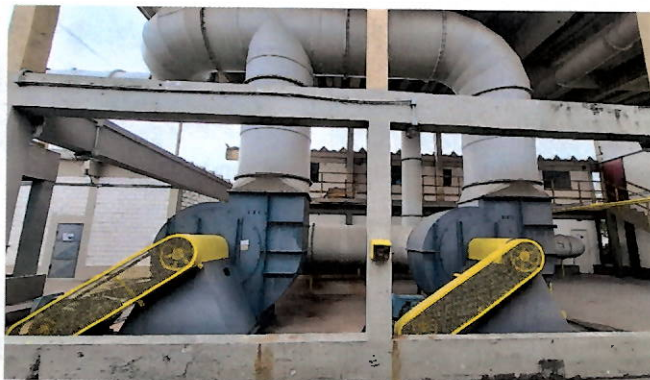
Foto 135: sistema de exaustão e abatimento de cloro.
