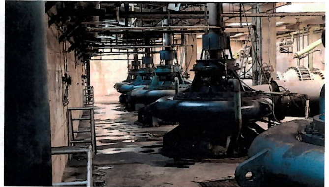
Foto 151: interior da elevatória NARG.
