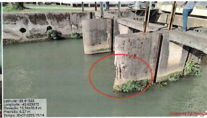
Foto 24: concreto deteriorado com ferragem exposta.
