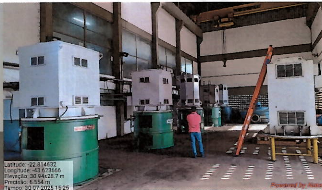
Foto 38: conjuntos motobombas do NBRG.
