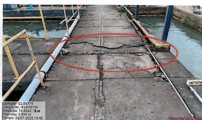
Foto 76: Pavimento de concreto danificado.
