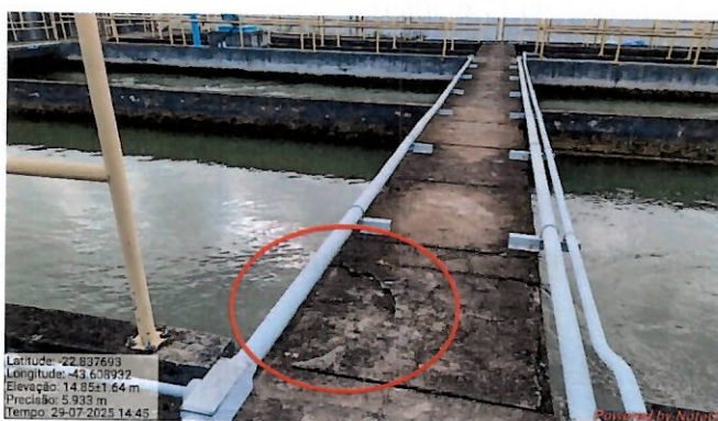
Foto 77: Pavimento de concreto danificado.
