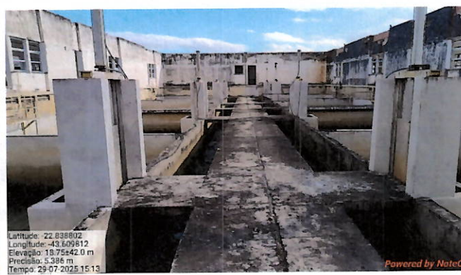
Foto 88: ausência de guarda-corpos.
