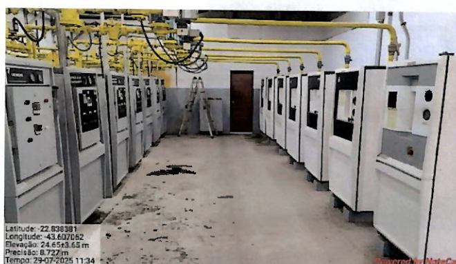
Foto 127: área de cloração.
