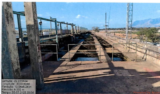
Foto 36: caixa de passagem localizada acima da elevatória do BRG.
