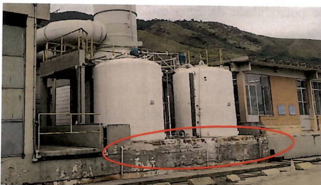
Foto 136: novos tanques de hidróxido de sódio (necessidade de restauração da bacia de contenção).
