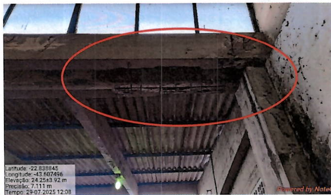
Foto 114: vigas danificadas da estrutura do telhado da Casa de Química.
