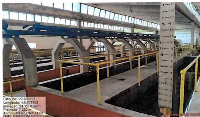
Foto 115: tanques de armazenamento de sulfato de alumínio.
