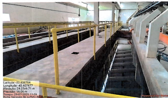
Foto 116: tanques de armazenamento de sulfato de alumínio.
