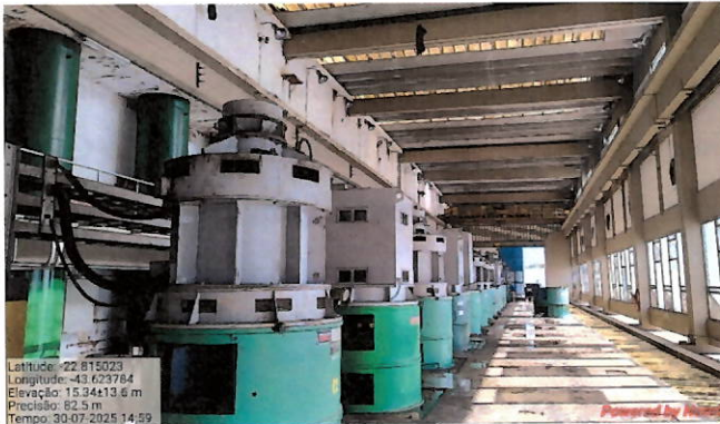
Foto 27: conjuntos motobombas do BRG.
