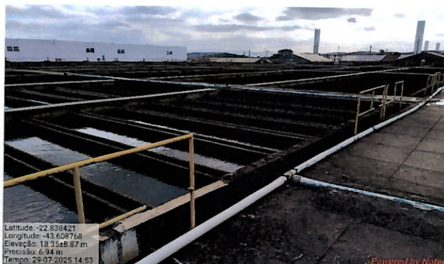
Foto 82: ausência de guarda-corpos.
