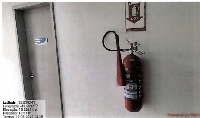
Foto 46: extintor de incêndio.
