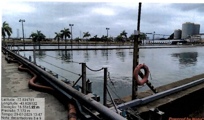
Foto 59: vista dos decantadores 8 e 9.
