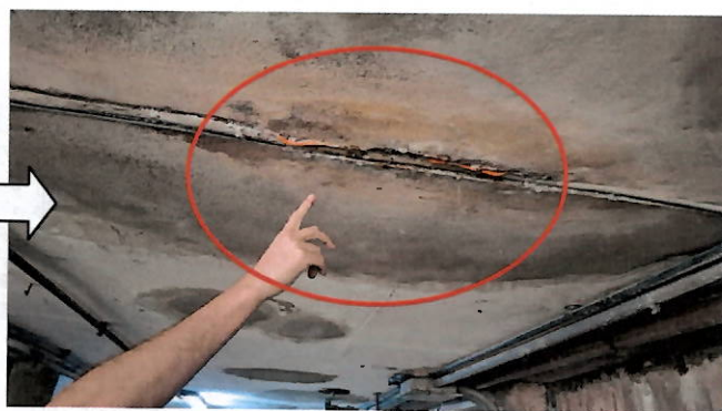
Foto 112: foto ampliada do vazamento do teto, proveniente da calha do decantador.
