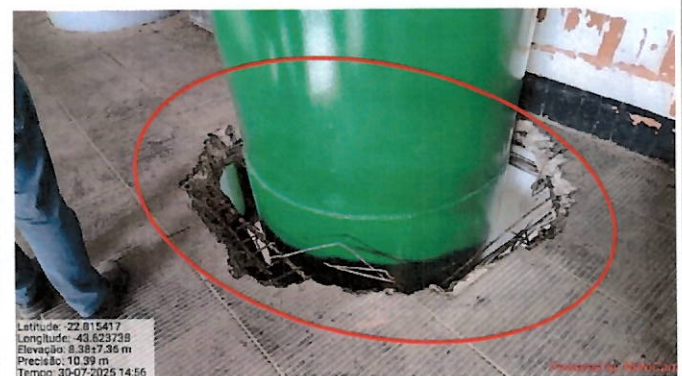
Foto 32: piso do segundo andar com ferragens expostas.
