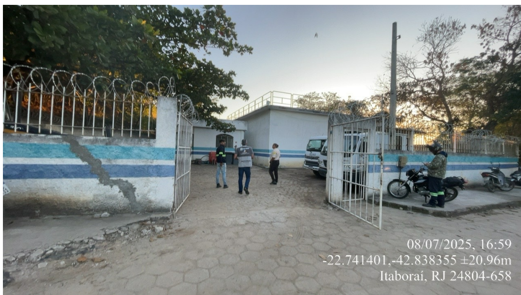
Foto 01 – Entrada do reservatório sem placa de identificação.
