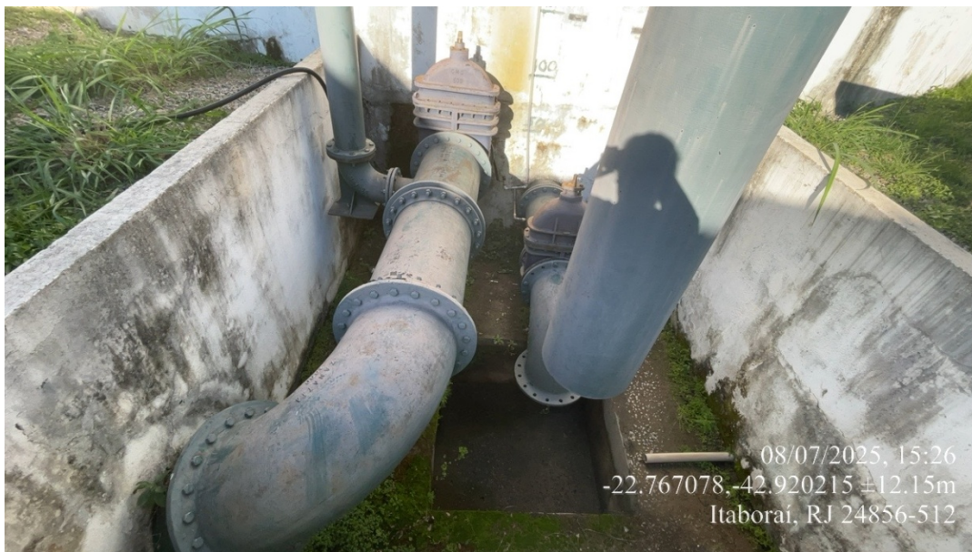
Foto 07 – Tubulações de entrada e limpeza.
