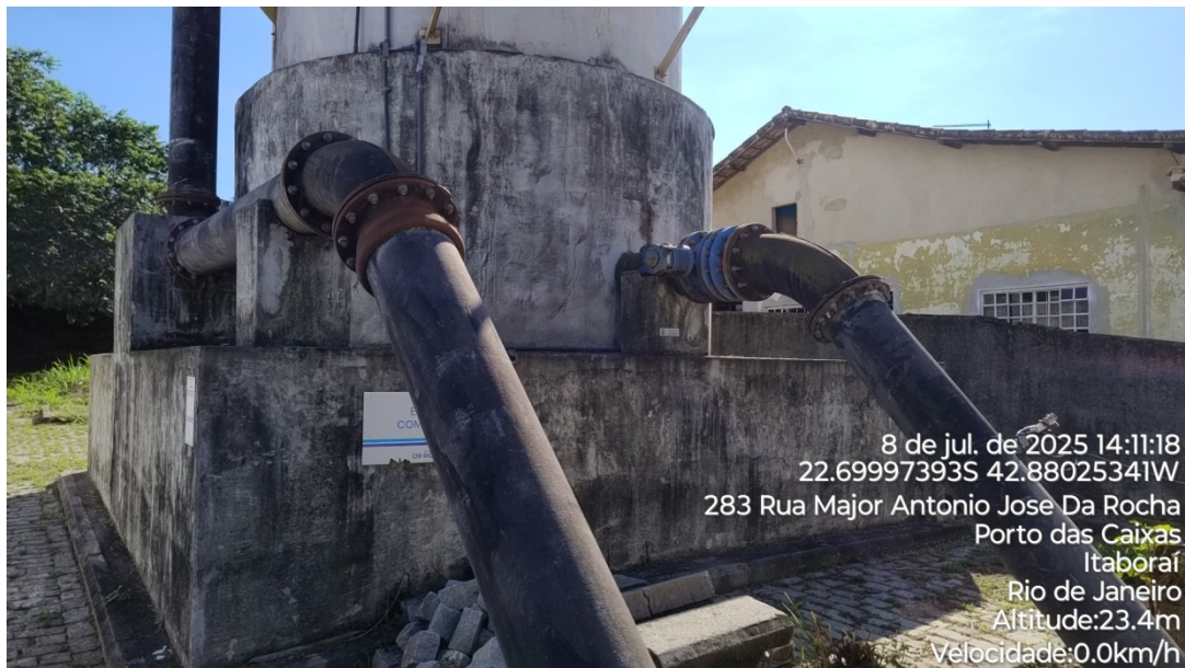
Foto 05: Tubulações de entrada e saída.
