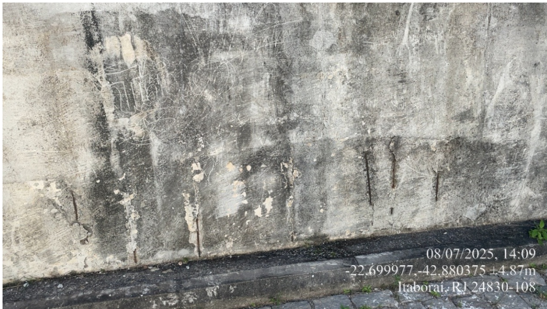
Foto 07 – Armadura de ferro exposta na base do reservatório.
