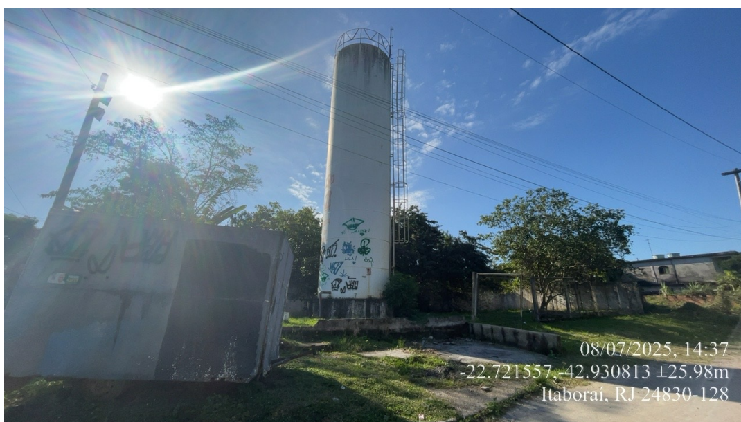
Foto 01 – Entrada do reservatório com ausência de isolamento e sem restrição de acesso.
