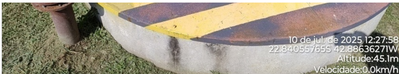
Foto 04 - Poço e elevatória da ETE.
