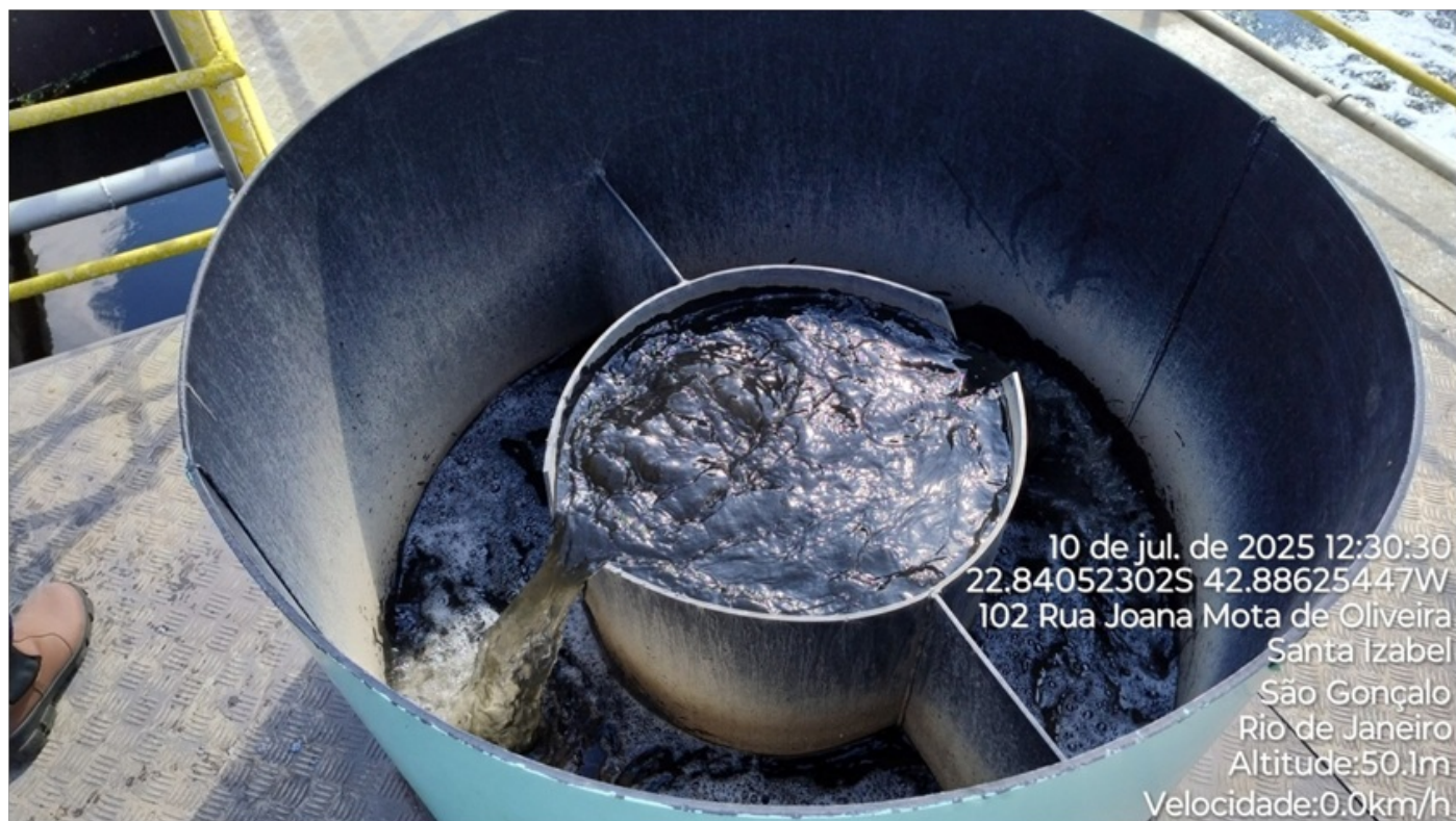
Foto 07 - Entrada do efluente no reator.
