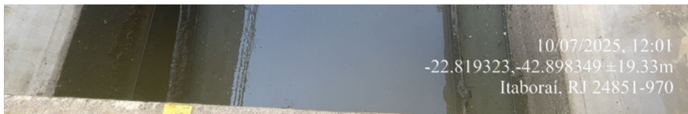
Foto 05 – Caixa separadora água / óleo.
