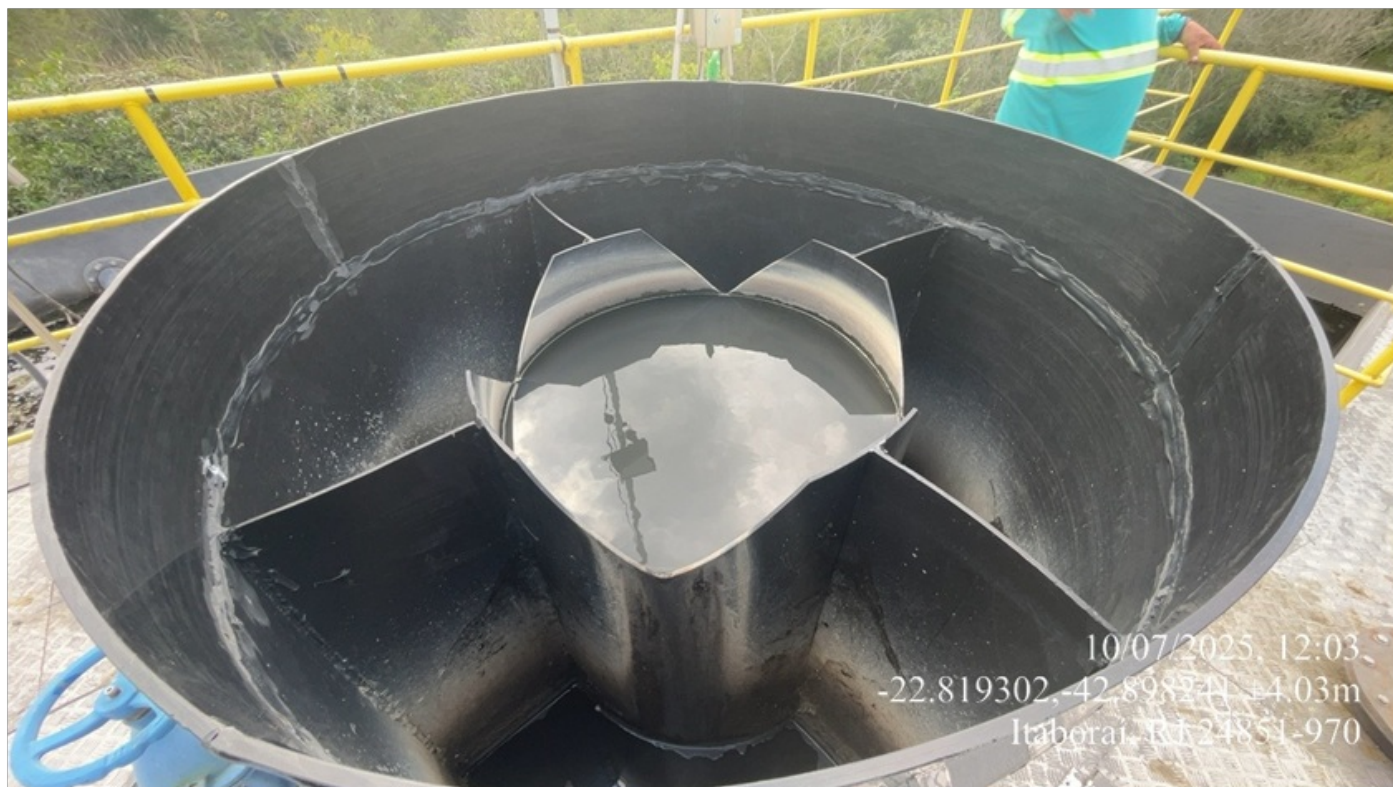
Foto 08 – Entrada do efluente no reator.
