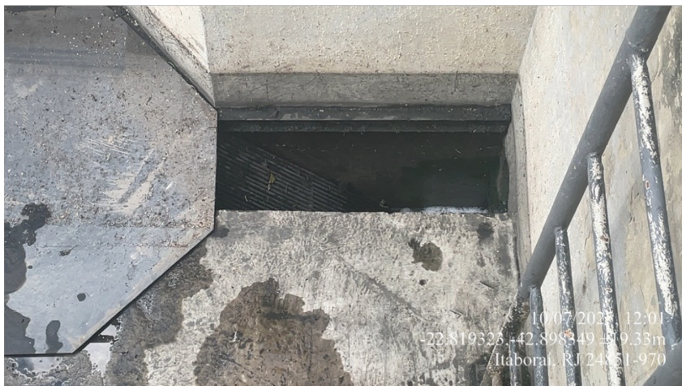
Foto 03 -Gradeamento de sólidos grosseiros na entrada do efluente.
