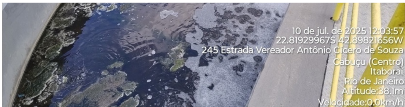
Foto 09 - Filtro biológico anaeróbio.
