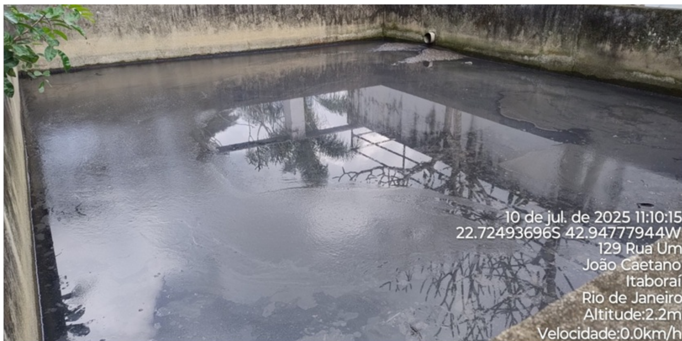
Foto 18 – Leito de secagem do lodo gerado.
