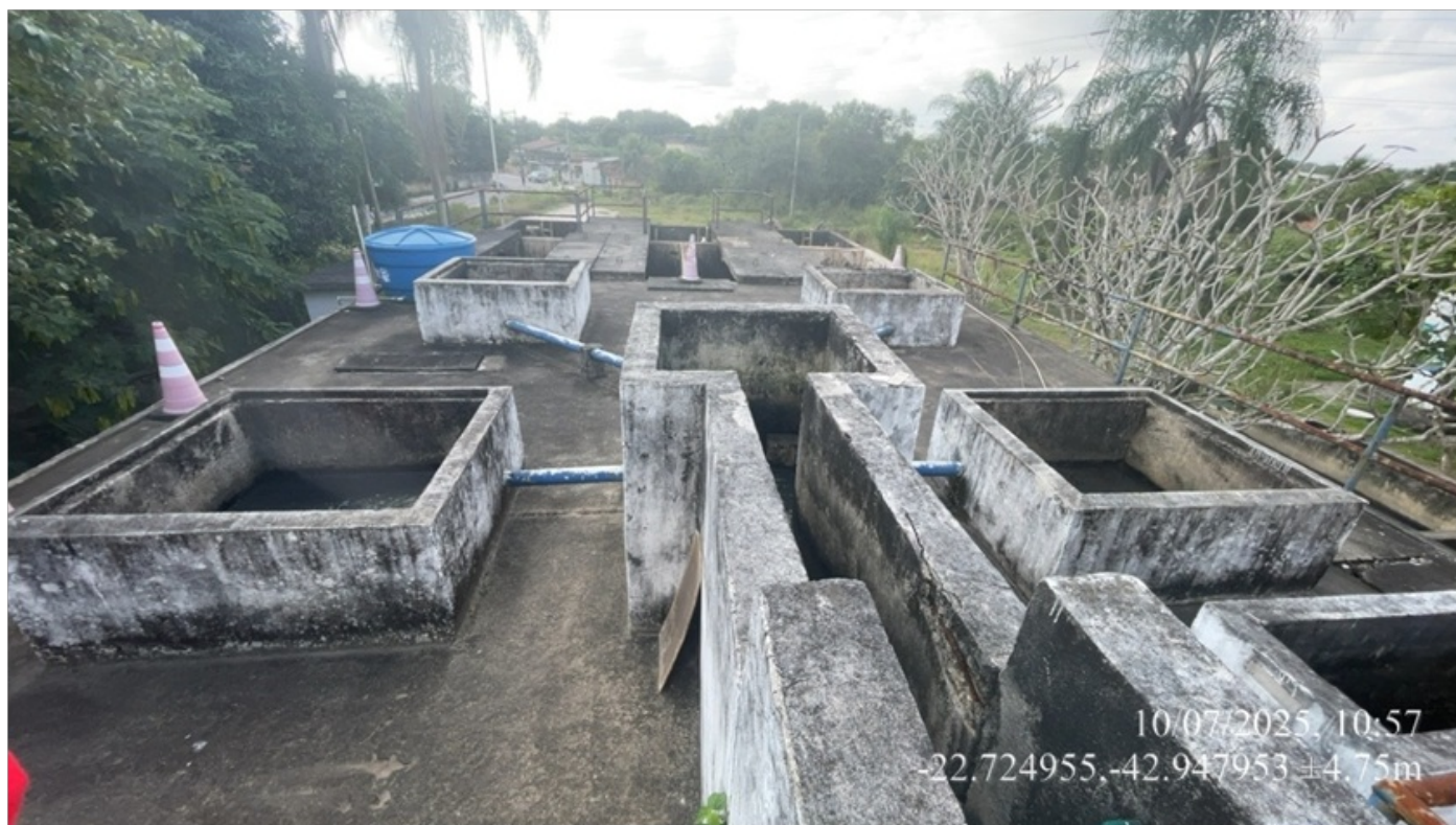
Foto 08 – Caixas de distribuição para o reator UASB.
