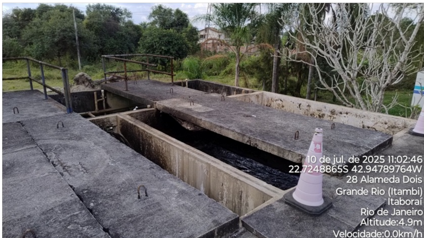
Foto 12 - Ausência de guarda-corpo no tanque de aeração.
