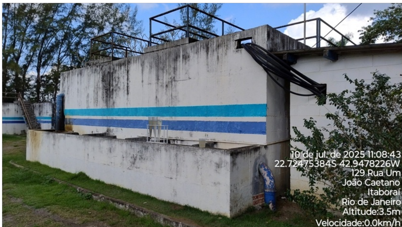
Foto 13 - Vista parcial da ETE.
