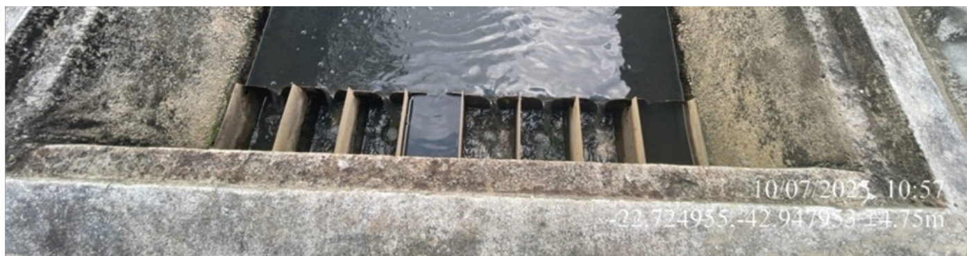
Foto 09 - Caixa de distribuição.
