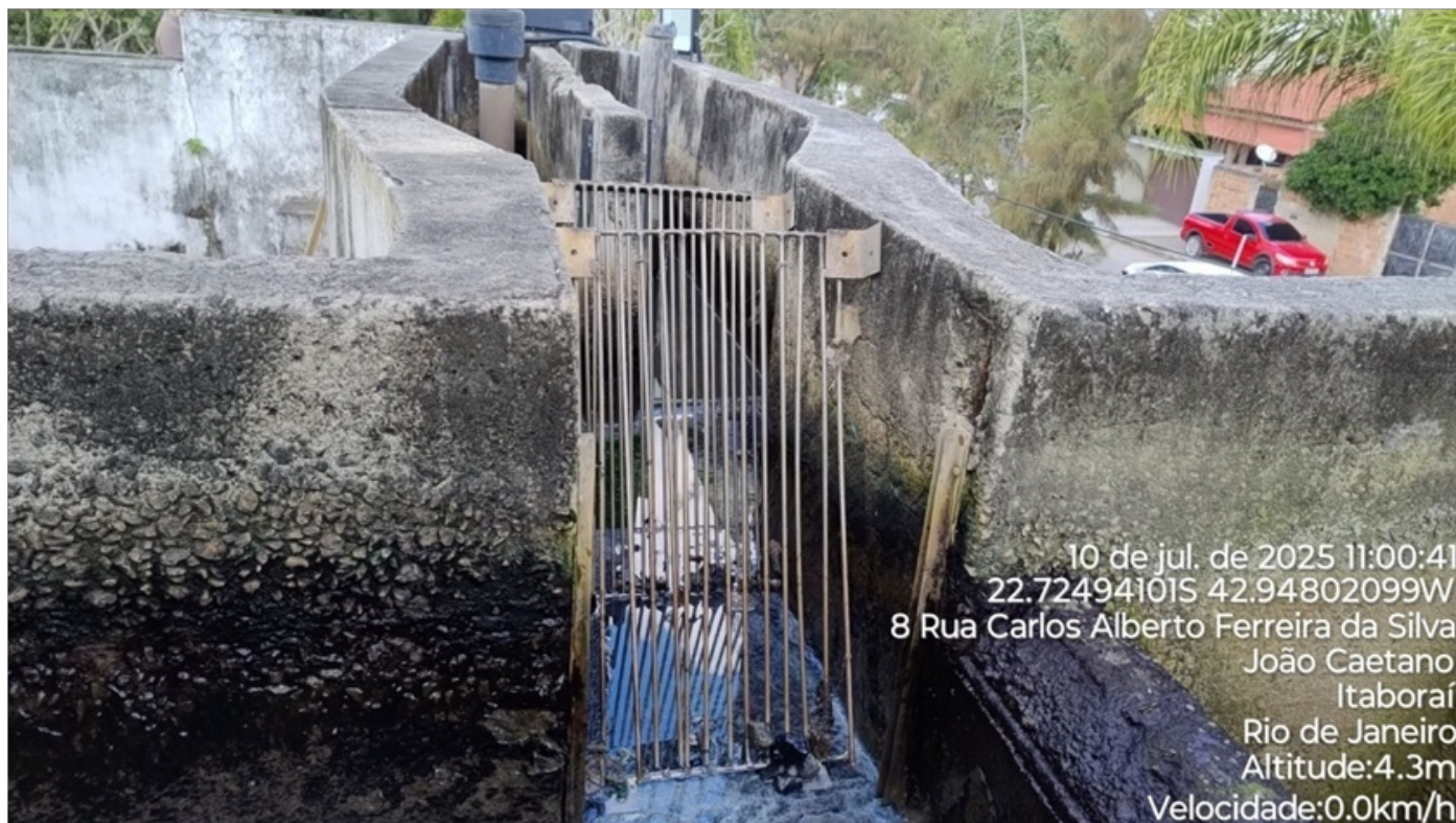
Foto 06 – Gradeamento na chegada do efluente.
