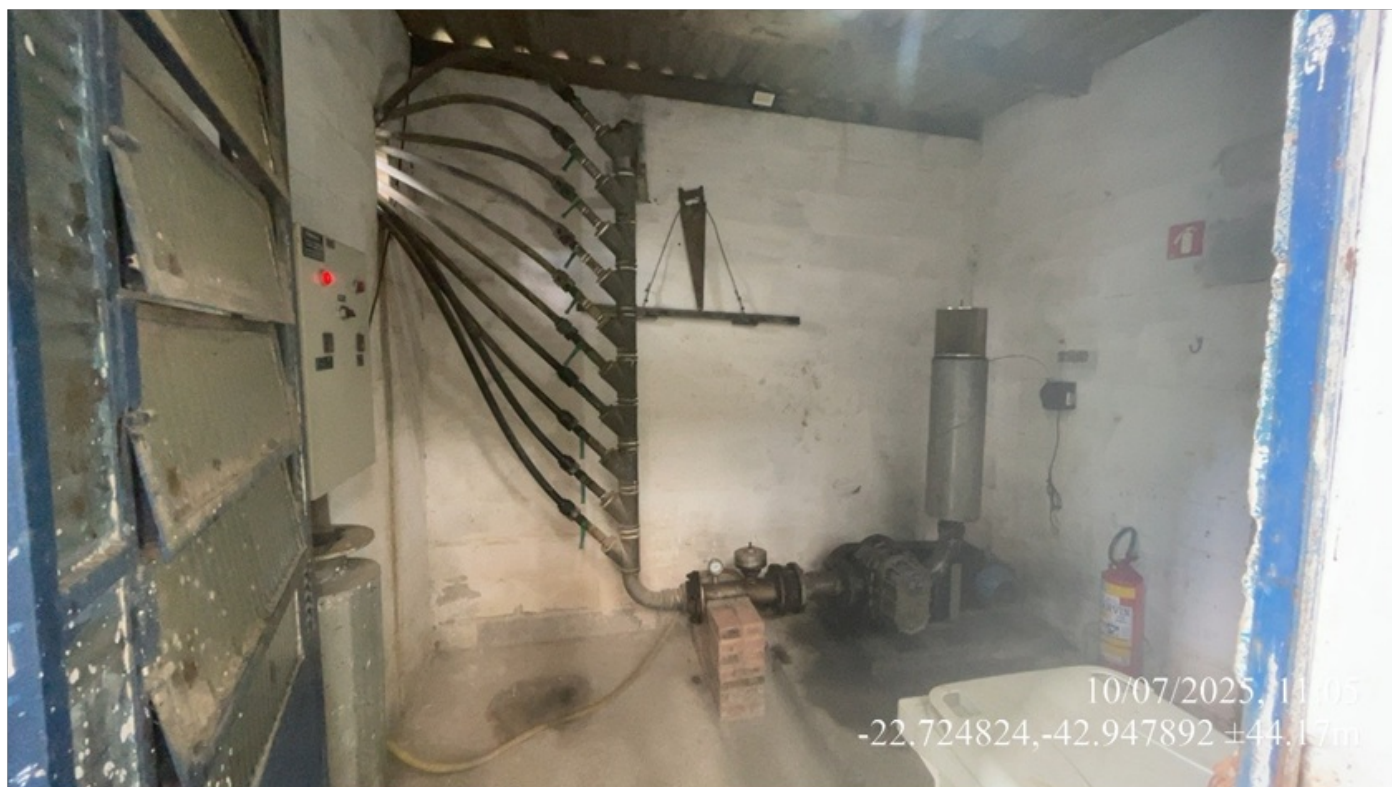
Foto 16 - Compressor de ar utilizado no tanque de aeração.
