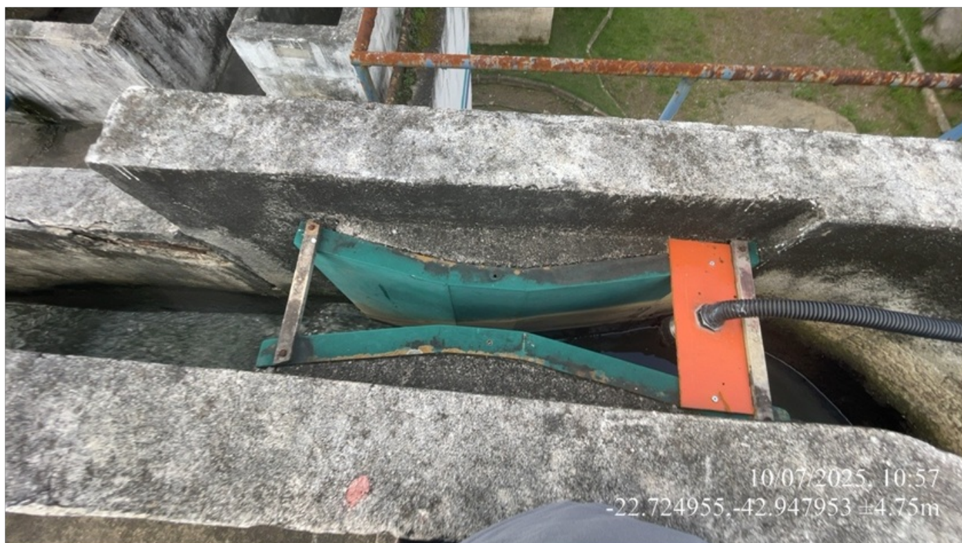
Foto 07 – Calha Parshall e medidor de vazão.
