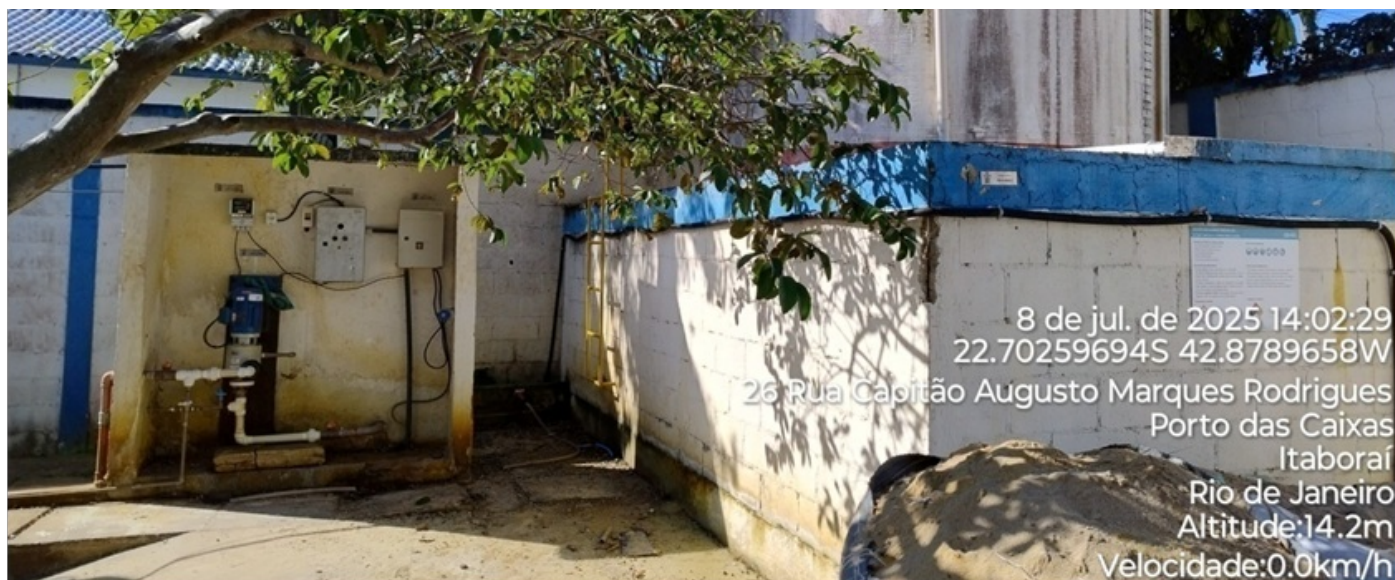
Foto 12 – Armazenamento e bombeamento do Sulfato de alumínio.
