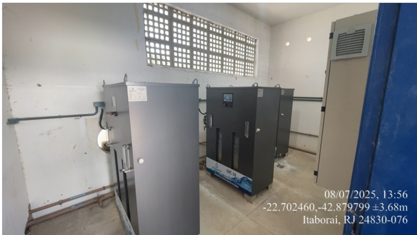
Foto 14 - Geradores de hipoclorito de sódio.
