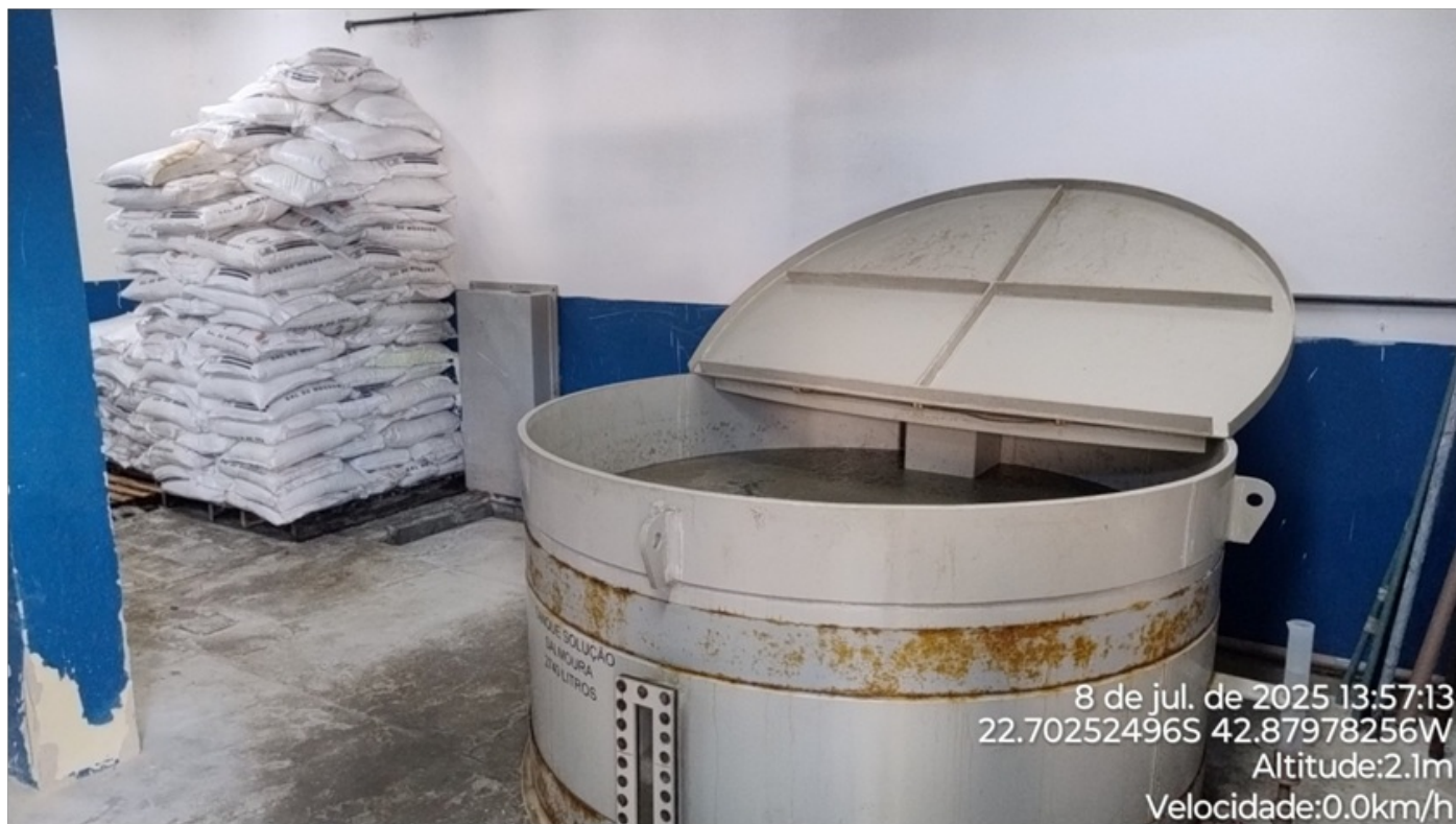
Foto 13 - Armazenamento dos insumos para produção do hipoclorito de sódio.
