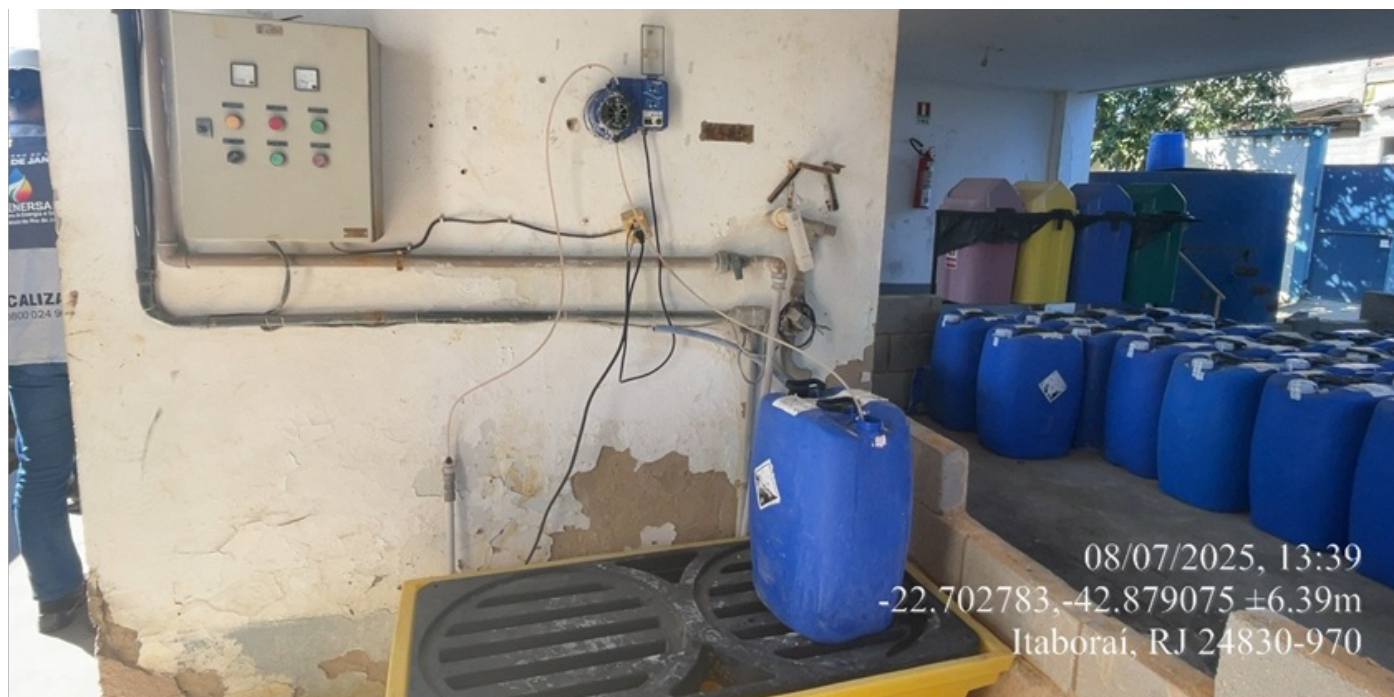
Foto 16 - Armazenamento e bombeamento do ácido fluossilícico.
