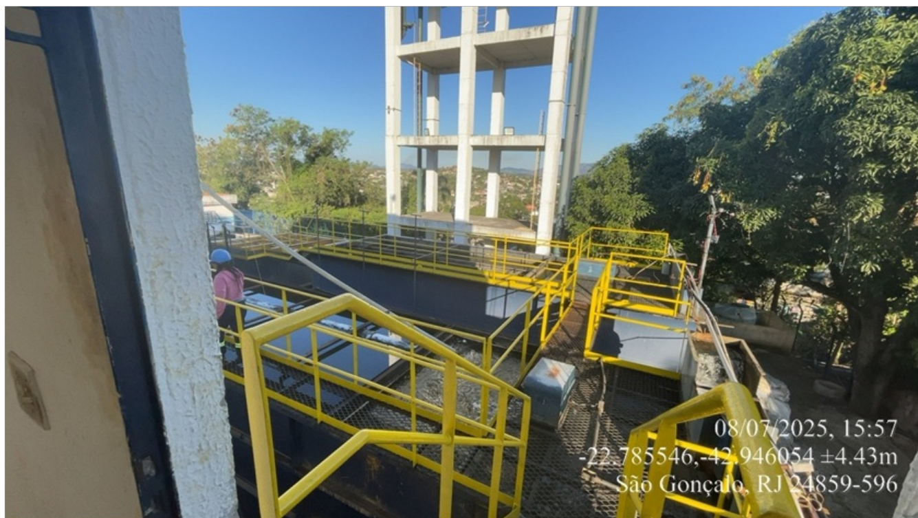
Foto 01 – Vista geral dos módulos de tratamento.
