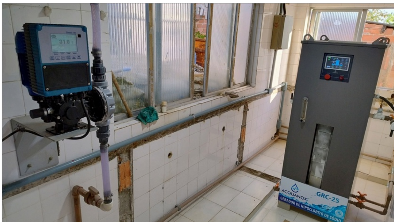
Foto 11 - Equipamento de produção do Hipoclorito de sódio.
