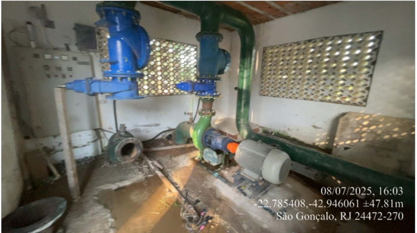
Foto 14 - Casa de bombas da EEAT para distribuição.
