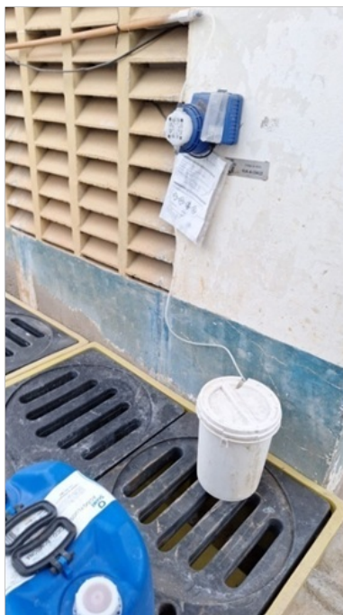
Foto 14 – Dosador de flúor com baia de contenção
