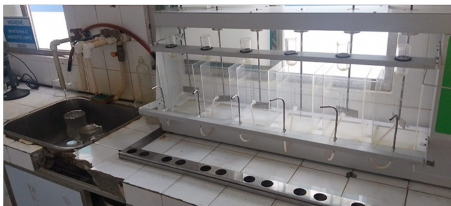
Foto 18 – Laboratório necessitando de reparo na bancada.
