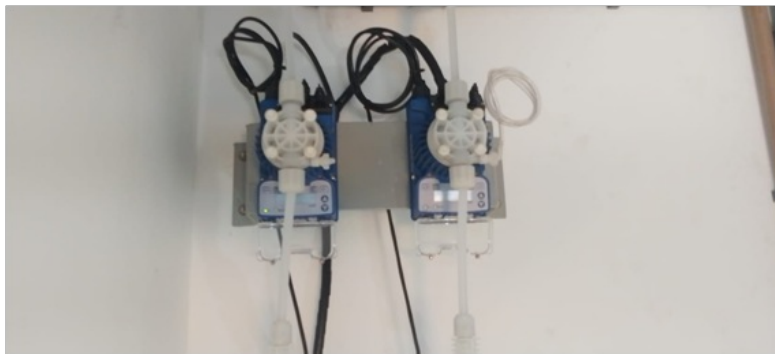
Foto 13– Dosadores de Hipoclorito de Sódio
