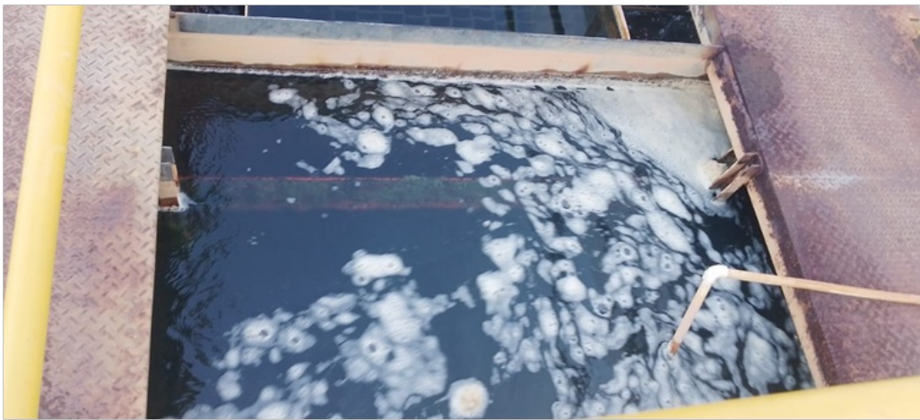
Foto 9 – Dosagem de sulfato de alumínio ferroso
