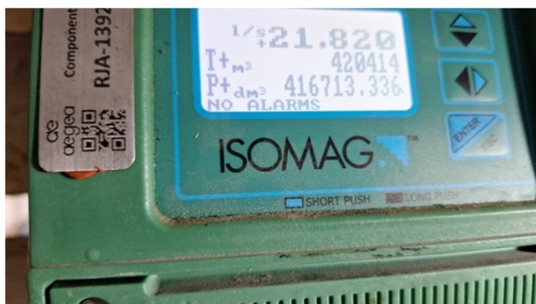
Foto 5, 6 e 7 – Medidores de vazão: água bruta do Rio Paraíba (20,28 l/s) + água de barragem (1,836 l/s) = água tratada 21,82 l/s) + descarga de limpeza de filtros
