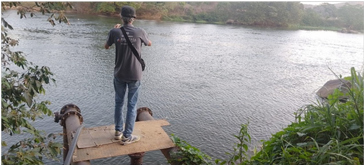
Foto 3 – Manancial com tubulação de captação
