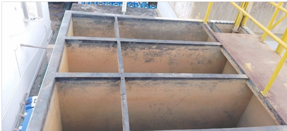
Foto 11 – Vista dos Filtros
