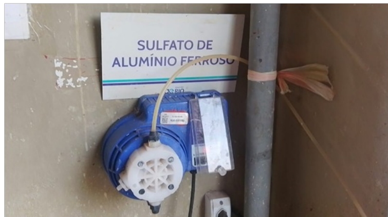
Foto 12 – Vista do novo dosador de sulfato de alumínio
