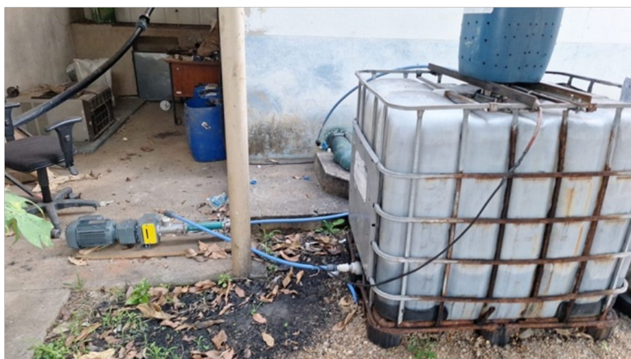
Foto 8 – Unidade de dosagem de carvão ativado.
