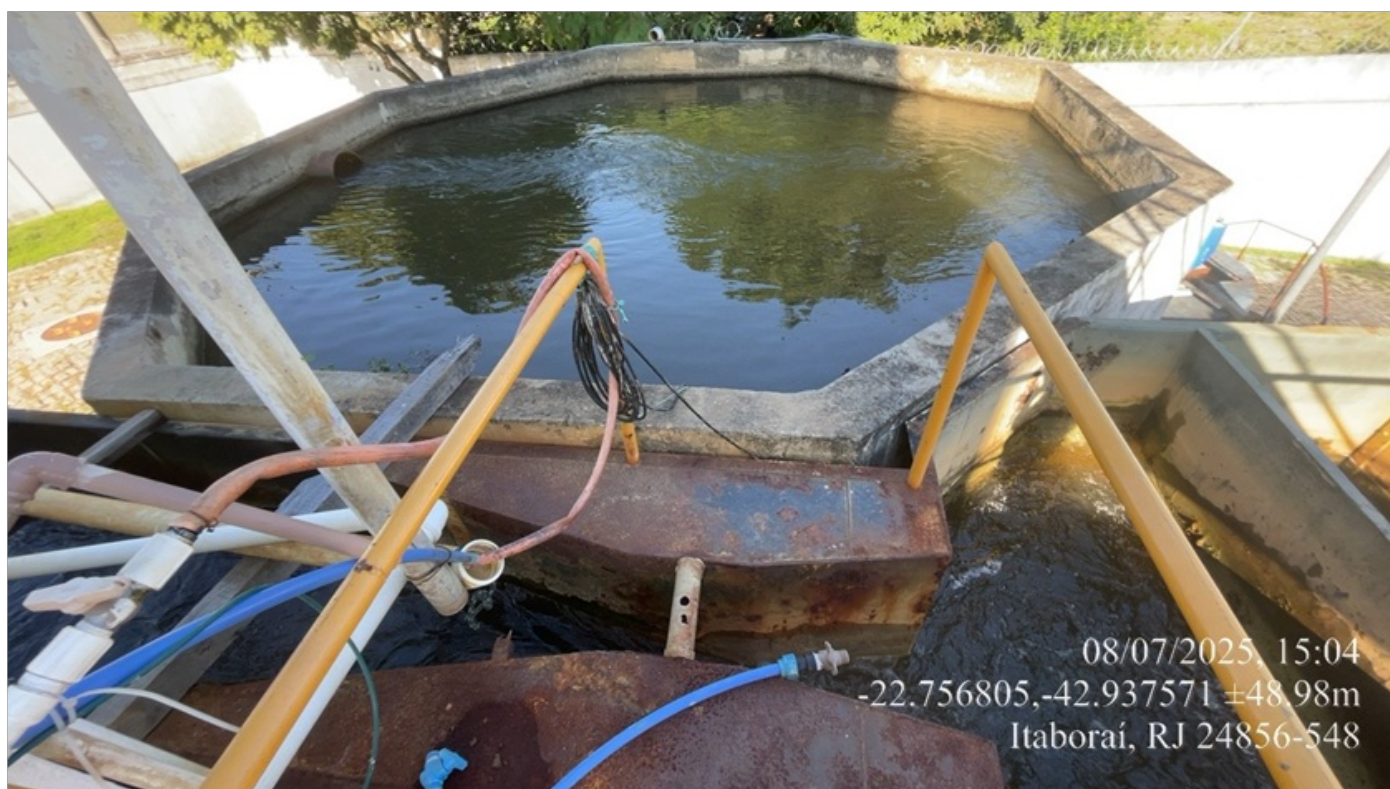
Foto 05 – Chegada da água bruta na Calha Parshall, sensor de medição de vazão e aplicação do agente aglutinante.
