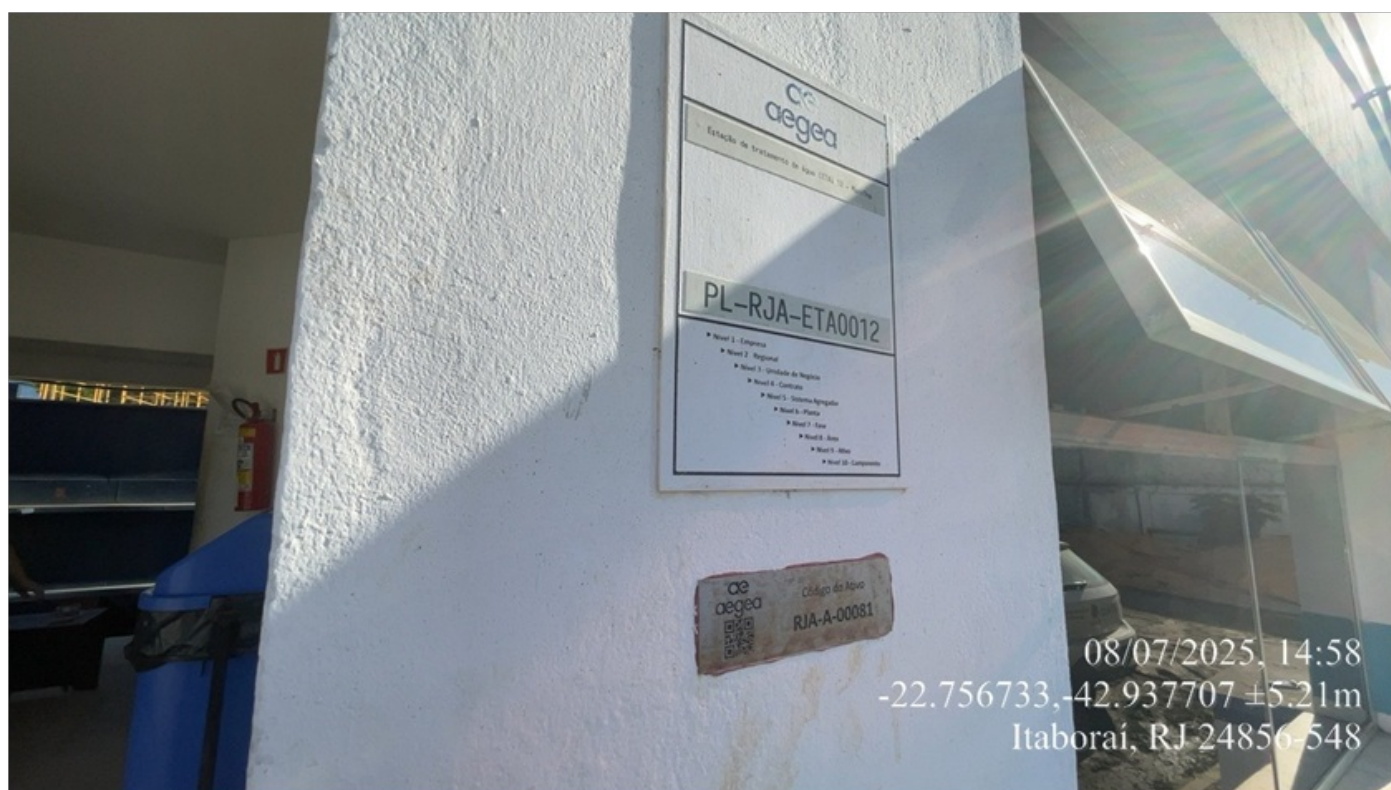
Foto 02 – Placa interna de identificação do bem reversível.
