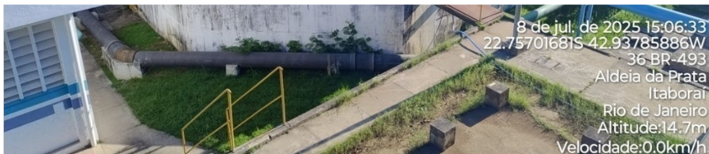
Foto 18 – Reservatório com capacidade de 800 m³.
