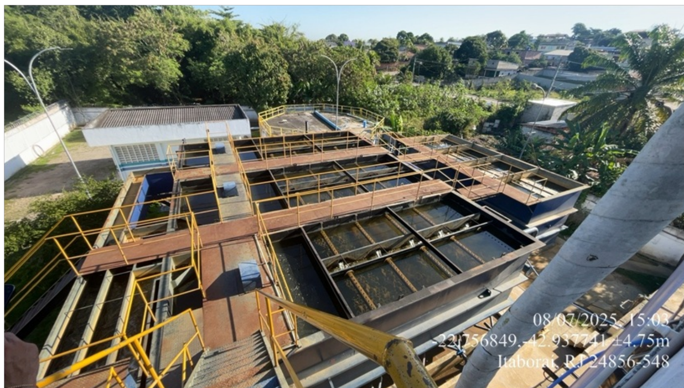
Foto 03 – Vista geral dos módulos de tratamento.
