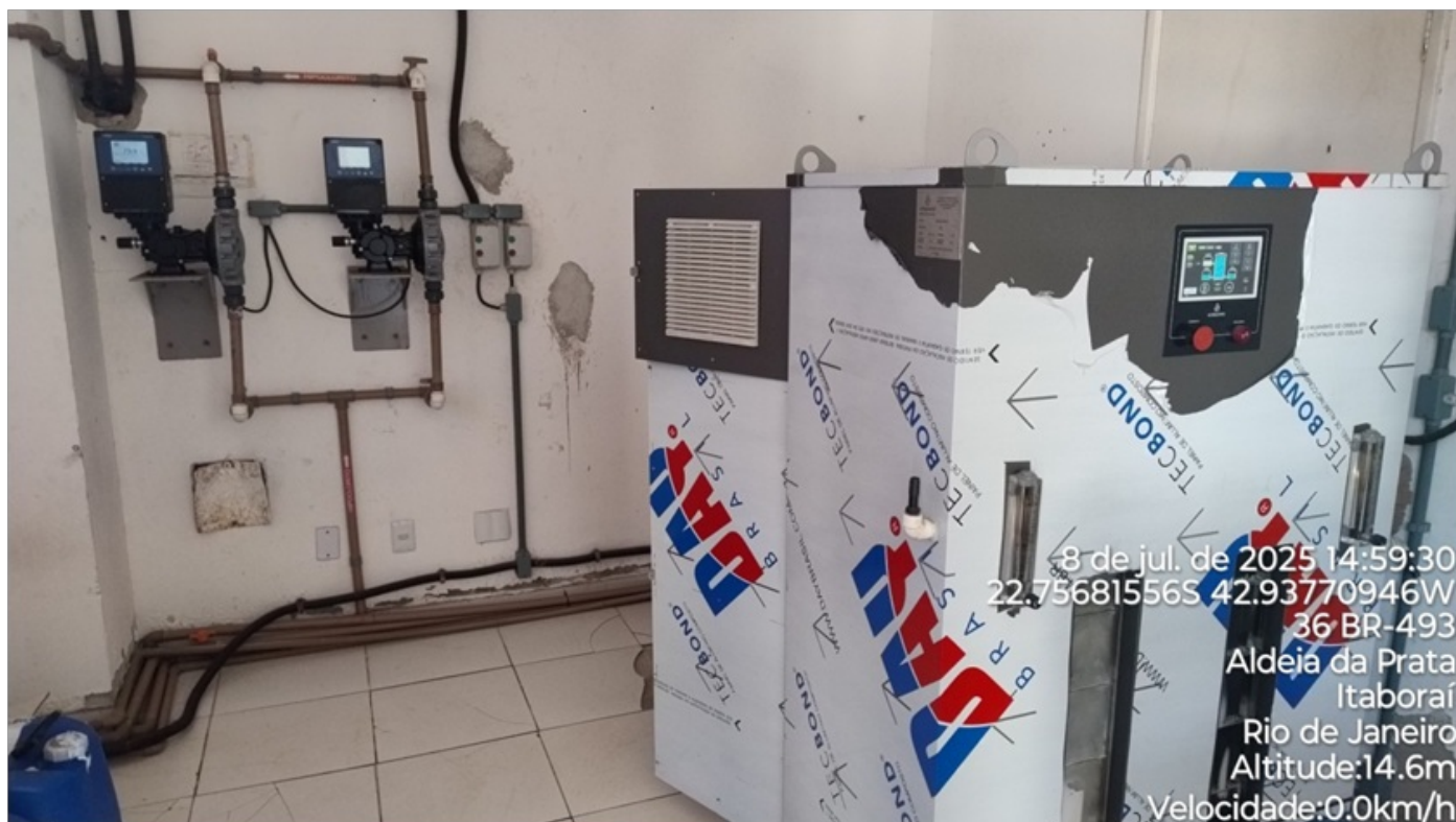
Foto 15 - Equipamento de produção do Hipoclorito de sódio.
