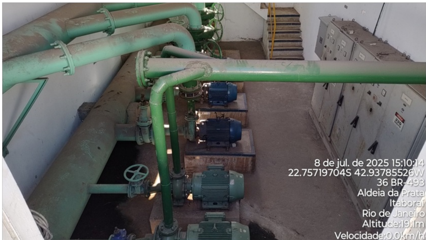
Foto 19 - Casa de bombas para lavagem dos filtros e EEAT para distribuição.
