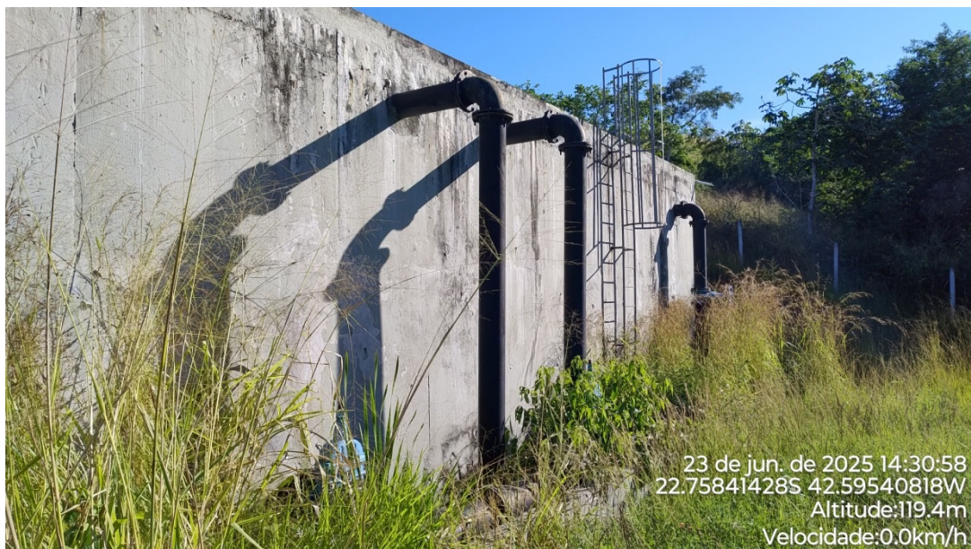
Foto 06 – Vista das tubulações de entrada, recalque e escada de acesso ao topo.
