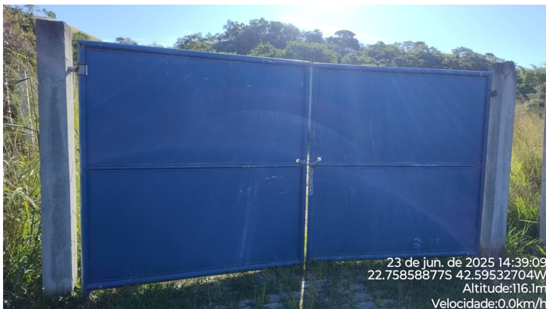
Foto 01 – Entrada do reservatório sem placa de identificação.
