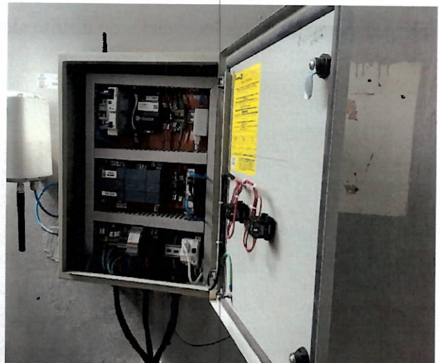
Figura 26- PAINEL das elevatórias.
