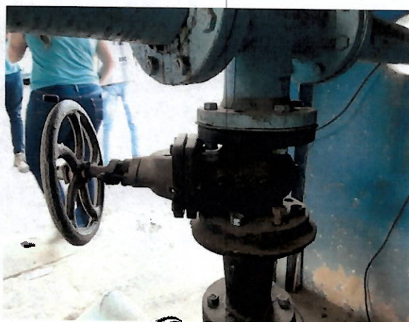
Figura 31 – Barrilnete de Recalque.
