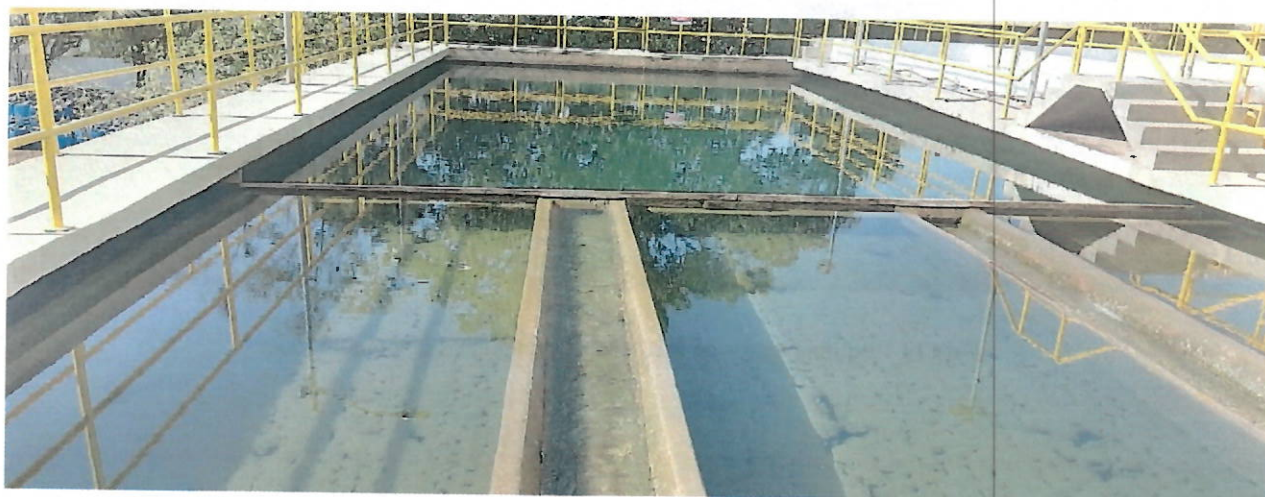
Foto 12 – Vista do Decantador.
