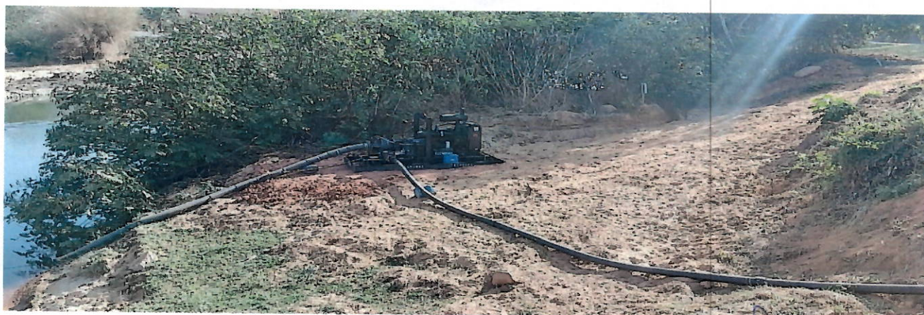
Foto 02 – Bomba submersível, instalada do lado externo da construção.
