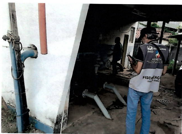
Figura 30 – Vista do conjunto motobomba e barrilnete.
