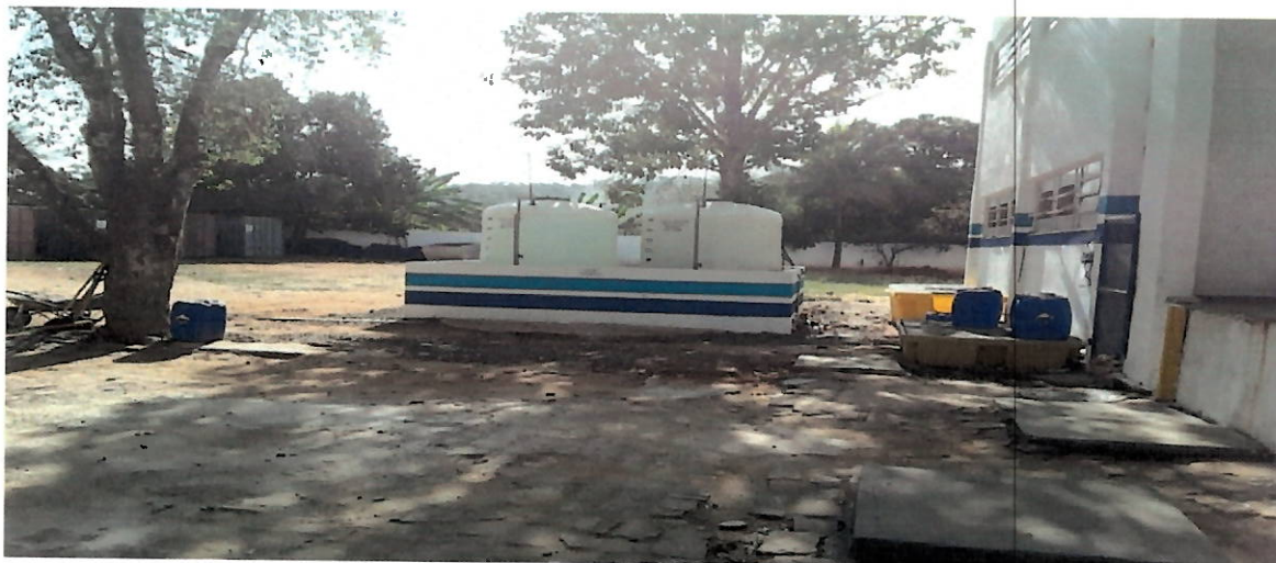
Foto 19 – Tanques solução de hipoclorito de sódio.
