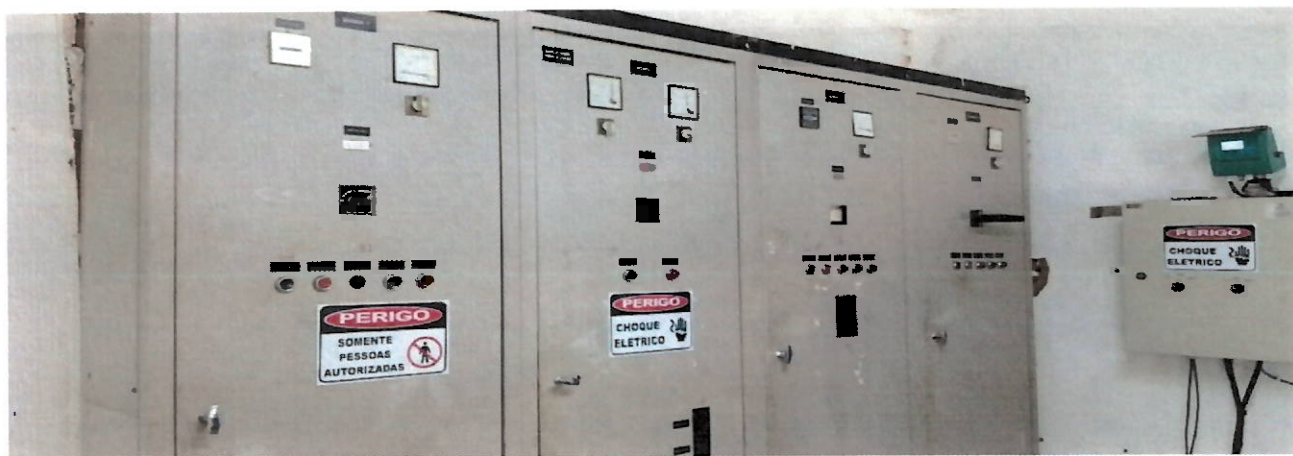
Foto 05 -- Painelelétrico sinalizado quanto ao risco de choque elétrico.
