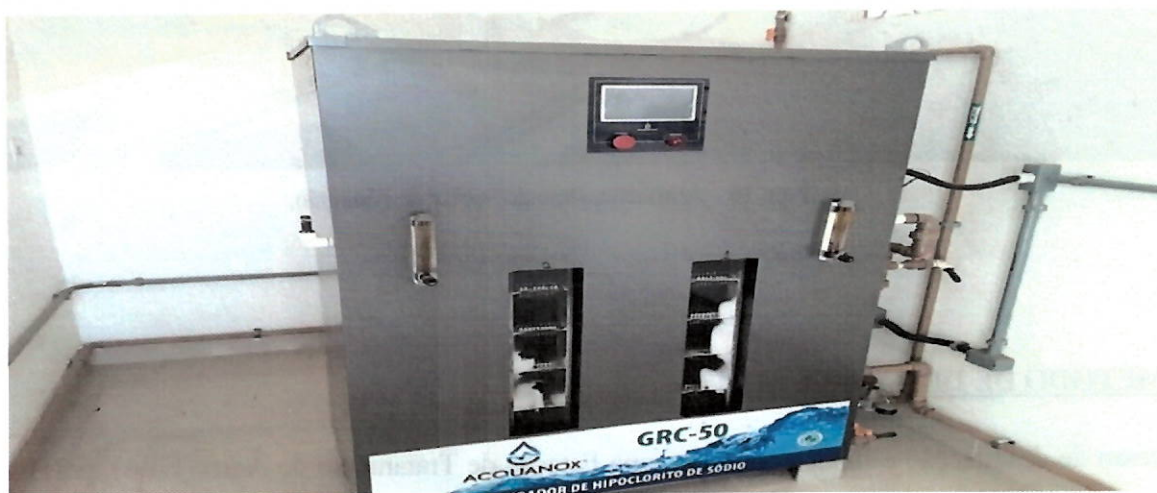
Foto 18 – Gerador de hipoclorito de sódio.
