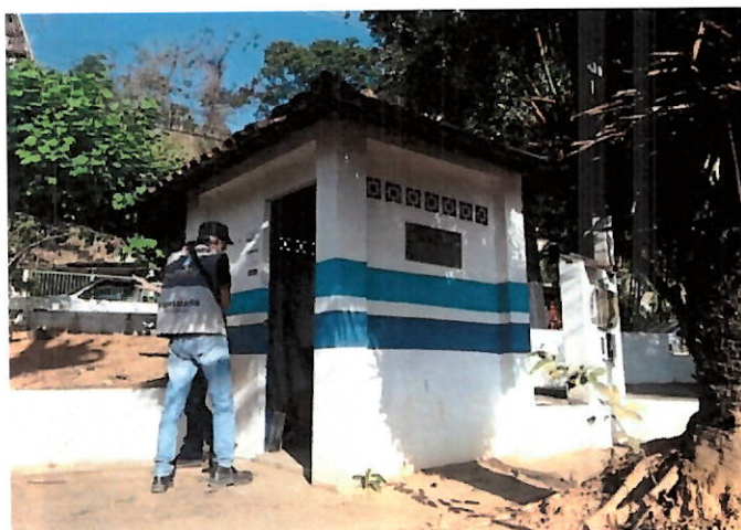
Figura 33- Abrigo do conjunto motobombade potência 5cv.
