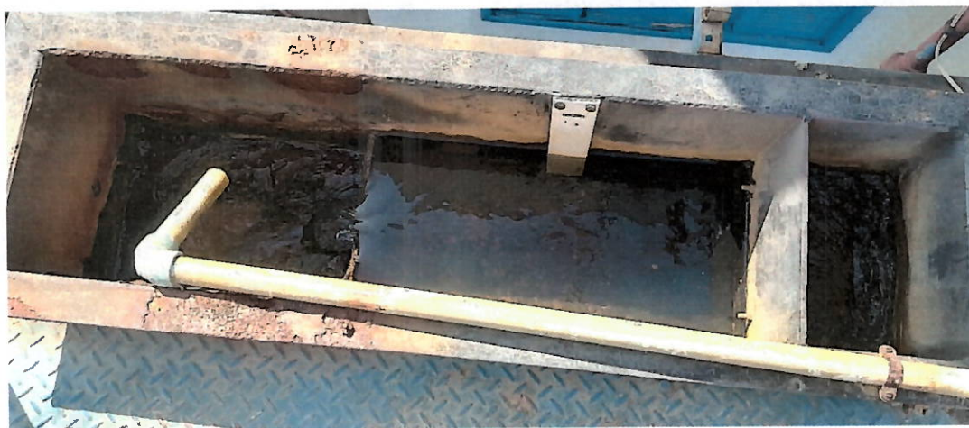
Figura 38 – Entrada da água bruta na calha Parshall e dosagem de sulfato de alumínio da ETA.
