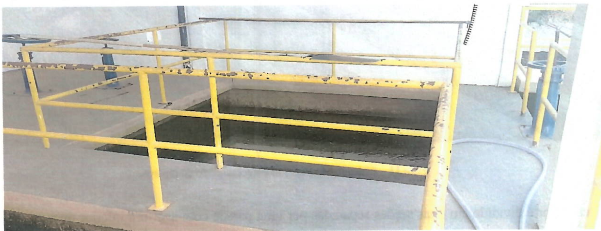
Foto 13 – Vista dos Filtros.
