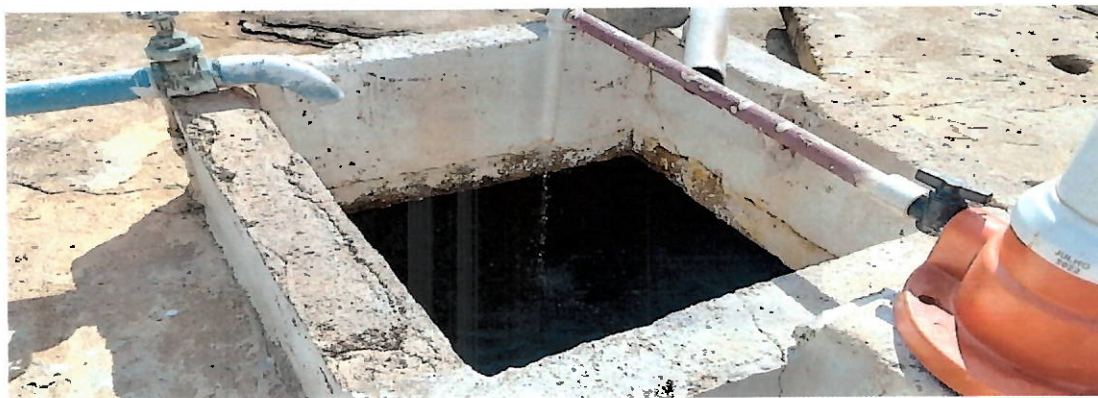
Figura 50 – Cisterna com capacidade de 20 m 3 .
