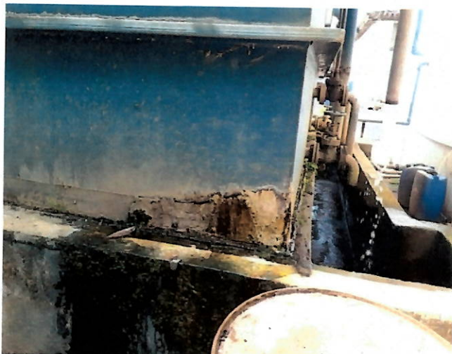
Figura 43 – Sinais de má conservação na estrutura do módulo.
