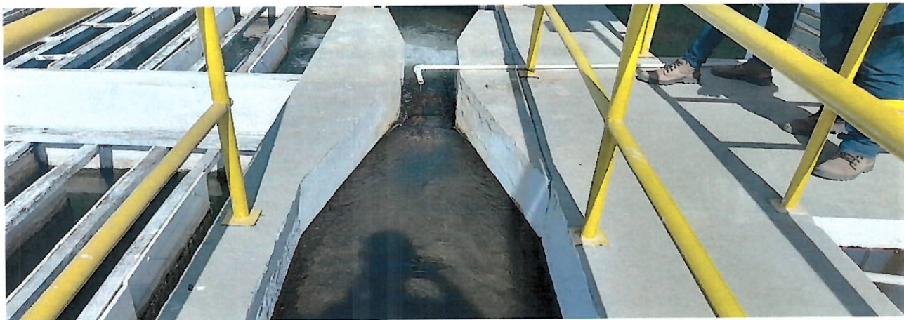
Foto 09 – Entrada da água bruta na calha Parshall e dosagem de sulfato de alumínio da ETA.
