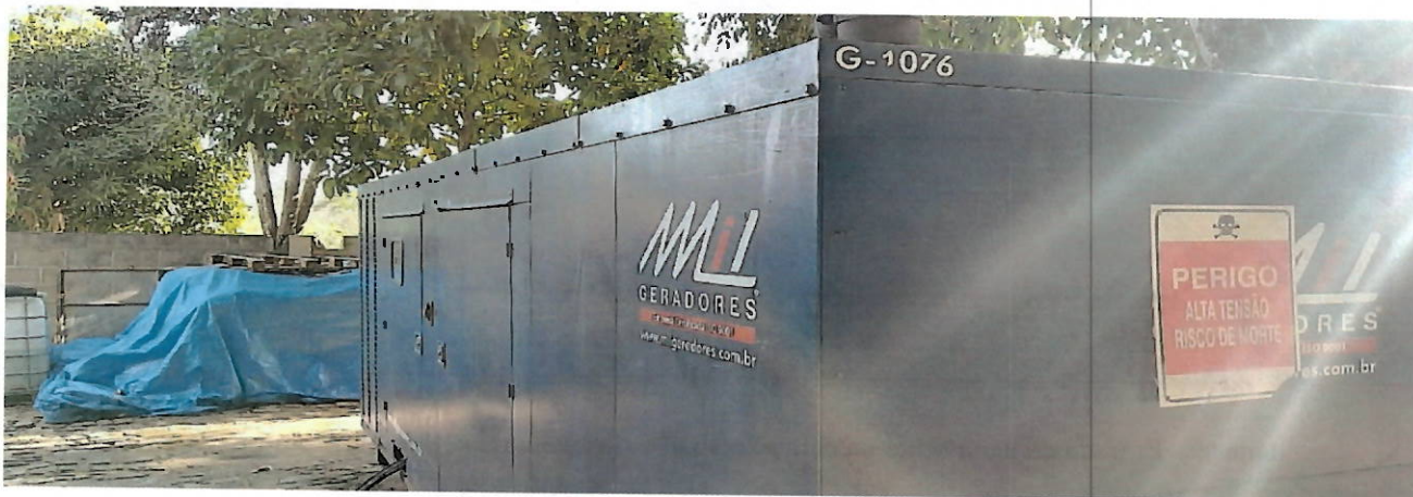
Foto 07 – Gerador de Energia da Estação Elevatória.
