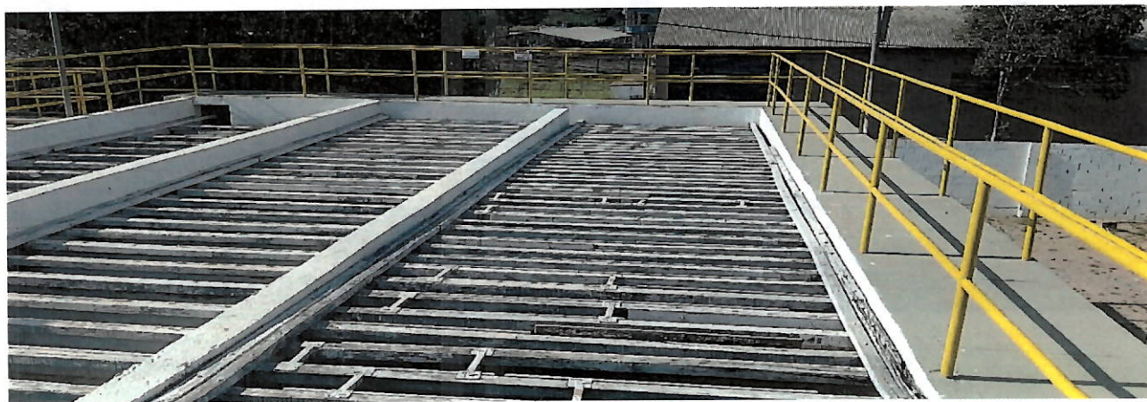
Foto 10 – Floculador da Estação de Tratamento.
