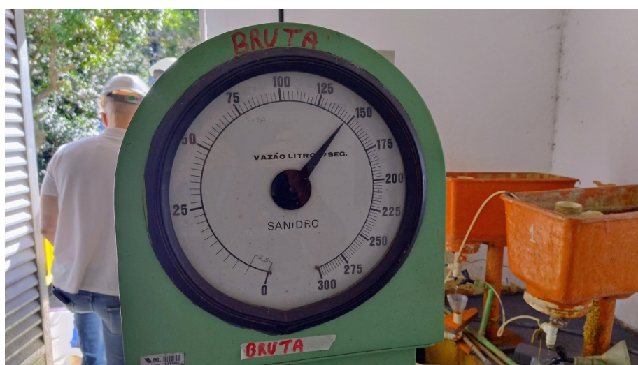
Foto 02 – Macromedidor da estação de tratamento
