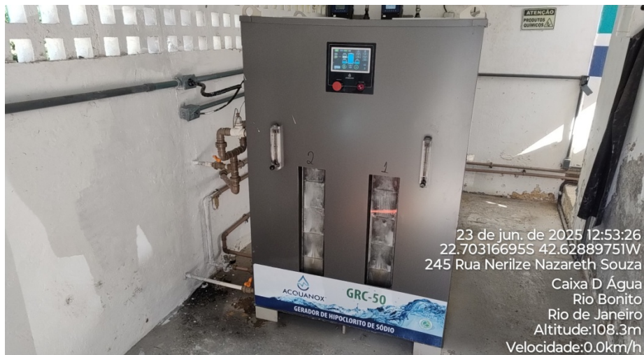
Foto 14 - Gerador de hipoclorito de sódio
