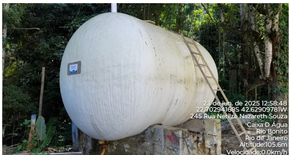
Foto 19 –Tanque de armazenamento de Sulfato de Alumínio, ausência de bacia de contenção
