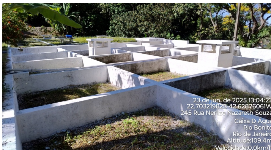
Foto 21 – Reservatórios de 500 m³ e 1.000 m³
