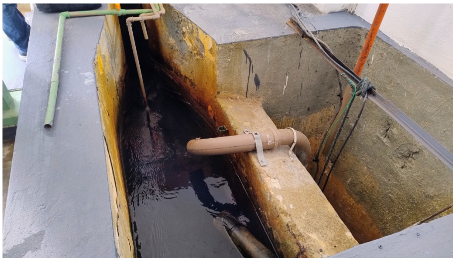
Foto 03 – Calha Parshall e aplicação de coagulante
