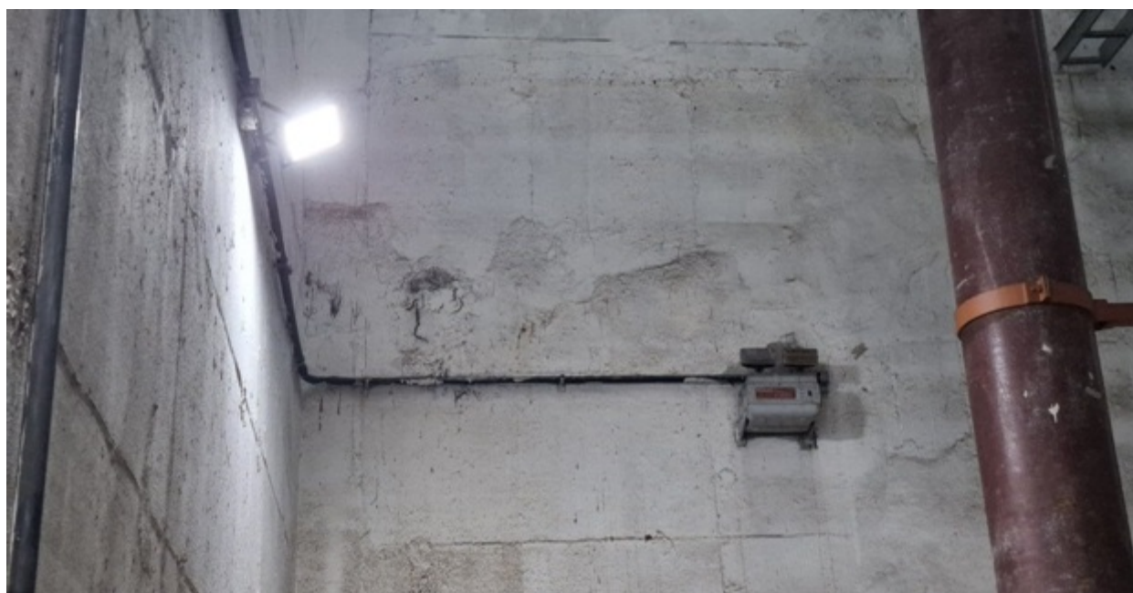
Foto 14 – Iluminação artificial do abrigo das motobombas
