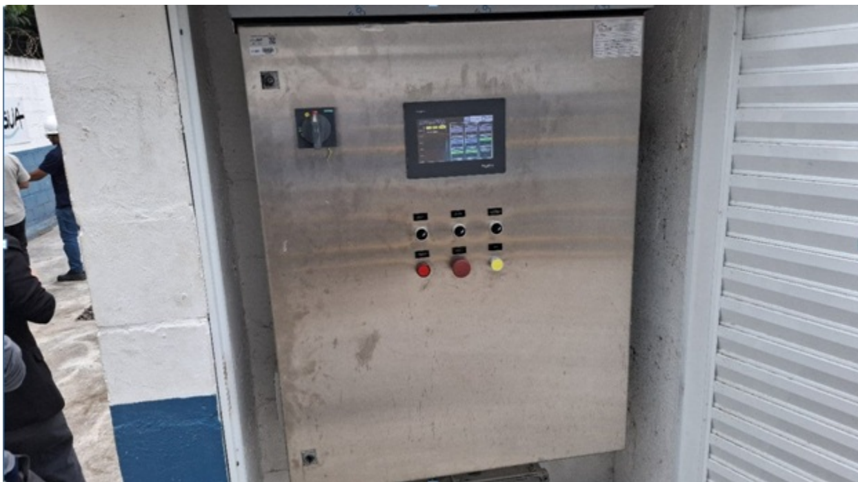
Foto 7 – Painel elétrico dos gradeamentos
