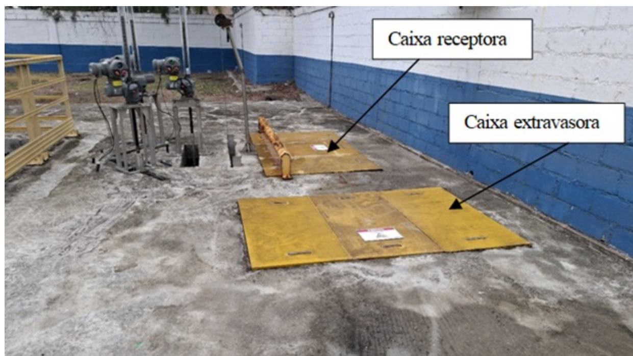
Foto 4 – Caixas receptora e extravasora
