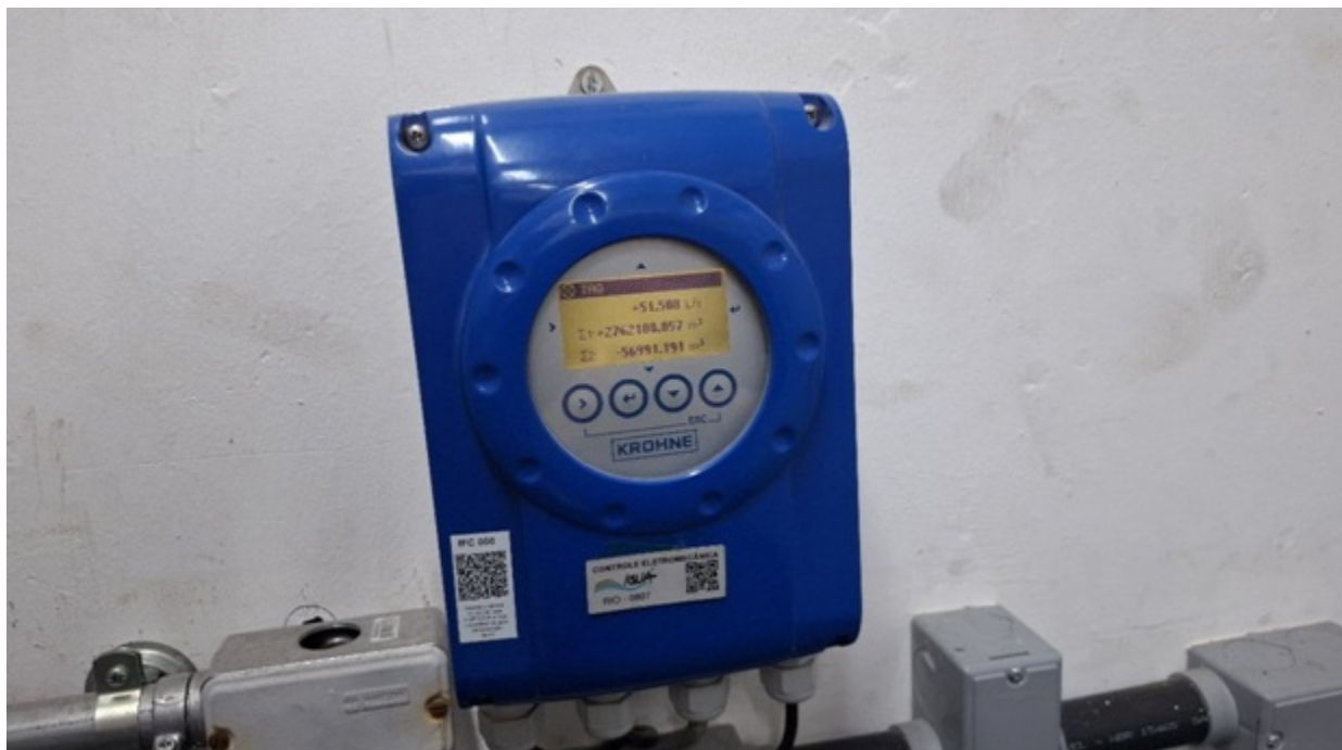
Foto 21 – Medidor de vazão e volume
