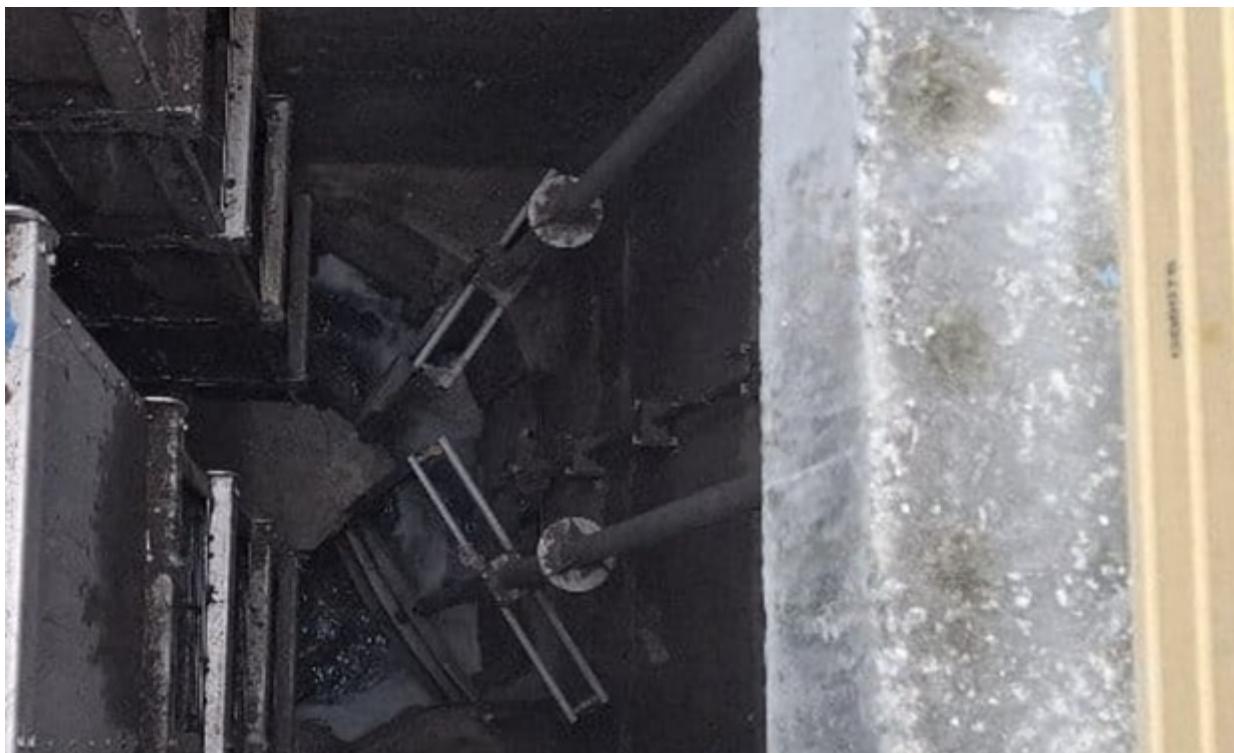
Foto 9 – Válvulas de fechamento na caixa receptora
