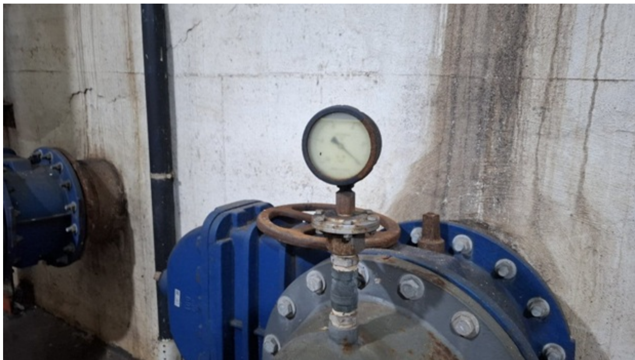
Foto 19 – Tubulação de sucção
