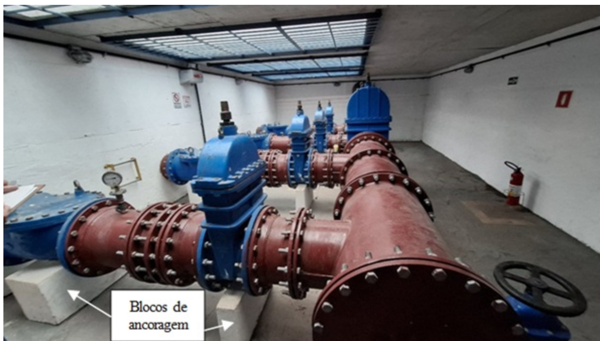
Foto 20 – Tubulação de recalque e barrilete
