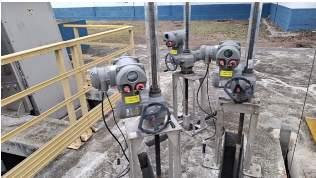
Foto 8 – Guarda corpo e válvulas de fechamento
