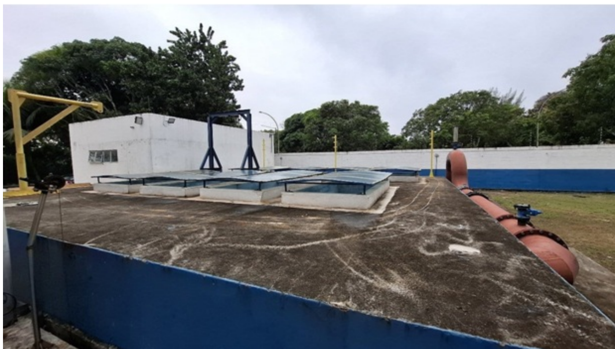
Foto 11 – Abrigo das motobombas
