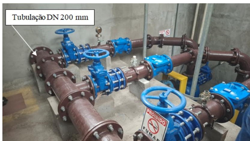
Foto 18 – Válvulas de fechamento e retenção
