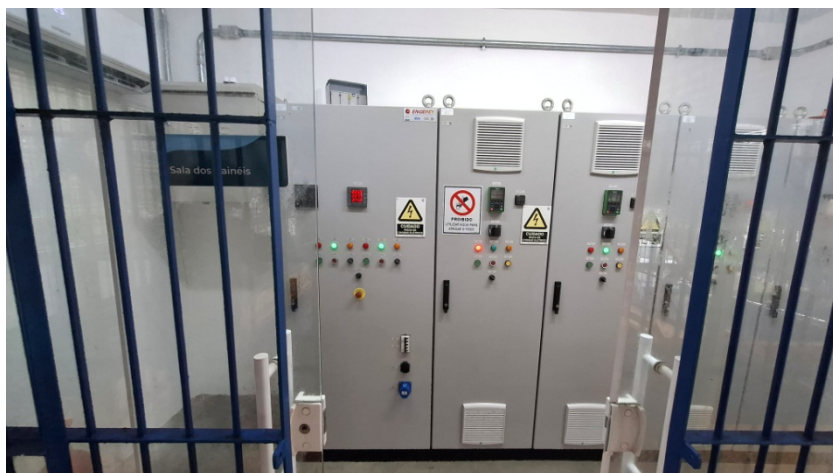
Foto 12 – Entrada da sala dos painéis da elevatória
