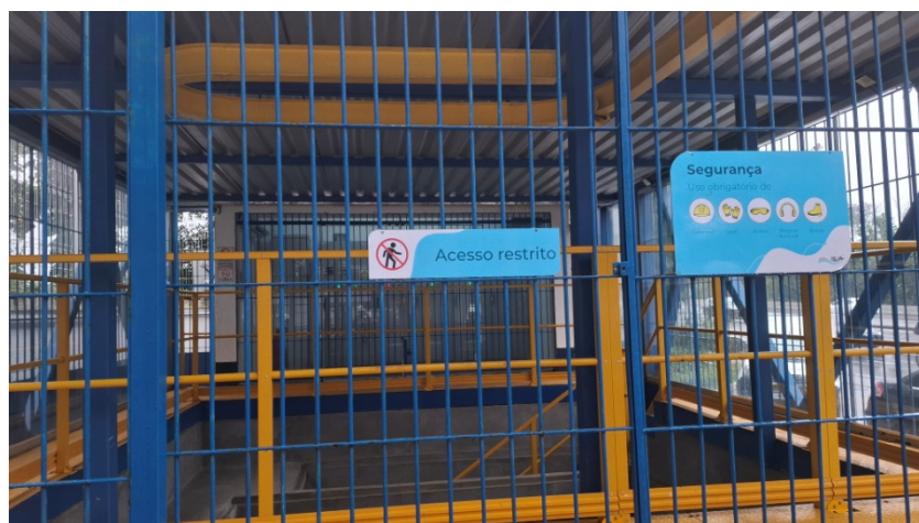
Foto 11 – Entrada do poço das motobombas e dos painéis da elevatória
