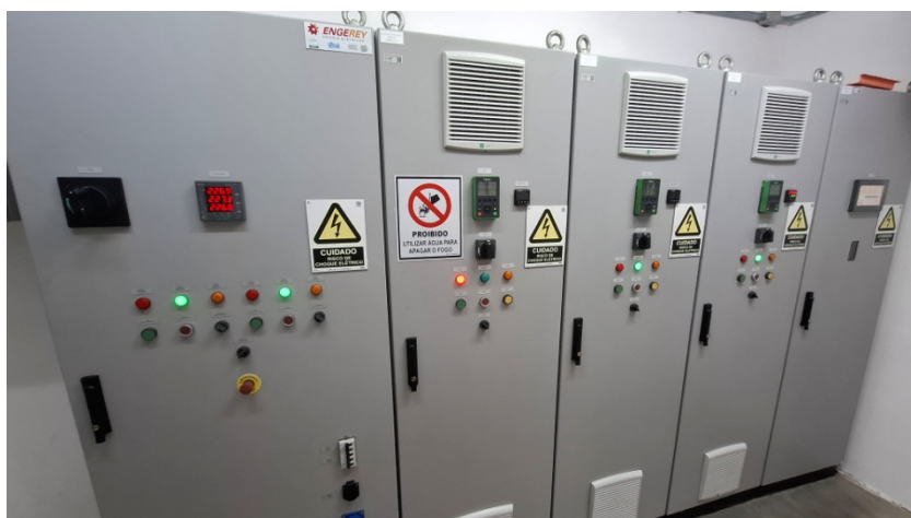
Foto 13 – Painéis elétricos da elevatória
