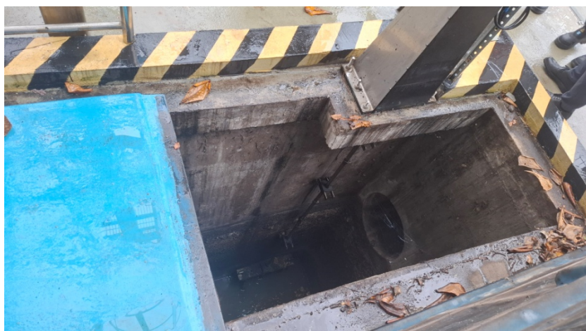
Foto 4 – Caixa receptora de esgoto
