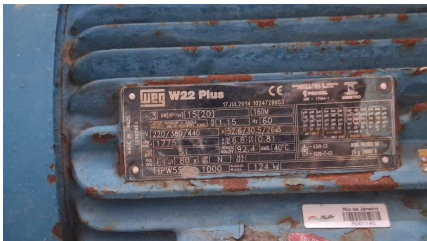
Foto 16 – Placa de identificação da motobomba
