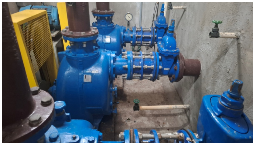
Foto 17 – Tubulações de sucção
