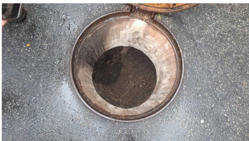
Foto 5 – PV que recebe o esgoto extravasado
