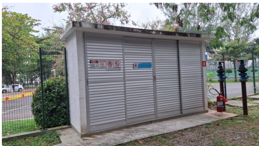
Foto 3 – Abrigo dos painéis de controle da elevatória
