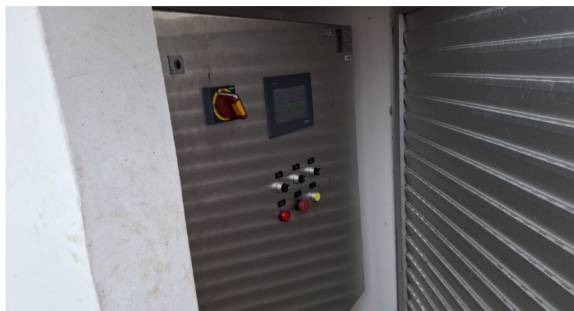
Foto 9 – Painel elétrico do gradeamento
