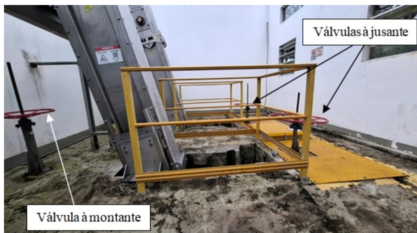
Foto 7 – Gradeamentos mecânicos e válvulas à montante e jusante
