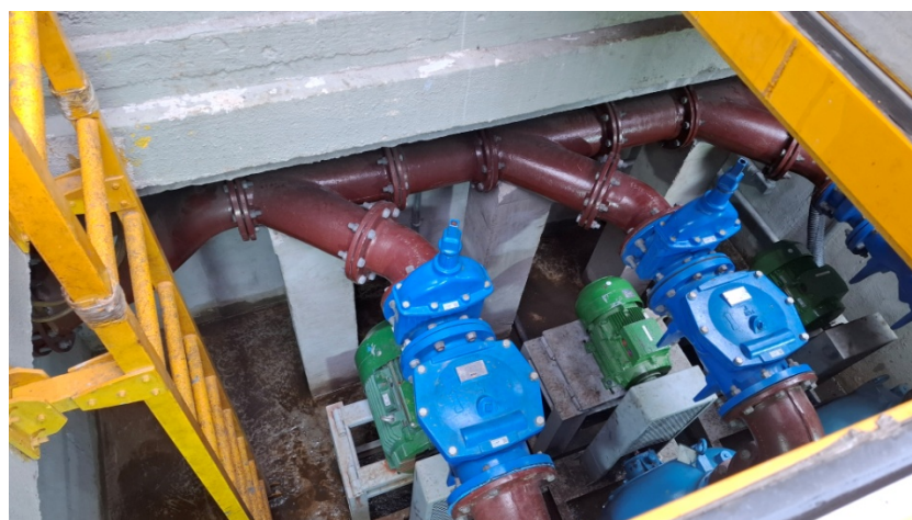
Foto 17 – Barrilete e tubulações de recalque
