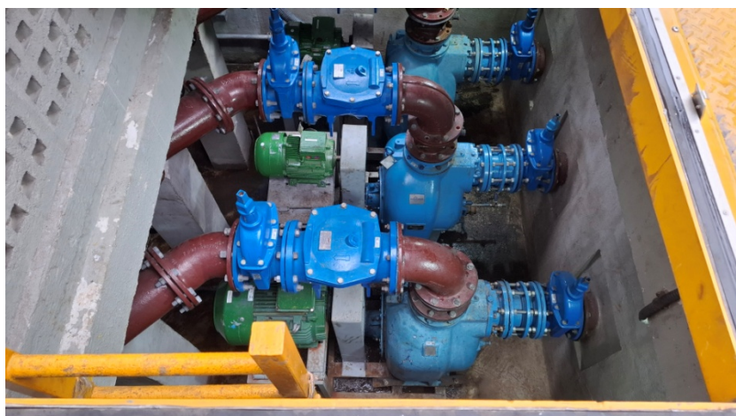
Foto 16 – Válvulas de fechamento e retenção
