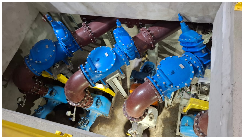
Foto 20 – Motobombas e válvulas
