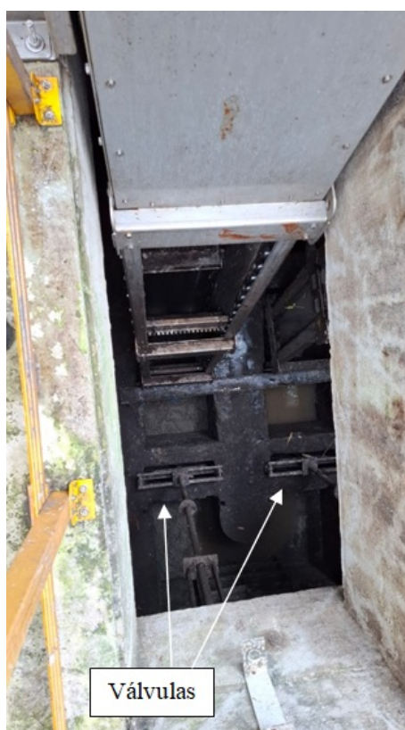
Foto 12 – Válvulas para fechamento à montante
