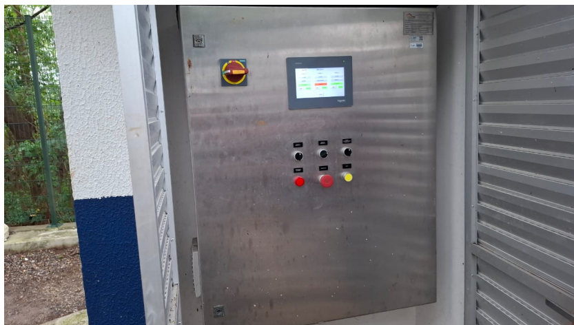
Foto 13 – Painelelétrico do gradeamento
