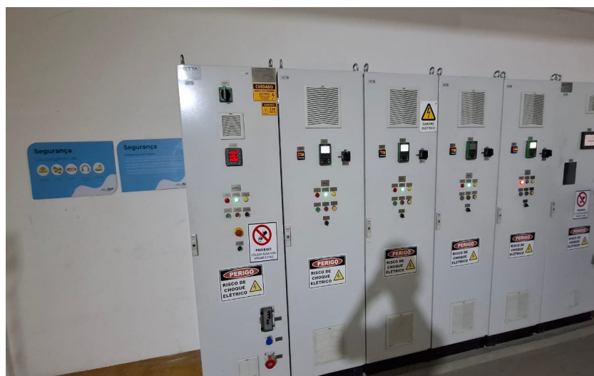
Foto 6 – Sinalização de risco de choque elétrico
