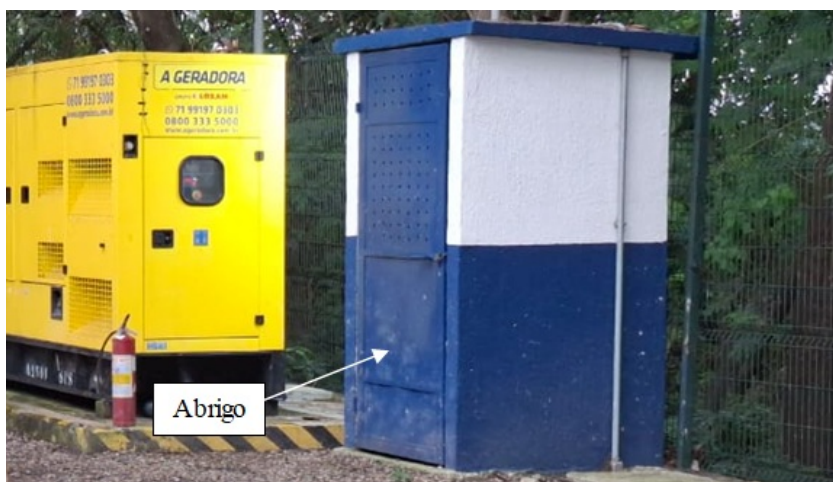
Foto 14 – Abrigo do painelelétrico do gradeamento
