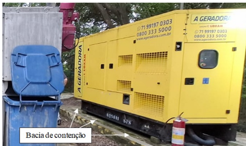
Foto 7 – Gerador e bacia de contenção
