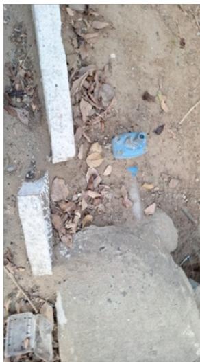
Foto 19 – Válvula de operação dos sistemas Porto das Barcas e Aperibé.
