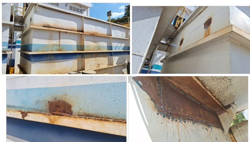
Fotos 7, 8, 9 e 10 – Reparos na estrutura do 1º módulo de tratamento que carecem de lixamento e pintura anti-corrosiva.
