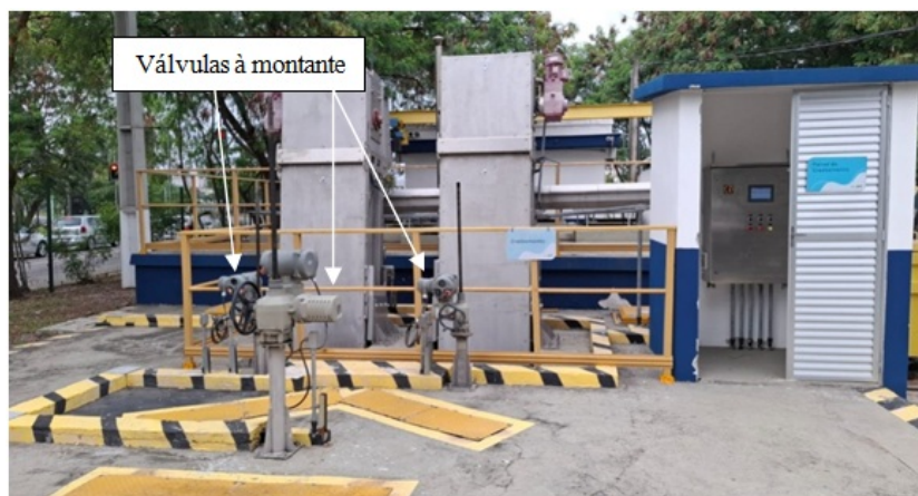
Foto 9 – Válvulas à montante e gradeamento mecânico
