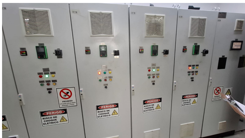
Foto 5 – Sinalização de risco de choque elétrico
