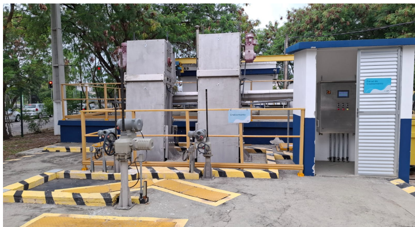
Foto 13 – Abrigo do painel elétrico
