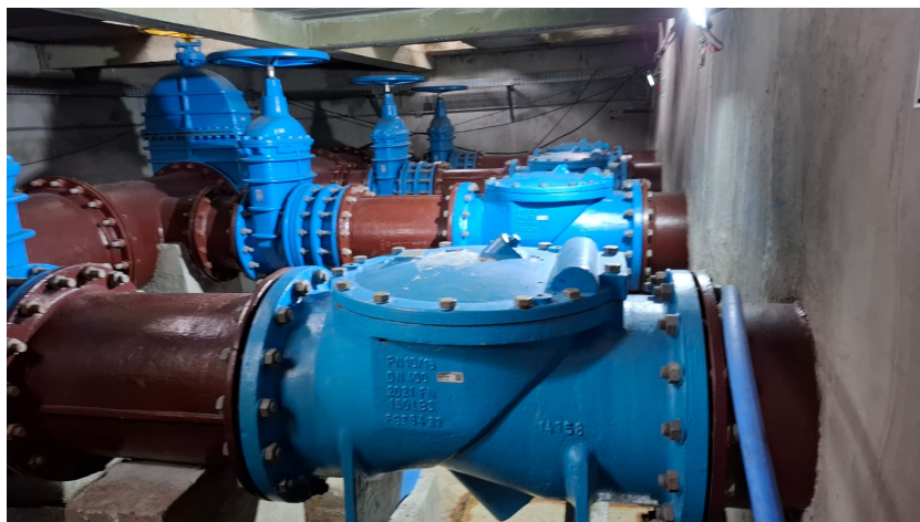
Foto 22 – Barrilete, tubulação de recalque, válvulas de fechamento e retenção
