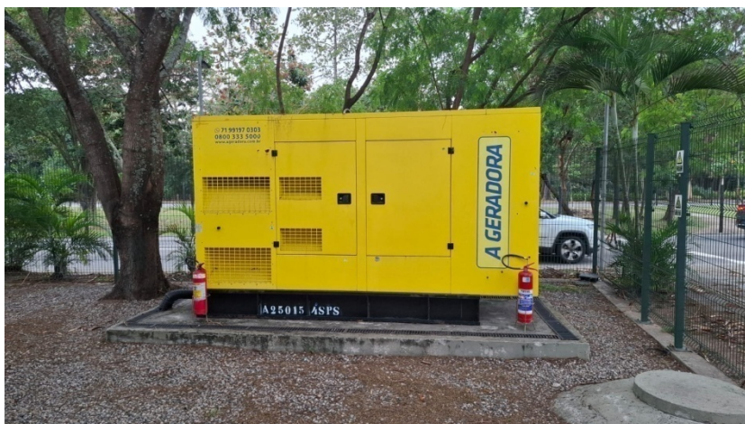
Foto 6 – Gerador e bacia de contenção
