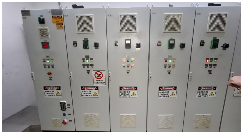
Foto 4 – Paineis elétricos das motobombas
