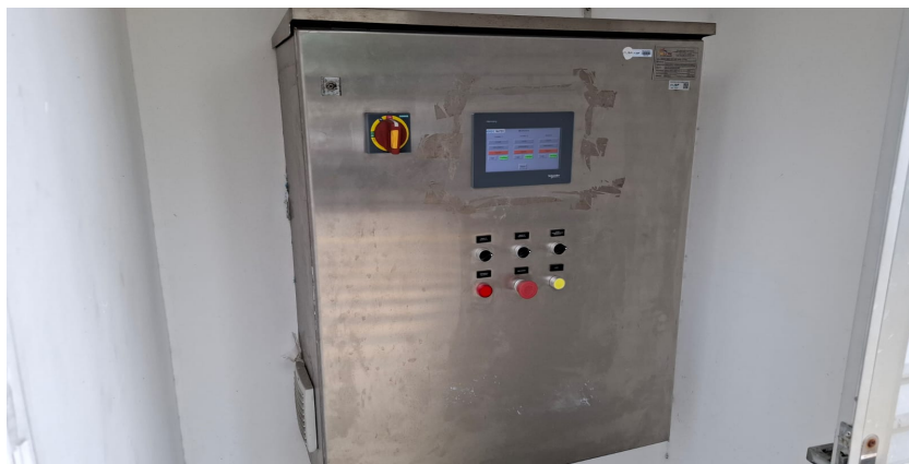
Foto 12 – Painel elétrico do gradeamento
