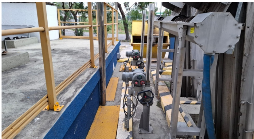
Foto 11 – Válvulas à jusante
