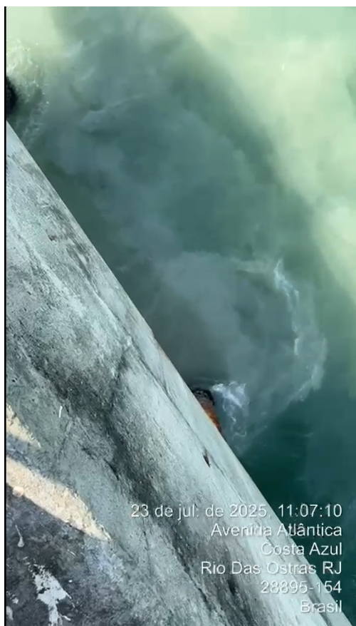
Foto 2 - Mancha do vazamento (intensificado para a inspeção)
