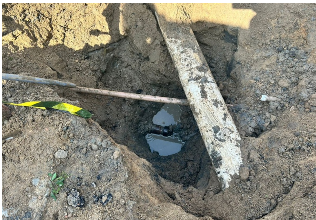
Foto 03 – Rede de distribuição encontrada em frente ao imóvel nº 490
