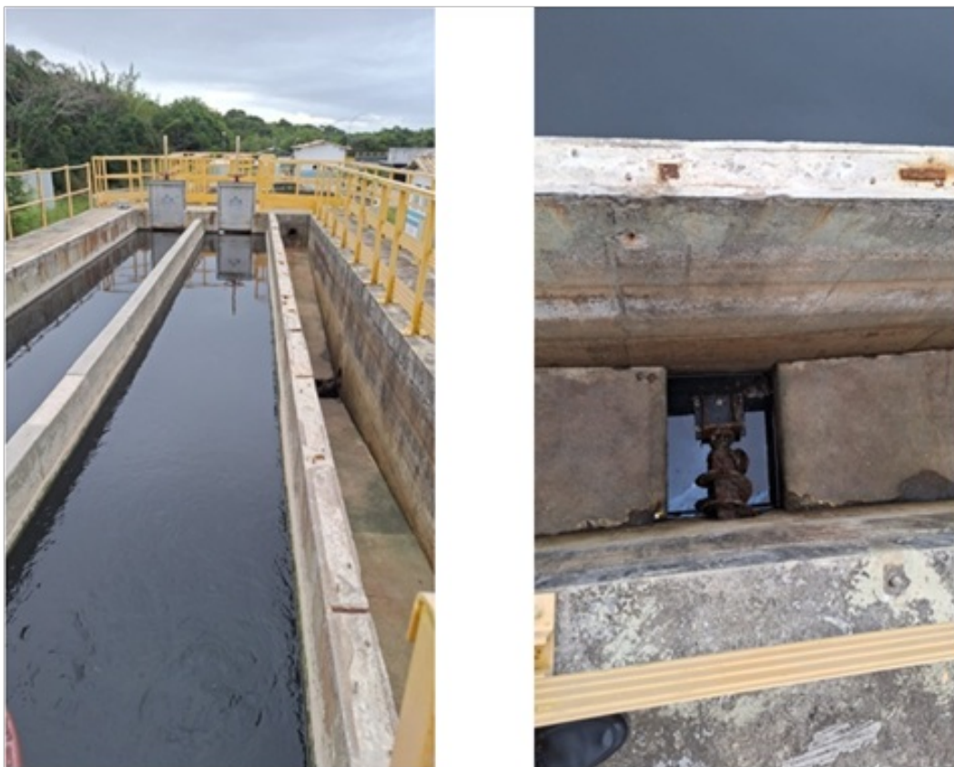
Foto 6 e 7 – Desarenador com duas câmaras para limpeza (descarga) com a ETE em operação; Descarga de areia.
