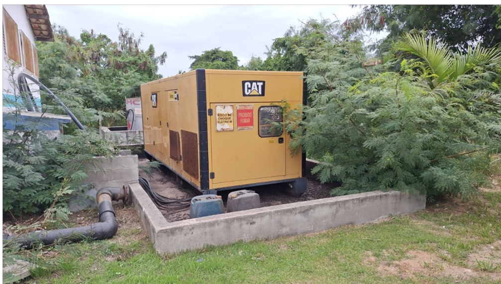
Foto 3 - Gerador com baia de contenção do reservatório de combustível (segurança operacional).
