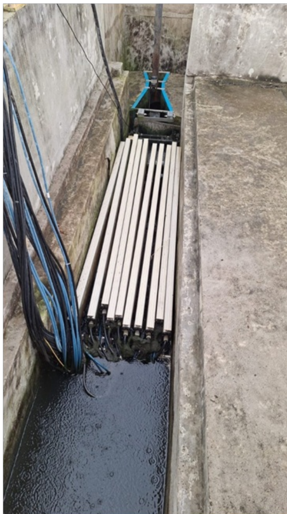
Foto 22 – Bateria de lâmpadas ultravioleta (desalinhadas) para suposta desinfecção. Medição em Calha Parshall, na sequência.
