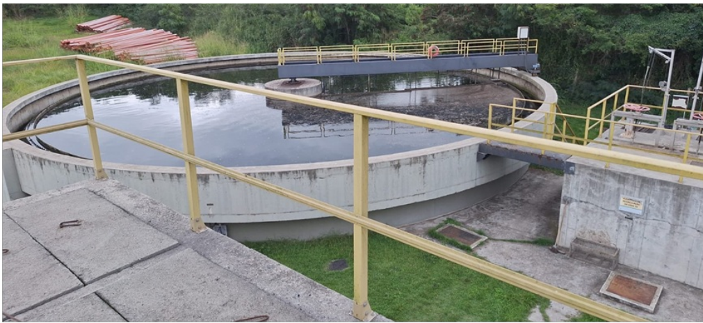
Foto 17 – Decantador Secundário ( são dois).
