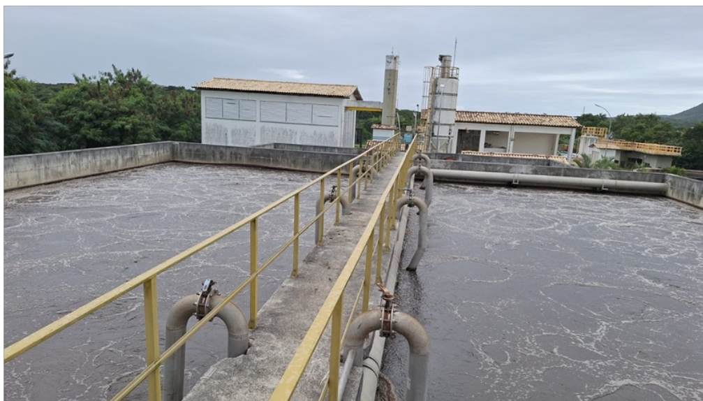
Foto 15 – Tanque de aeração com difusores submersos.
