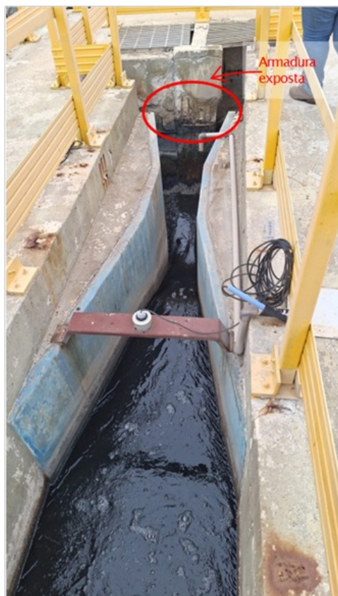
Foto 8 – Calha Parshall para medição dos esgotos afluentes, com sensor ultrassônico.
