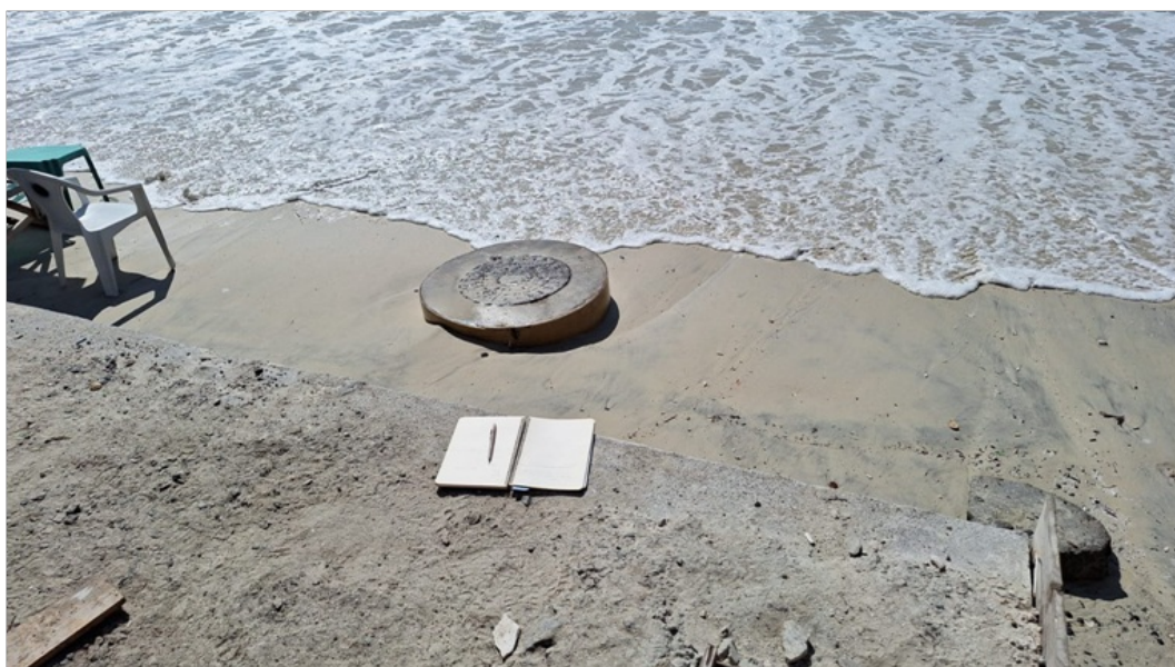
Foto 4 – Vista do PV quase encoberto ao meio dia, onde a maré ainda subirá até o final do dia.
