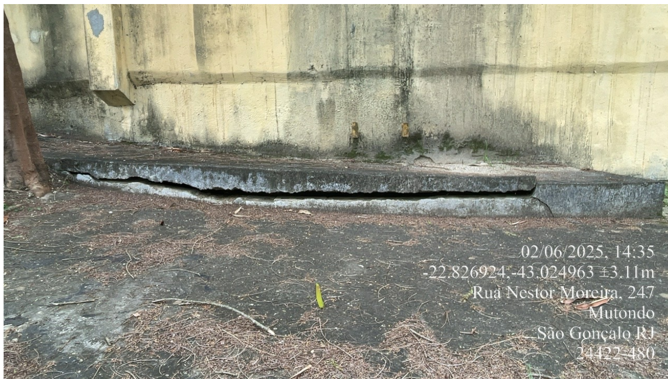
Foto 5 – Rachadura na base do reservatório
