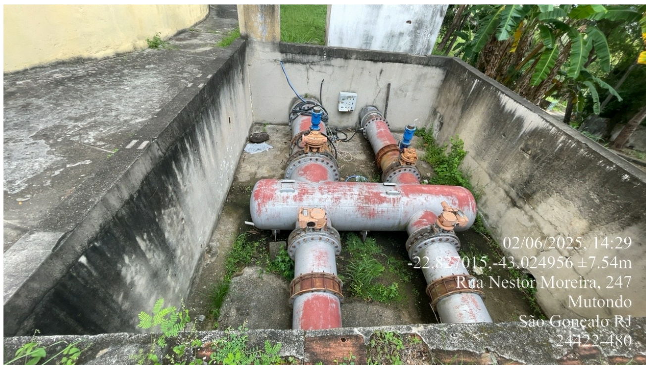
Foto 3 – Tubulação com válvula controladora de nível
