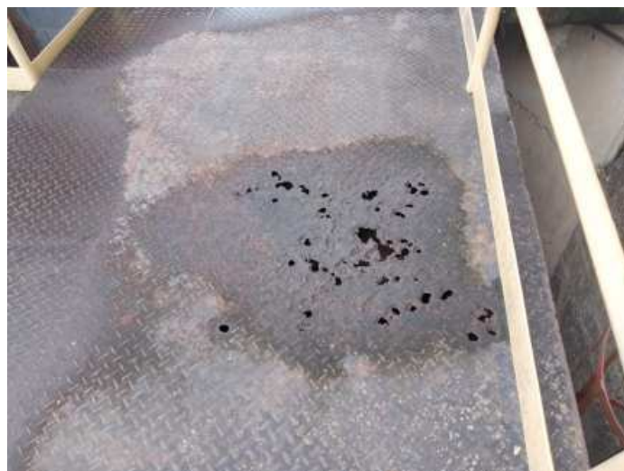
Foto 4 – Estrutura danificada (corrosão)
