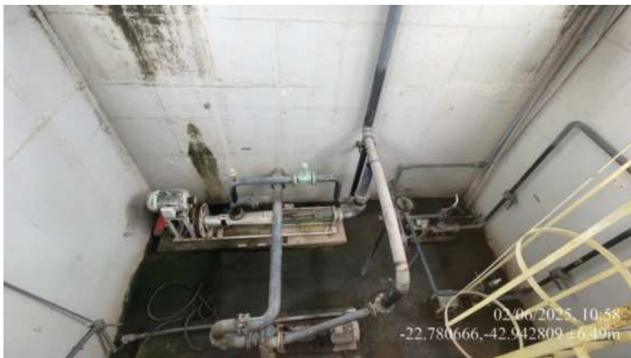
Foto 11 – Elevatória de retorno de lodo
