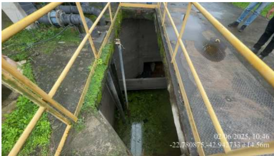
Foto 2 – Linha de recalque
