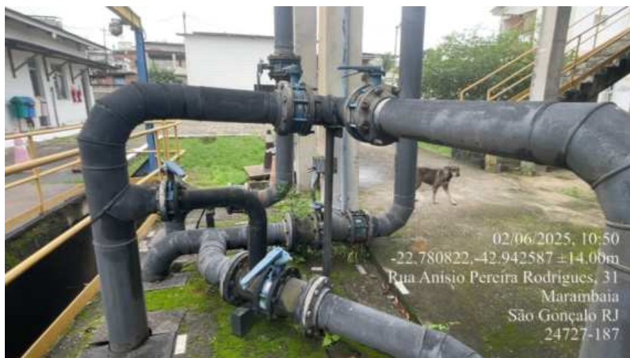
Foto 5 –Linha de recalque
