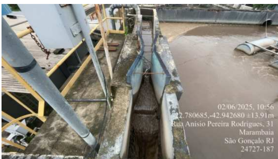
Foto 12 – Calha parshall retorno do lodo
