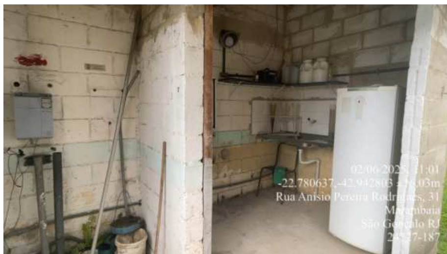
Foto 14 – Sala técnica de apoio
