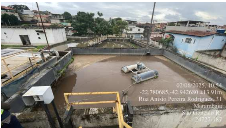
Foto 9 -Tanque de aeração
