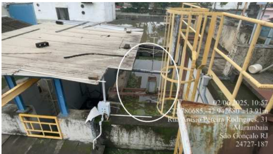
Foto 10 -Tanque de lodo
